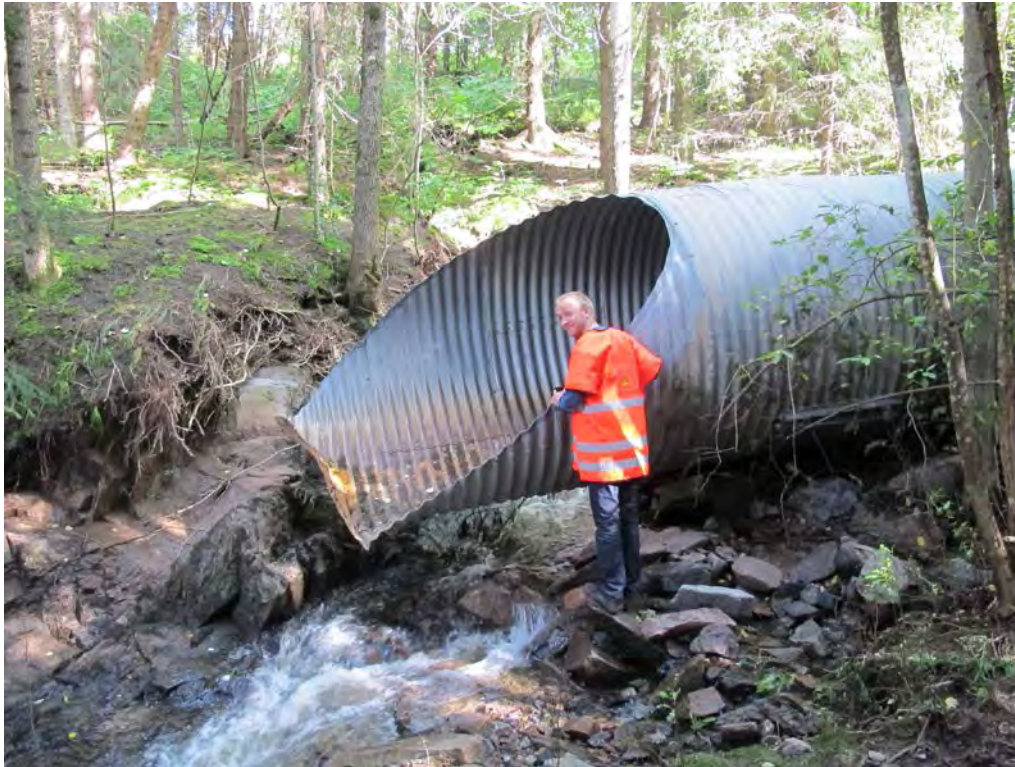
Foto: Kulvert på avveie etter lokal flom i Buskerud (20121806, Andreas Gjærum – SVV)
