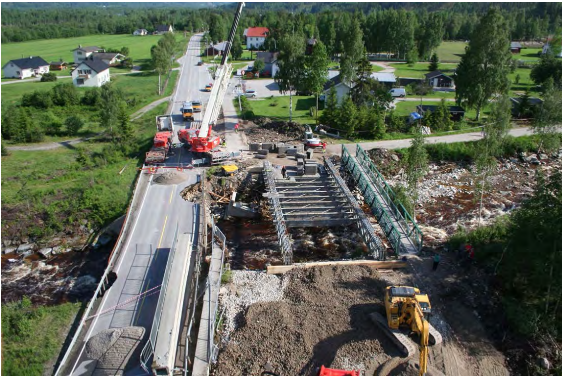
Foto: Trya bru på riksveg 3 etter pinseflommen i Østerdalen (2011 - SVV)
