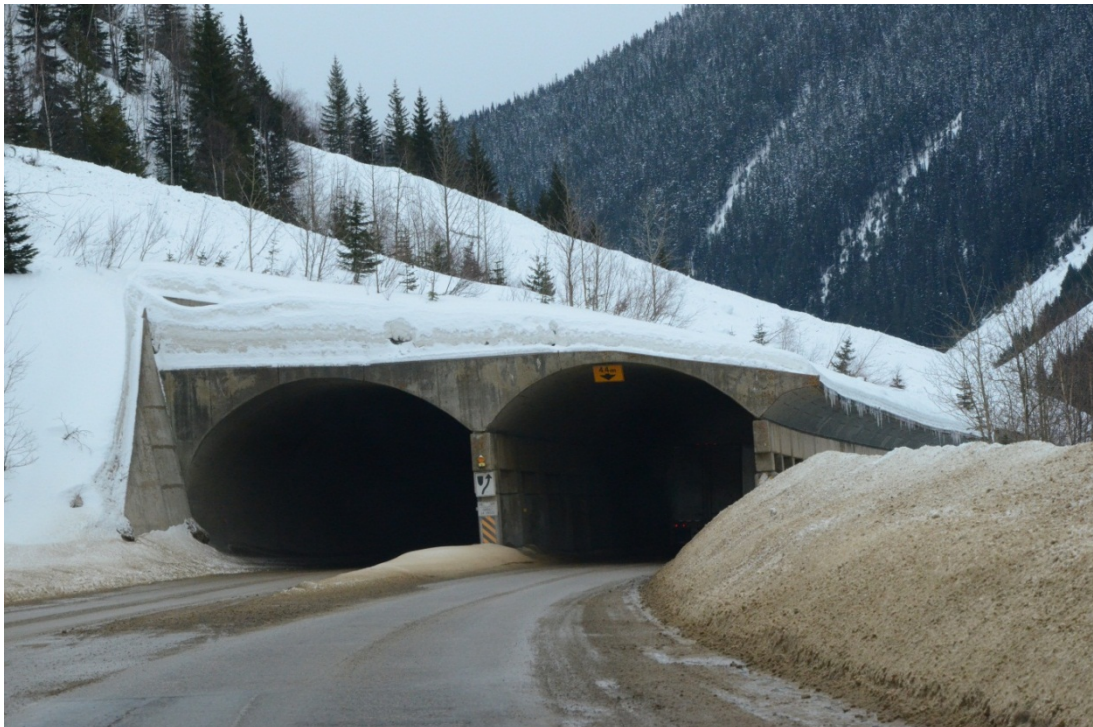
Figur 15 Utformingen er støttevegg med lett yttervegg der taket er utformet sirkulært. Videre har overbygget åpen yttervegg (Foto: Tore Humstad)
