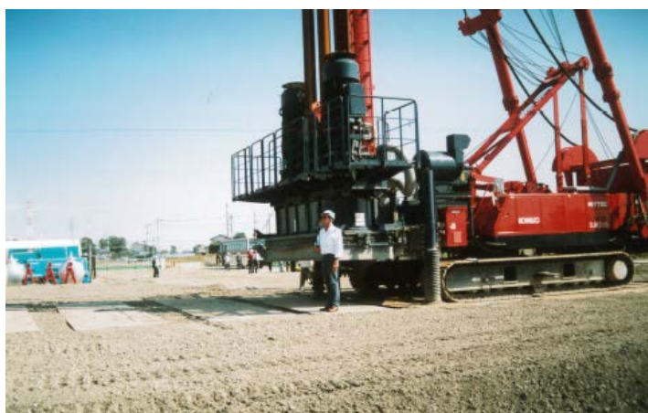
Figur 2.3: Viser Japansk utstyr for tørr metode fra byggeplass i utkanten av Tokyo. Maskinen har to visper. Foto NGI.
