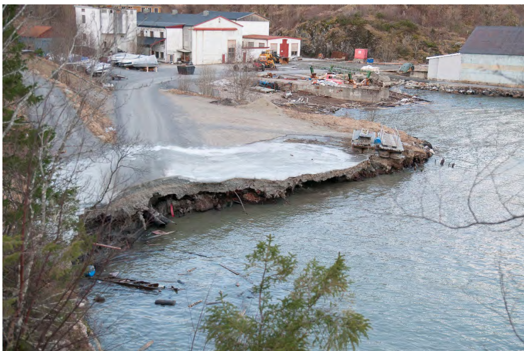
Figur 4: Skredkanten sett mot vest. Snekkeriet til høyre. I bruddkanten kan vanntilførselen til settefiskanelgget sees (ved rødt rør).
