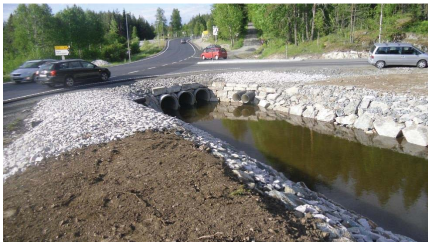
Figur 9 Massebassenget inn mot kulvertene under E134. Fungerer meget bra (Foto: Eirik Traae).
