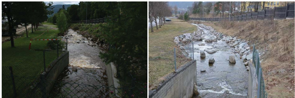
Figur 29 Utløp kulvert under Tinneveien før og etter erosjonssikring (Foto: Pål Buskum (v) og Eirik Traae(h)).
