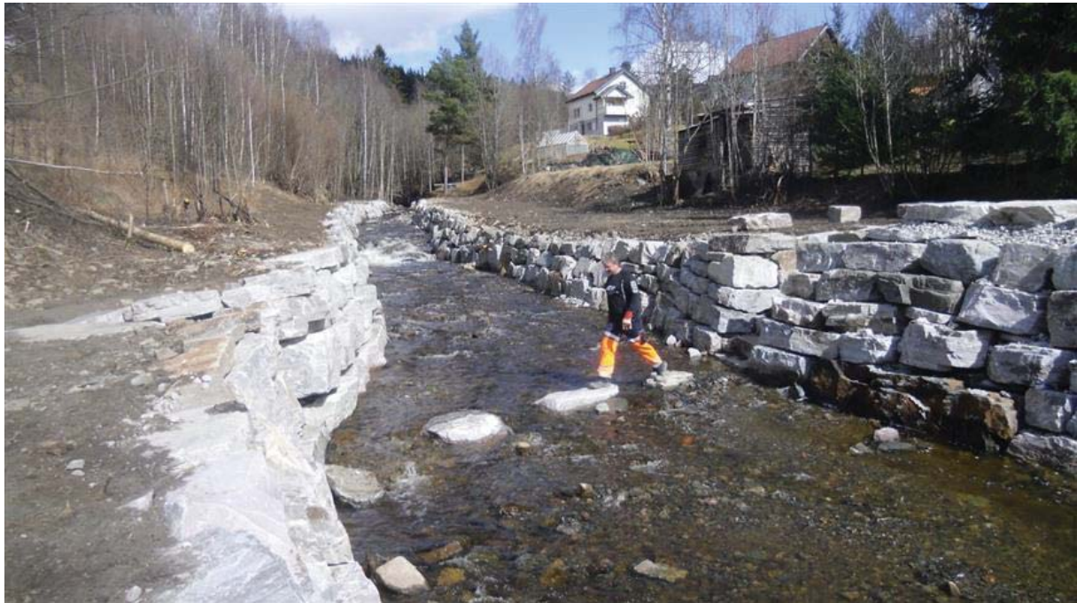
Figur 24 Viser erosjonssikring øverst i Høybødalen like før innløpet til kanalen (Foto: Notodden kommune).
