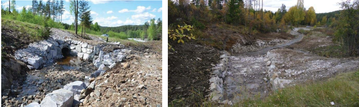
Figur 7 Venstre: Viser innløp til ombygget kulvert under Høgåsveien. Høgre: Erosjonssikret utløp fra kulvert under Høgåsvegen og ned mot E134 (Foto begge: Eirik Traae).
