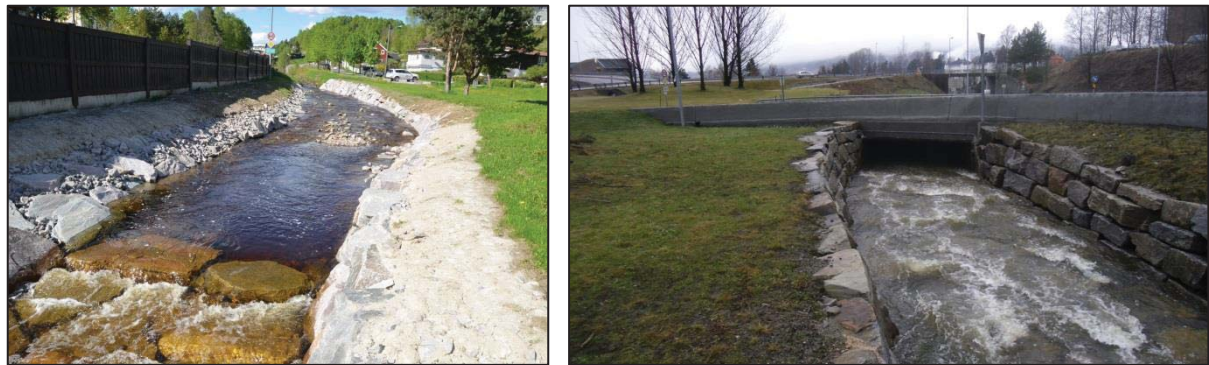
Figur 38 Venstre: Masseavlagringsbassenget like oppstrøms for Sauheradvegen. Høgre: Ombygget innløp til kulvert under Sauheradvegen. Autovernet er byttet ut med betongkant for å kunne sette på mer vanntrykk (Foto begge: Eirik Traae).
