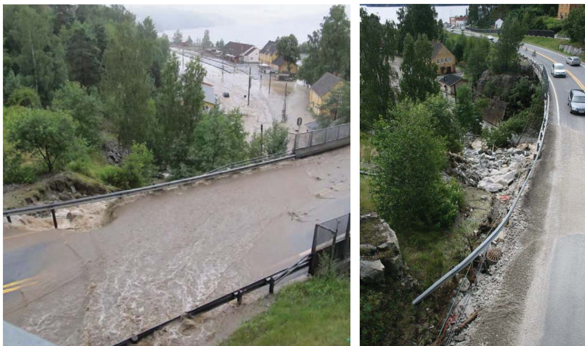
Figur 34: Venstre: Avrenning mot jernbanen fra E134 (Kongsbergvegen) (Haddeland, 2011). Høyre: Samme sted 27. juli 2011 (Foto: Pål Buskum).
