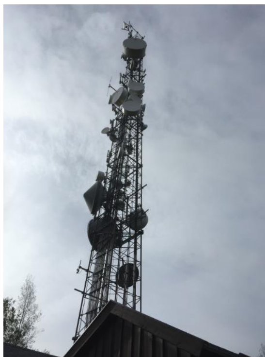
Figur 29. Kommunikasjonsmast på Bergstoppen ved Gjøvik. Foto: Lars Hagvaag Seim.
