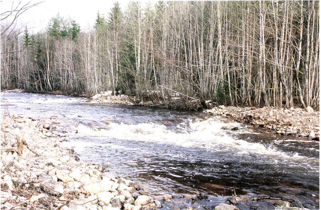
Biotoptiltak i Letjenna i april 1989. Steiner er lagt ut for å lage et strykparti. Nedenfor stryket dannet det seg etter hvert en kulp (foto: Jon Arne Eie).
