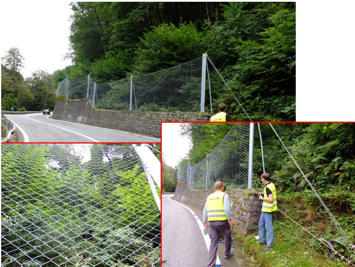
Figur 40. Fanggjerdet på 100 kJ med Tecco - sikringsnett (Foto: Gunne Håland)
