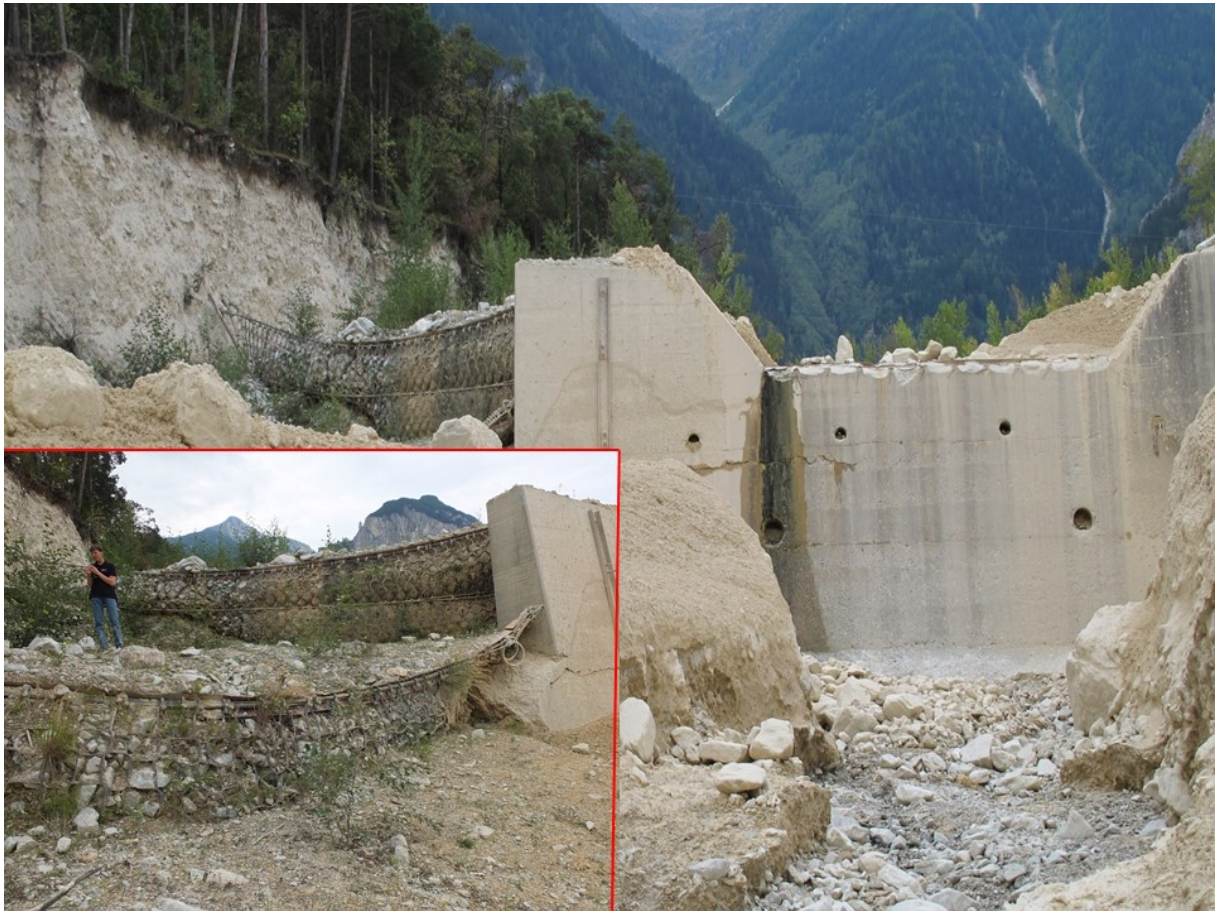
Figur 63. Her har skredløpet blitt sikret med en åpen kontrolldam i betong og to fleksible flomskredgjerder. Gjerdene har hatt god sikringseffekt mot flomskred (Foto: Gunne Håland og Audun Langelid)
