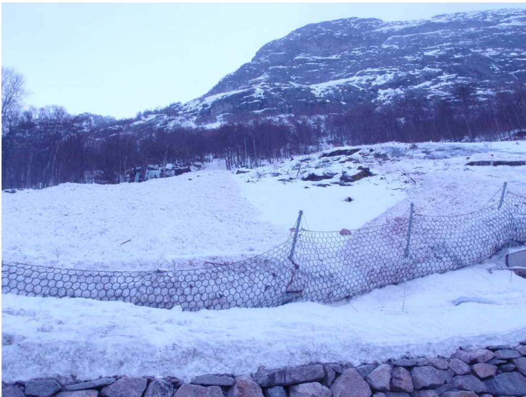
Figur 84. Skredmasser har fylt opp gjerdet fra to forskjellige skredløp. Terrenget over består av bratt svaberg (Foto: Kristian Kjesbu)
