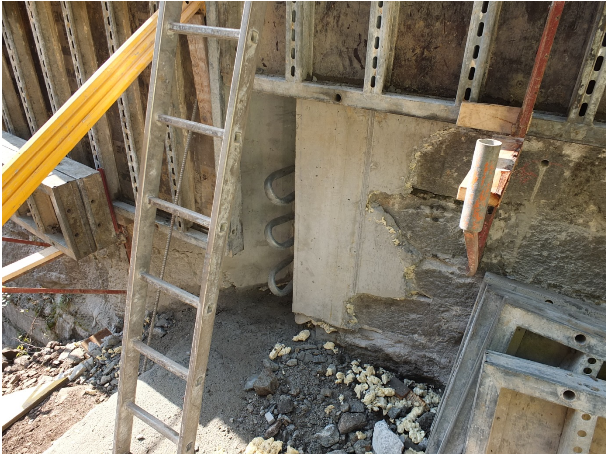
Figur 45. Veggene i betongdammen er 5 meter tykke. Det er brukt staganker som forankringsmetode med en ankerdybde på 6 meter for innfestingen til fanggjerdet (Foto: Gunne Håland)
