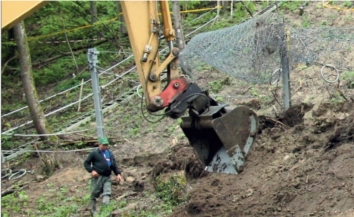
Figur 30. Et eksempel på hvordan man kan fjerne massene fra nedsiden på et fleksibelt fanggjerde mot jordskred (Foto: Geobrudd)
