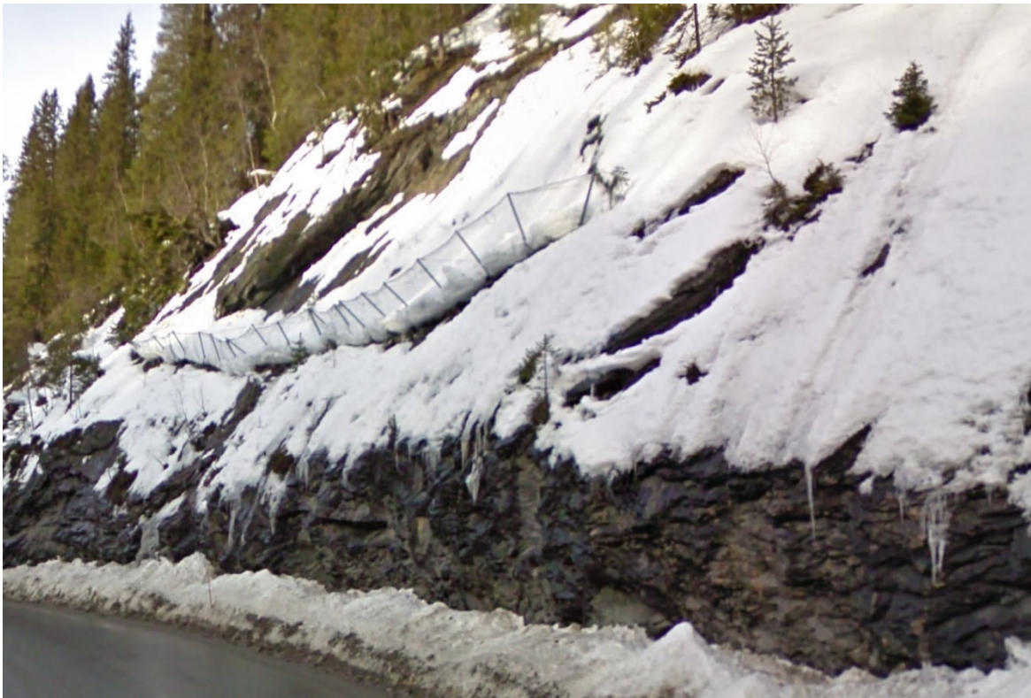
Figur 85. Snøsigproblemer over vegskjæring ved Svølgja i Sør-Trøndelag (Foto: Google street, 2010)
