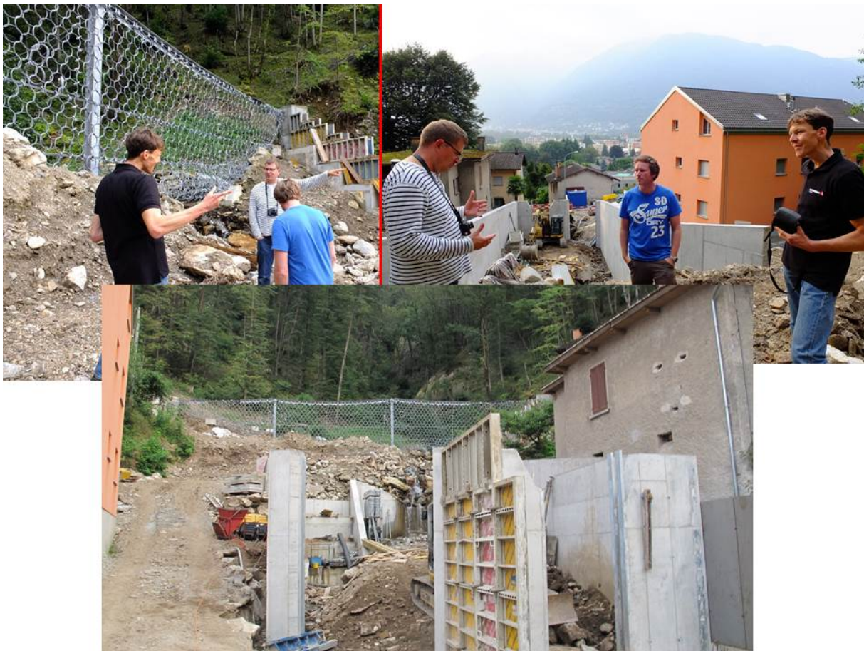
Figur 37. Lokalitet ved Jaubiajco. Her skal noen hus i en landsby sikres med et fleksibelt ringnett barriere kombinert med en fangdam, ledevoll og energidreper i betong (Foto: Gunne Håland og Audun Langelid)
