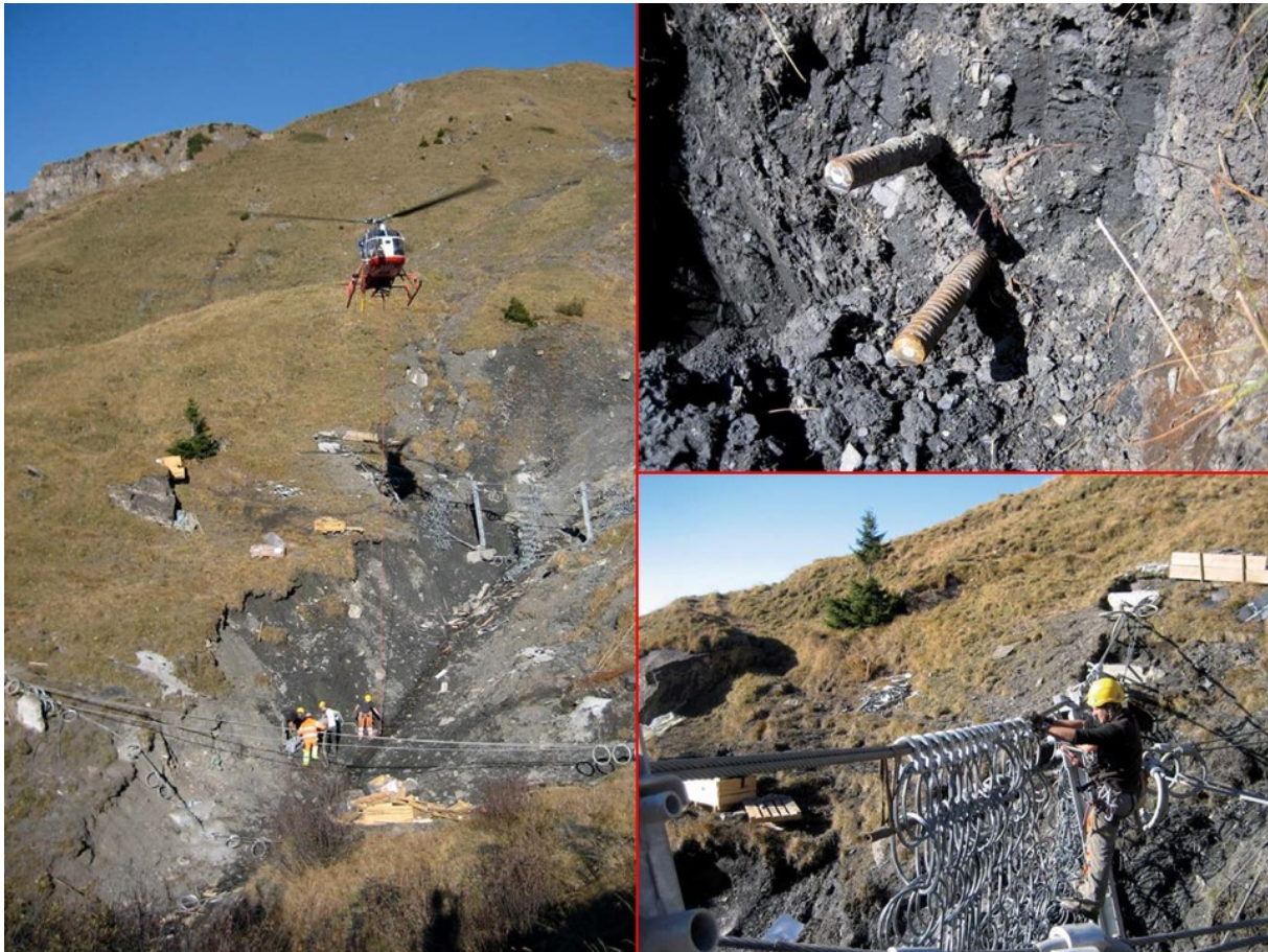
Figur 77. Installering av gjerdene i 2007/2008. Gjerdene ble fraktet opp med helikopter. Bilde øpe t.h viser anker i kanalveggen, og bilde nede t.h viser festingen av ringnettene (Foto: Geobrugg)
