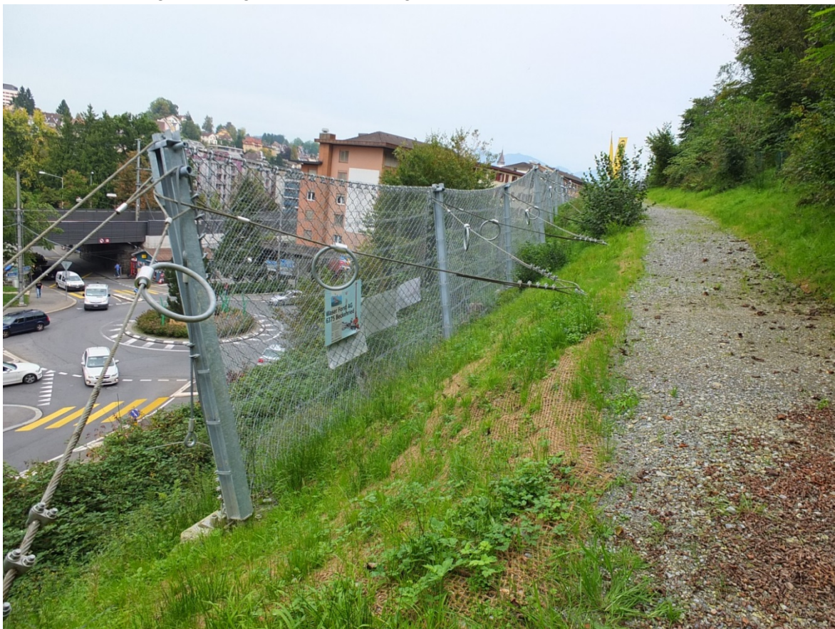
Figur 78. Det er satt opp et fleksibelt fanggjerde for å sikre en rundkjøring og noen bygninger mot jordskred (Foto: Gunne Håland)
