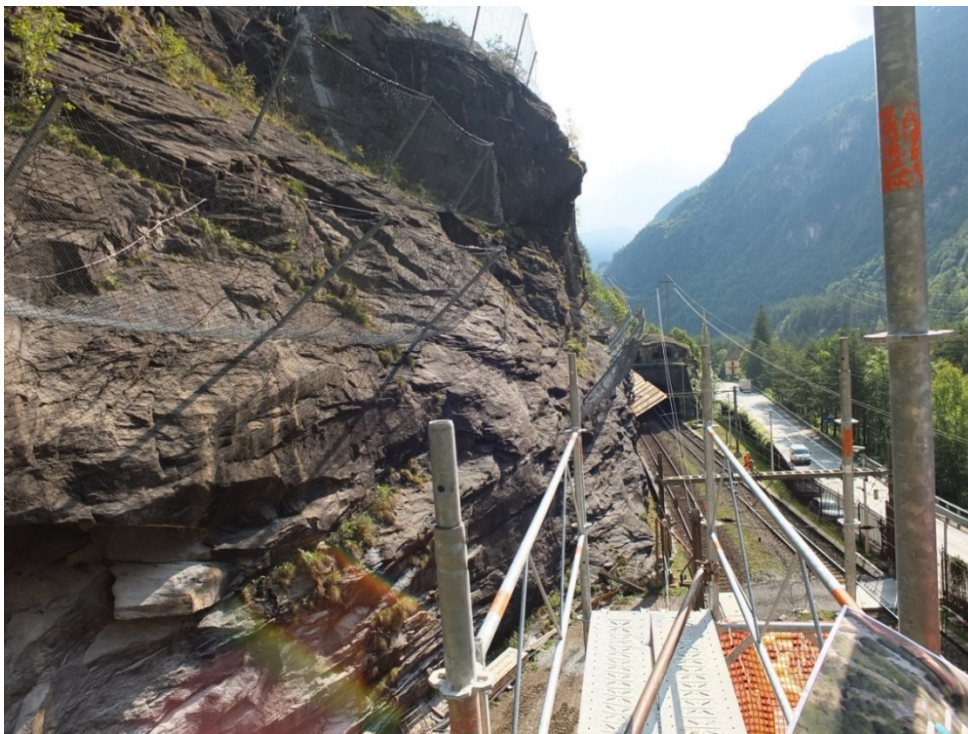
Figur 43. Det er installert flere ulike typer fanggjerder mot steinsprang i den bratte fjellskrenten over jernbanestasjonen (Foto: Gunne Håland)
