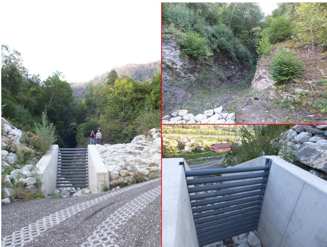
Figur 58. t. v: Det øverste bassenget har som formål å stoppe de groveste massene i flomskredet. Bilde oppe t. h viser kanalen i bakkant som skredet dreneres gjennom. Bilde nede t. h viser energibaren der jernrør er satt på skinner (Foto: Gunne Håland og Audun Langelid)
