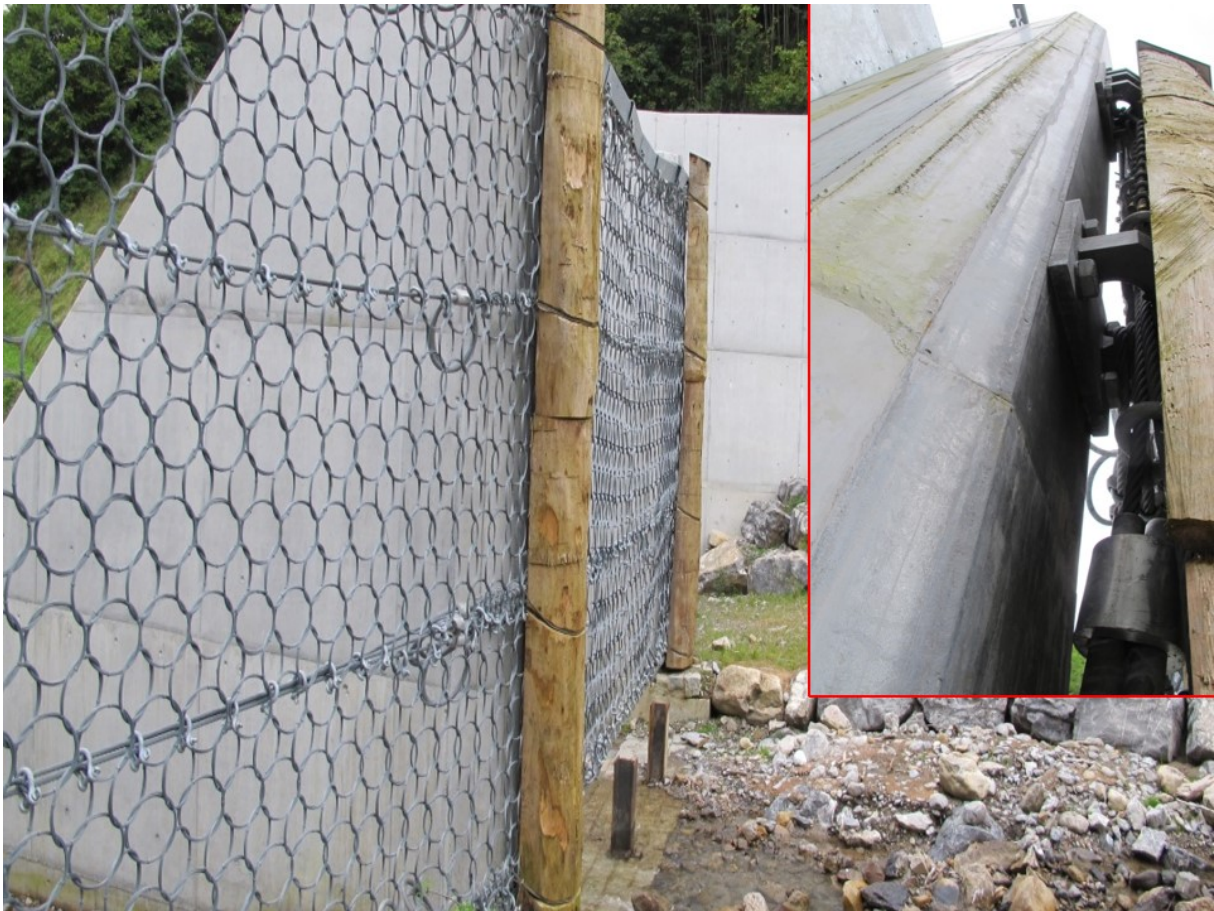
Figur 73. Tømmerstokkene beskytter betongkonstruksjonene mot skredmassene (Foto: Audun Langelid)
