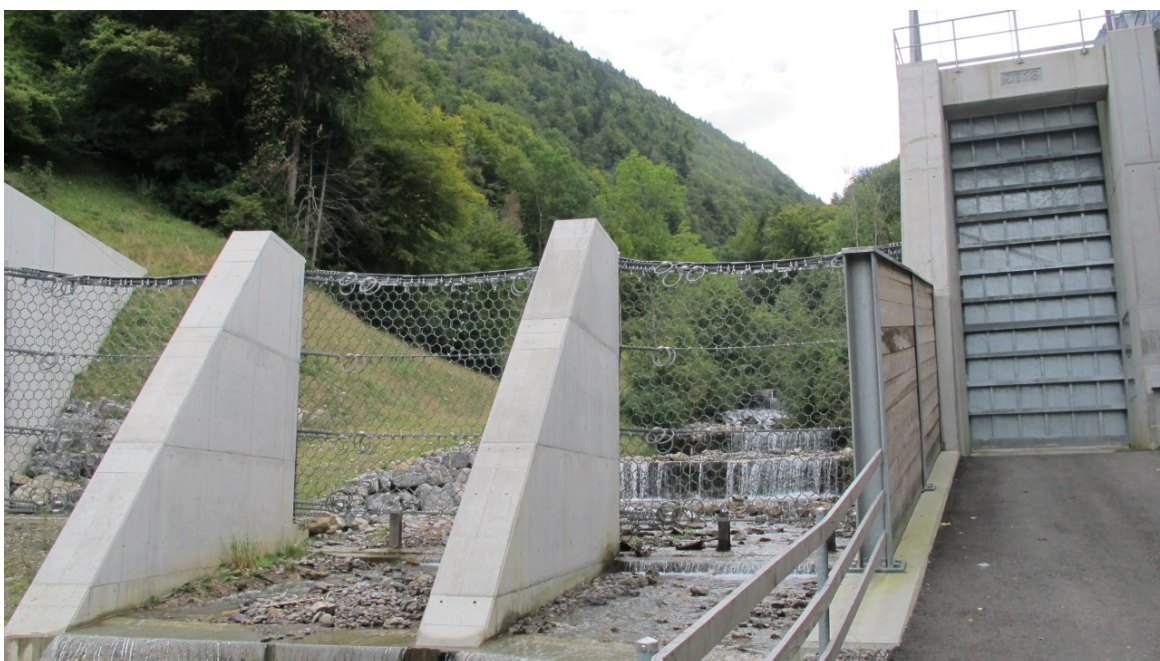
Figur 72. Bilde av konstruksjonen sett nedstrøms. Legg merke til bilporten til høyre i bilde (Foto: Audun Langelid)
