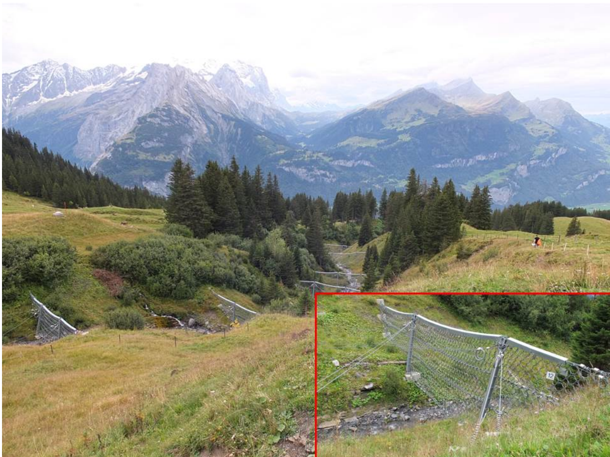
Figur 74. Det er satt opp 13 fleksible ringnett - gjerder øverst i en elv for å hindre at det utvikler seg flomskred (Foto: Gunne Håland og Audun Langelid)
