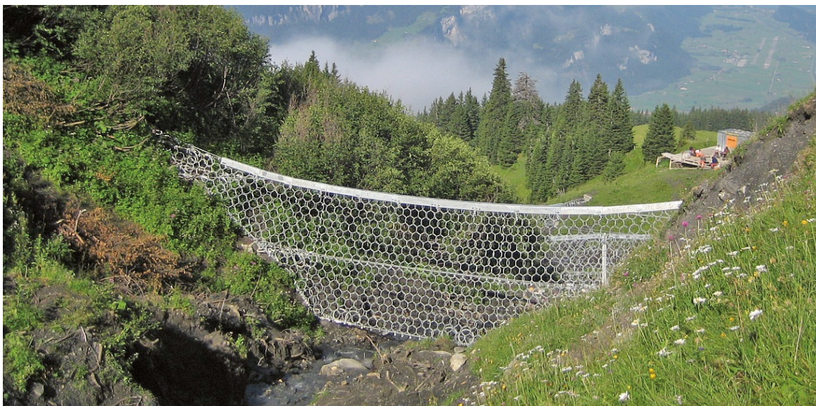
Figur 13. Et eksempel på et fleksibelt ringnett-gjerde som er installert i en smal V-formet kanal (Foto: Geobrugg)
