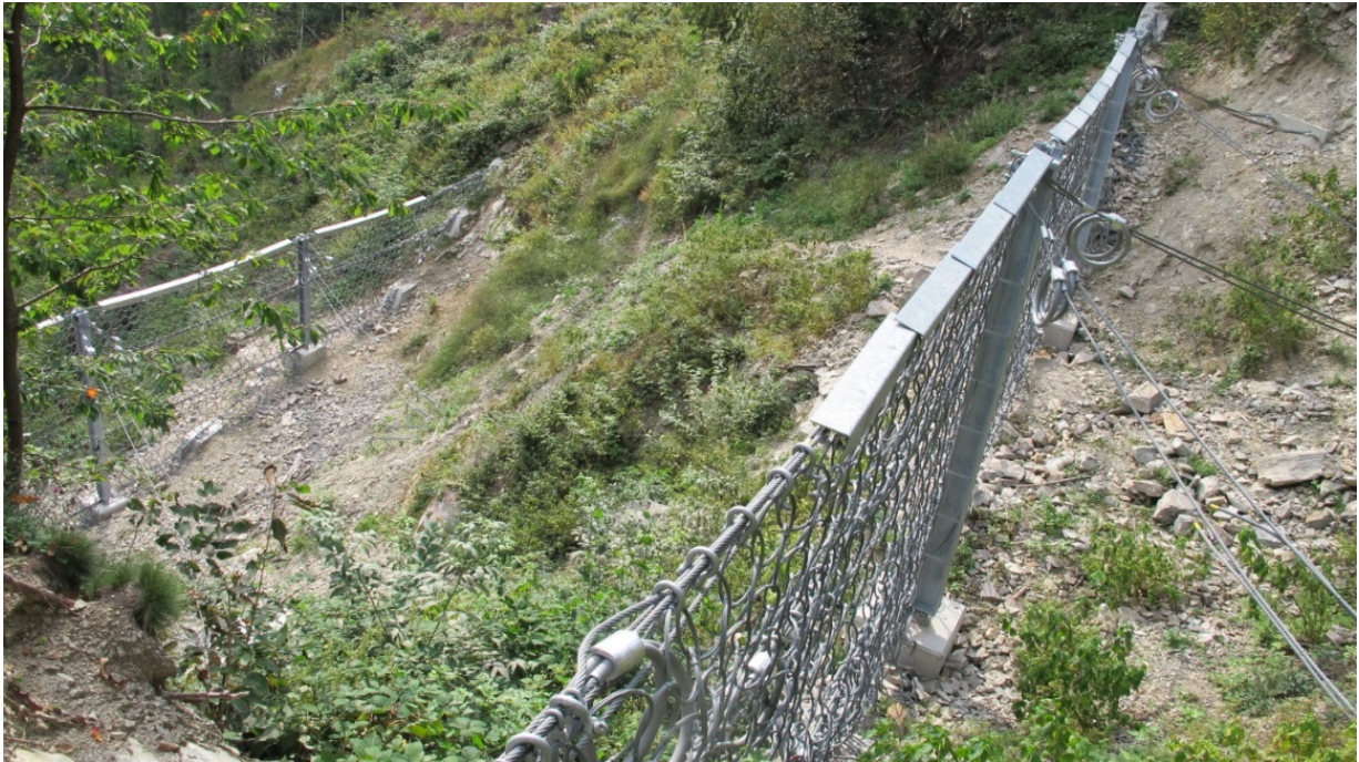
Figur 32. Trafostasjonen til jernbanen blir sikret med to fleksible ringnett- gjerder i kanalen. Det fremste gjerdet (til venstre i bildet) har en høyde på 6 meter og er det høyeste av denne typen i Sveits. Det bakerste gjerdet er på 5 meter (Foto: Audun Langelid).
