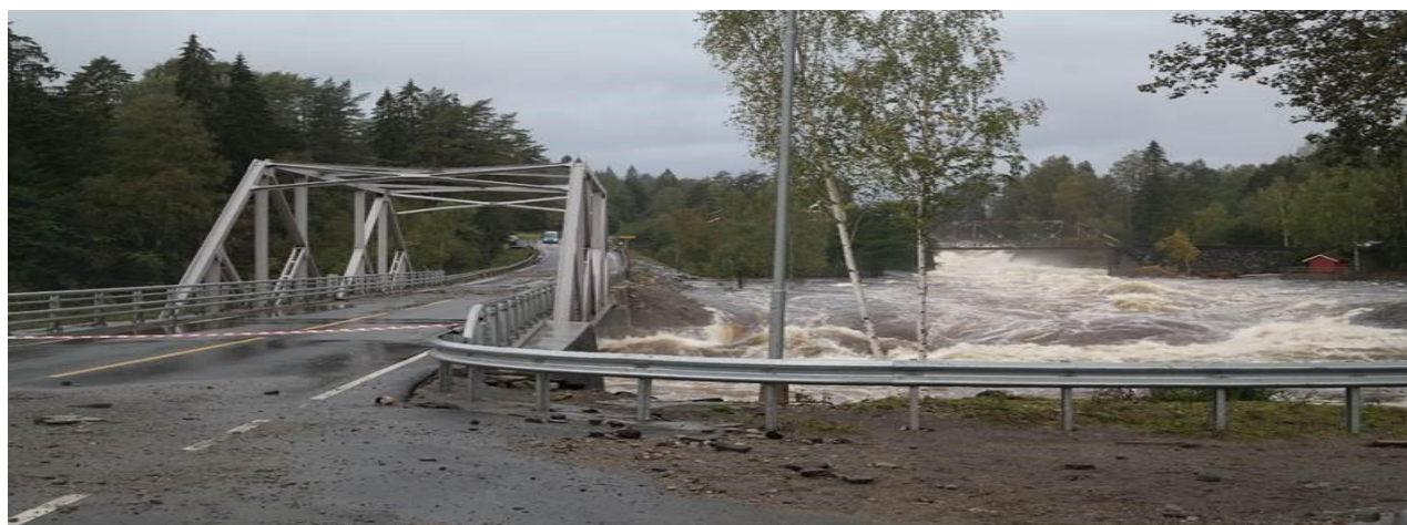
Flom ved E134 Landsverk bru i Sauland kommune, Telemark (20150915, Bjørn K. Dolva)
