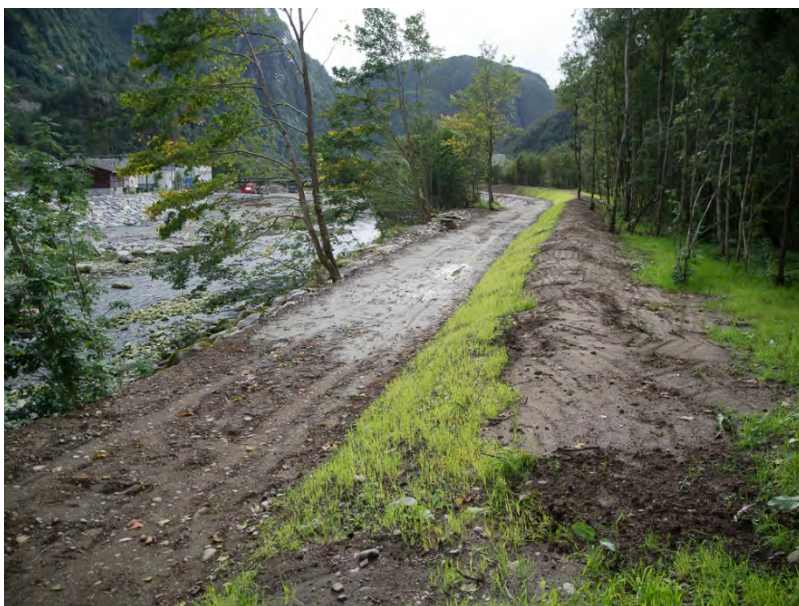
Figur 15 Parti av ferdig anlegg i Bergsdalselva i Dale i Vaksdal, september 2013 (Foto: Jomar Bergheim, NVE).
