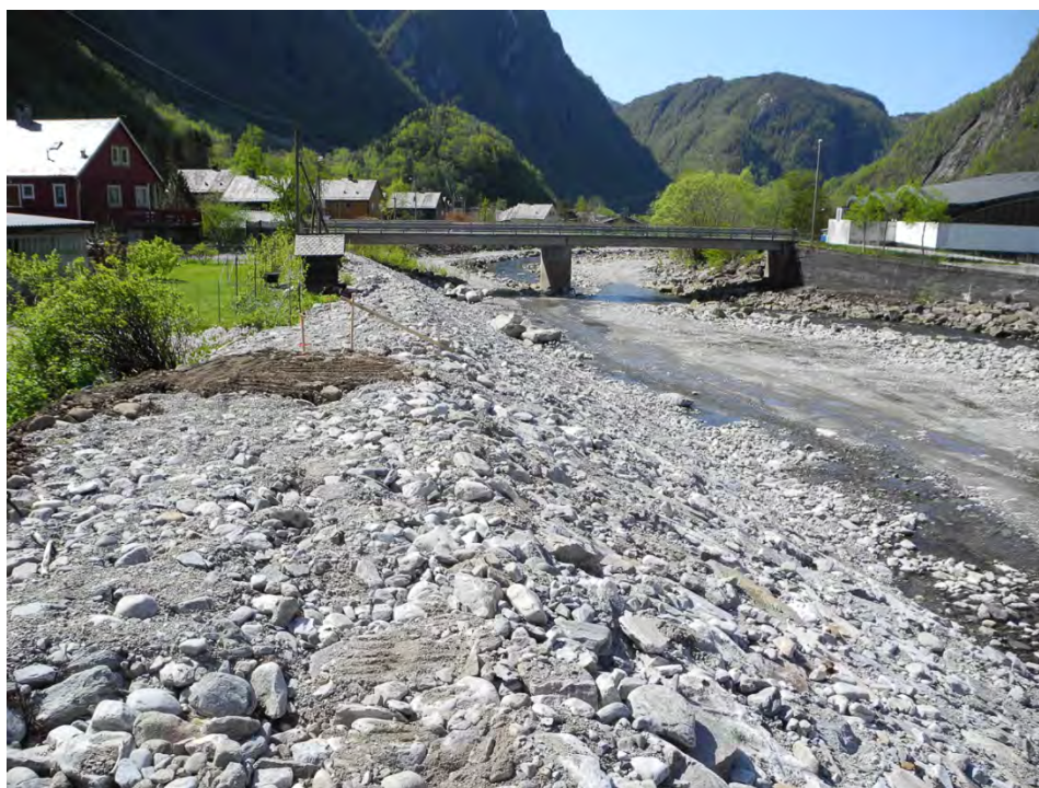
Figur 11 Etter utgraving av masse og etablering av plastring mai 2012 (Foto: Jomar Bergheim, NVE).
