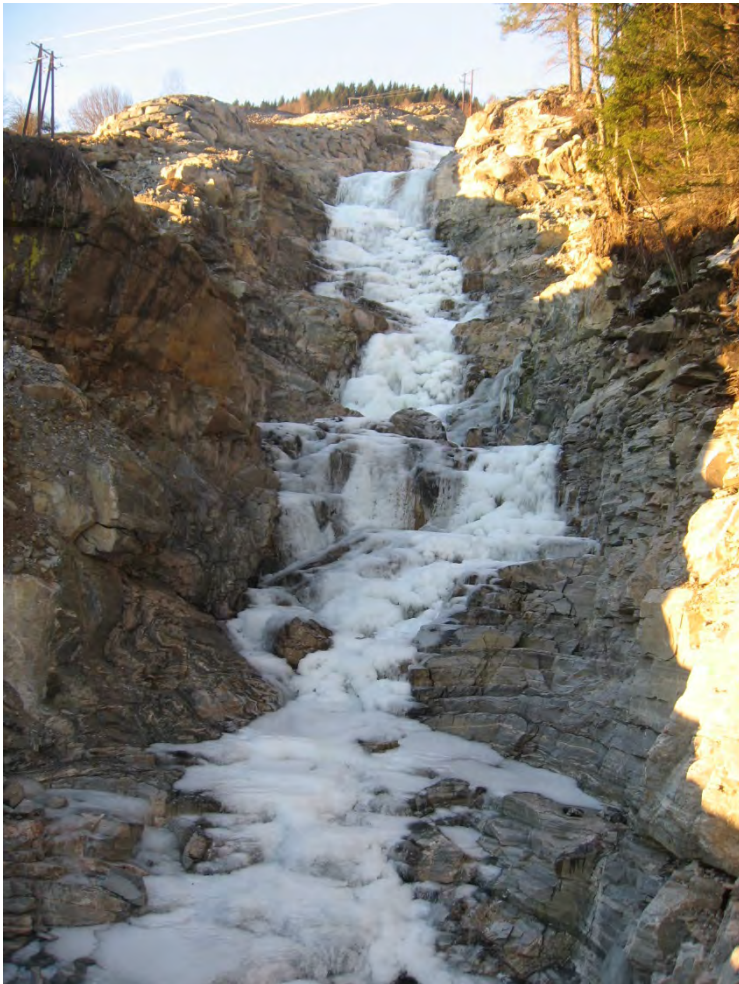
Figur 36 Ferdig utsprengt elveløp. Nedre del sett opp mot øvste busetnaden (Foto: NVE).
