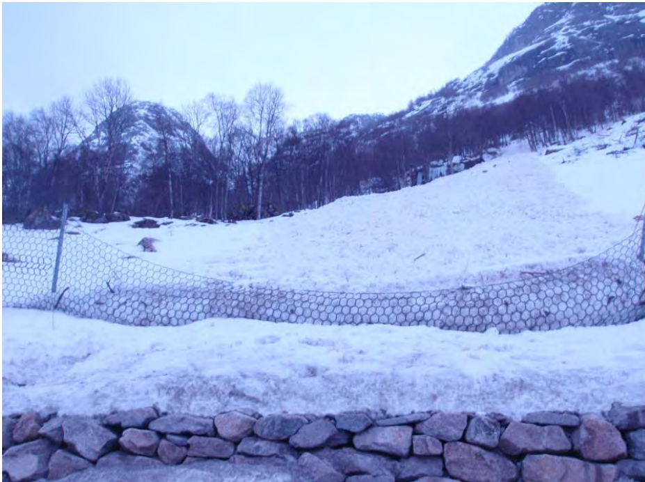
Figur 27 Skredmasser har fylt opp og knekt 2 stolper i gjerdet (Foto: Kristian Kjesbu).
