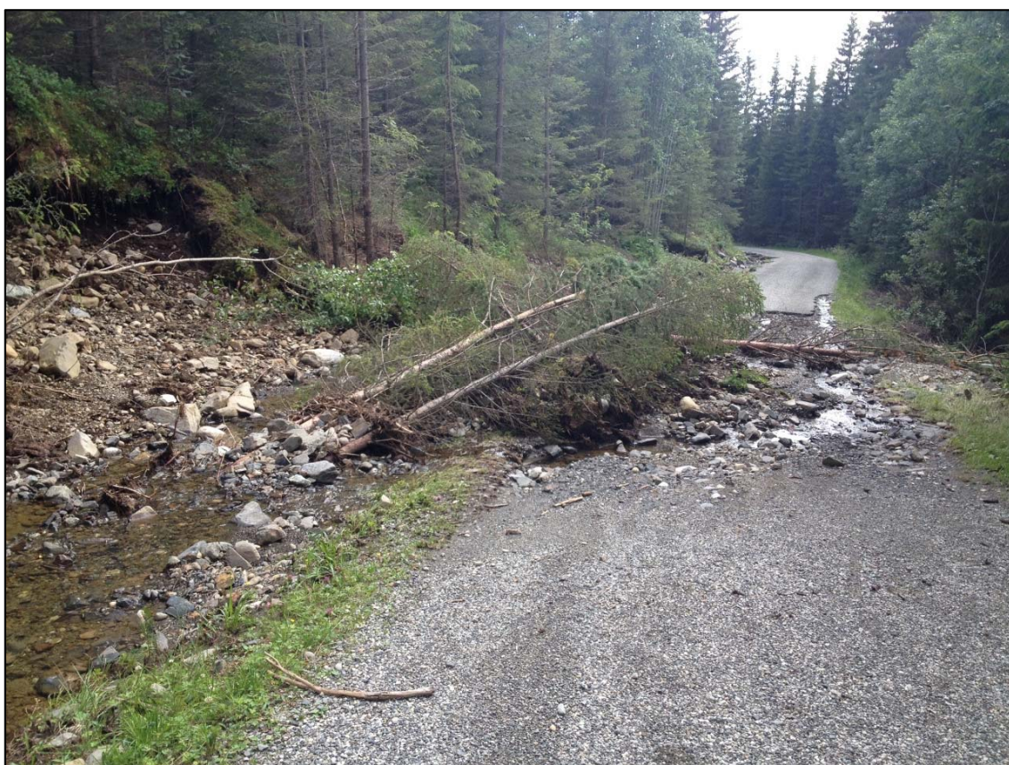
Figur 51: Erosjonsskader langs skogsbilveien (Foto: Steinar Myrabø).
