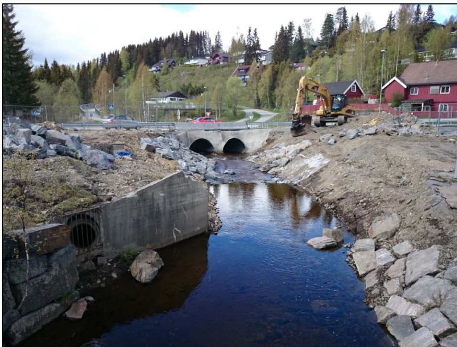
Figur 127: Ny bro er under arbeid ved Røyslimoen, der kjøpesenter og parkeringsplass fikk store skader. (Foto: Anders Breili).
