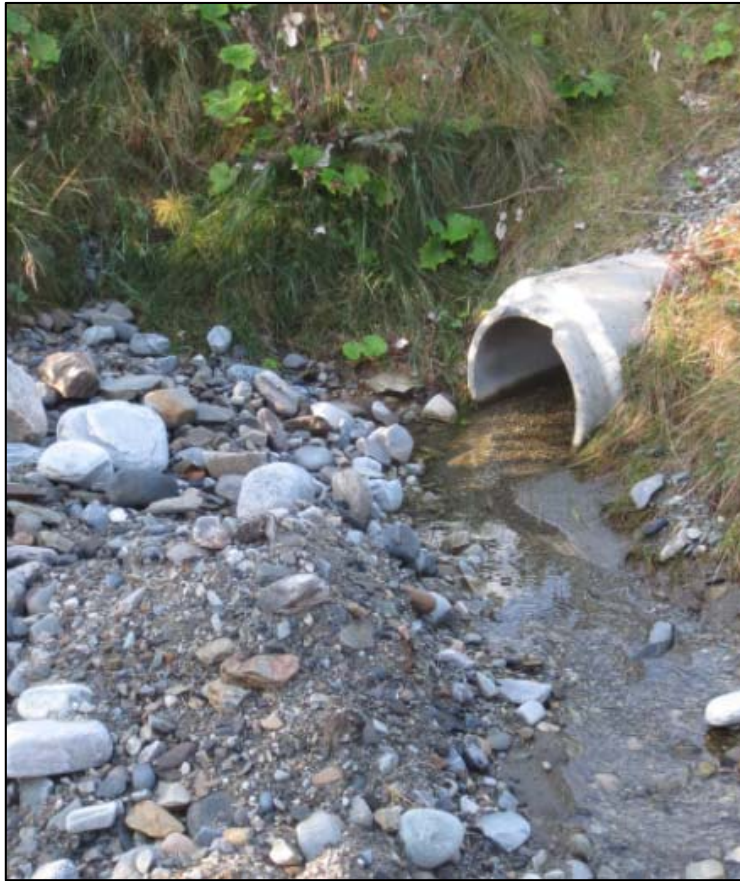
Figur 30: Delvis tett stikkrenne ved Liagårdsveien (Foto: Maria H. Olsen).
