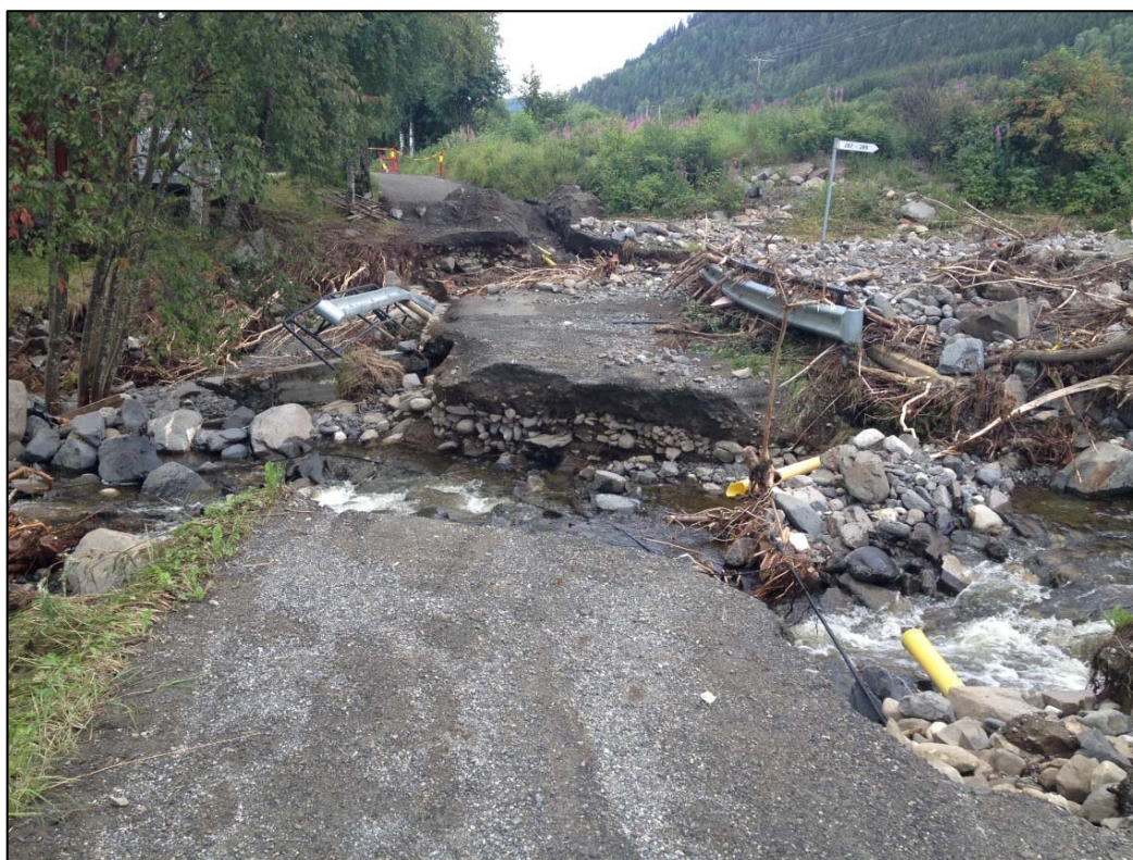
Figur 57: Skader på lokalvei og bru i Bæla (Foto: Steinar Myrabø).
