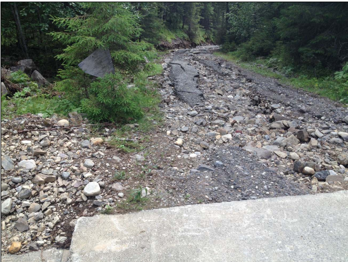
Figur 47: Øverst i feltet hvor ei lita bru hadde for liten kapasitet i forhold til flomvannet og rasket som det førte med seg. Vannet rant derfor opp på veien og videre nedover med påfølgende store erosjonsskader og massetransport (Foto: Steinar Myrabø).
