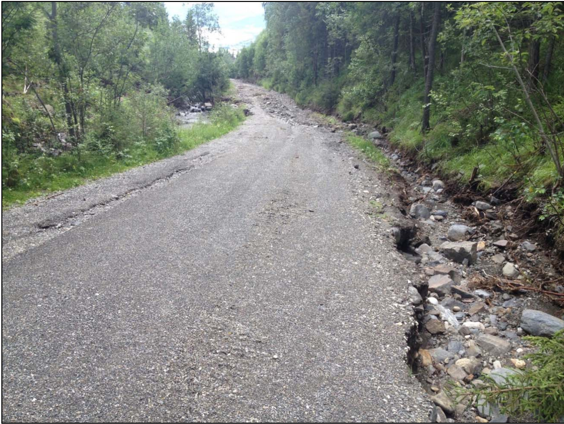
Figur 48: Erosjonsskader langs skogsbilveien (Foto: Steinar Myrabø).
