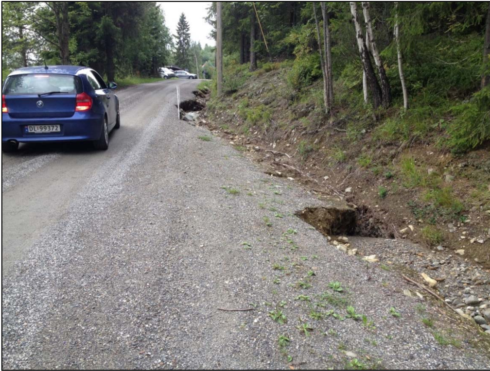
Figur 61: Erosjonsskader i de dårlige grøftene (Foto: Steinar Myrabø).
