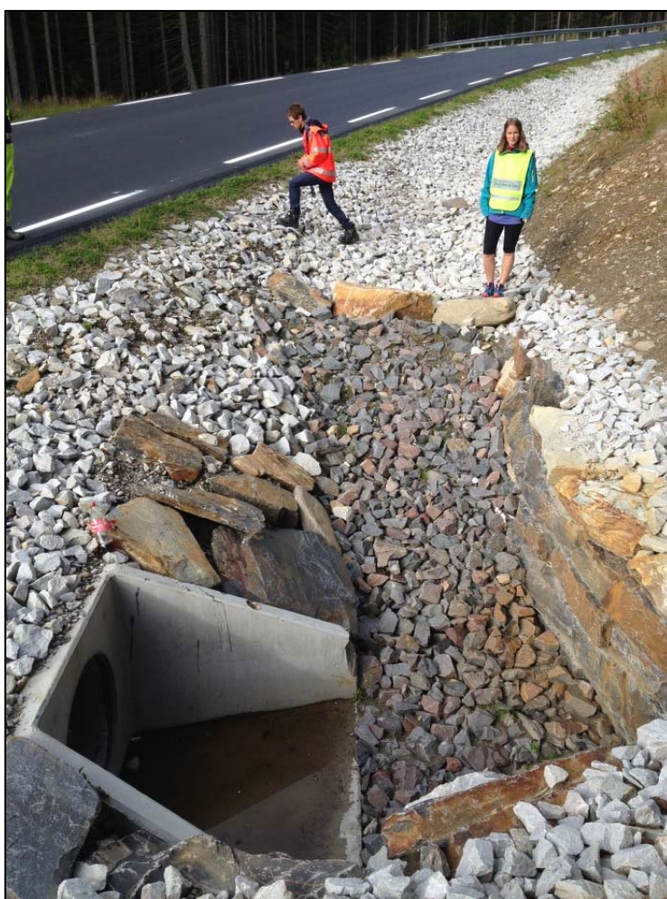
Figur 121: Erosjonssikret grøft med terskel langs Liagårdsveien og ny stikkrenne med erosjonssikret innløp.
