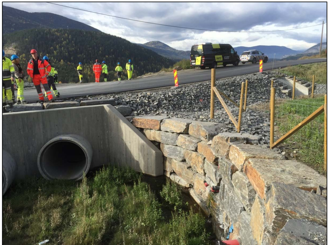
Figur 113: Ny stikkrenne med erosjonssikret nødløp til høyre. Bildet viser samme stikkrenne som i figuren over (Foto: Maria H. Olsen)
