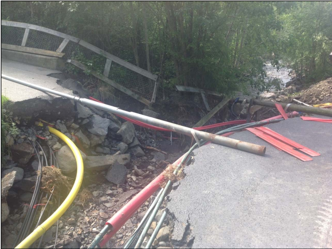
Figur 41: En vei og høyspentanlegg ble totalt ødelagt av vannmassene i området nedstrøms Vårsetergrenda ved Åretta
