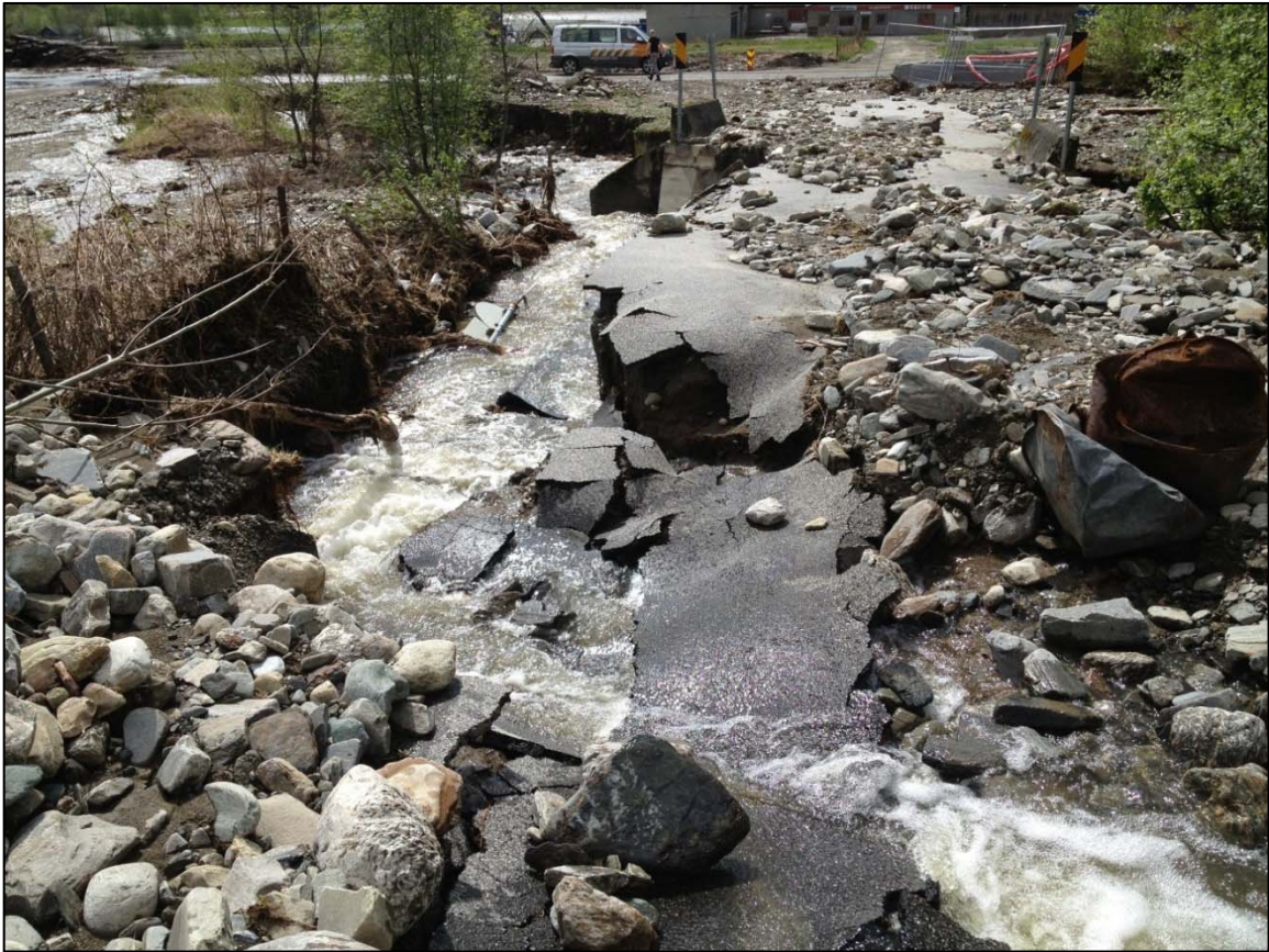
Figur 25: Store skader på vei i nedbørfeltet ved Brandrudsåa (Foto: Steinar Myrabø).
