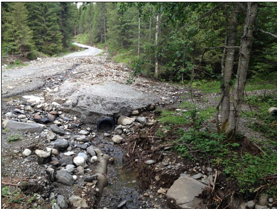
Figur 50: Erosjonsskader langs skogsbilveien (Foto: Steinar Myrabø).
