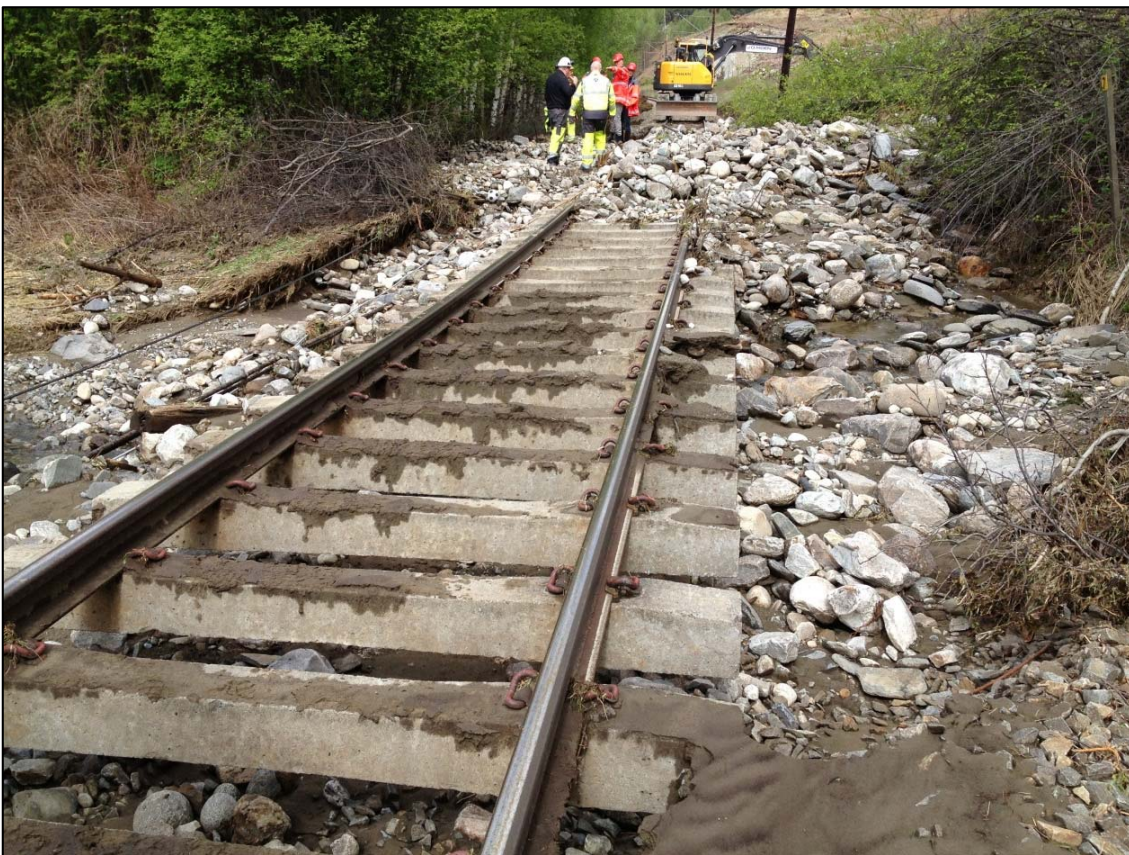
Figur 28: Jernbanen fikk omfattende skader ved Brandrudsåa (Foto: Steinar Myrabø).
