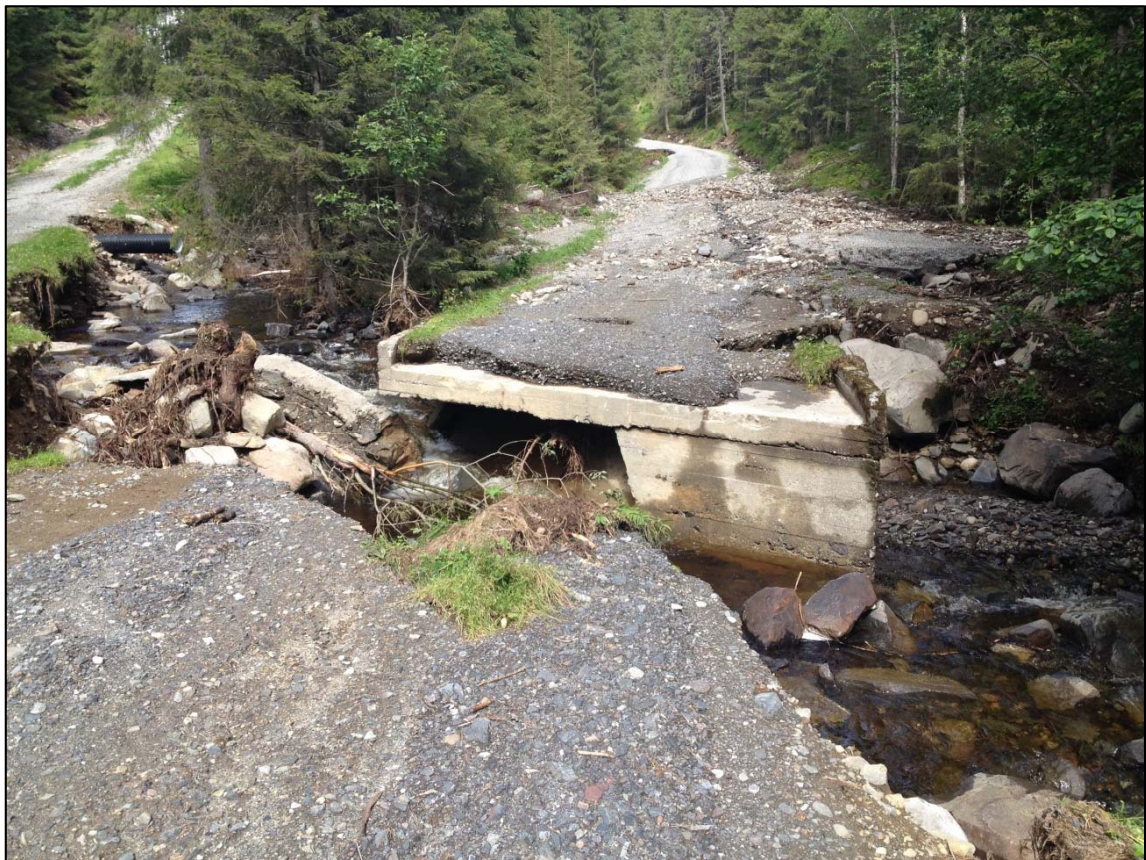
Figur 49: Erosjonsskader langs skogsbilveien (Foto: Steinar Myrabø).
