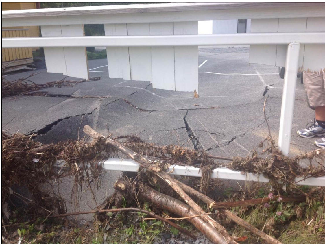
Figur 42: Det var ikke plass til flomvannet og alt rasket det førte med seg i stikkrennen ved kjøpesenteret på Rosenlund nedstrøms Vårsetergrenda. Vannmassene rant opp på parkeringsplassen og eroderte asfalten, slik at det førte til store skader på parkeringsplassen og kjøpesenteret ved Åretta. (Foto: Steinar Myrabø).
