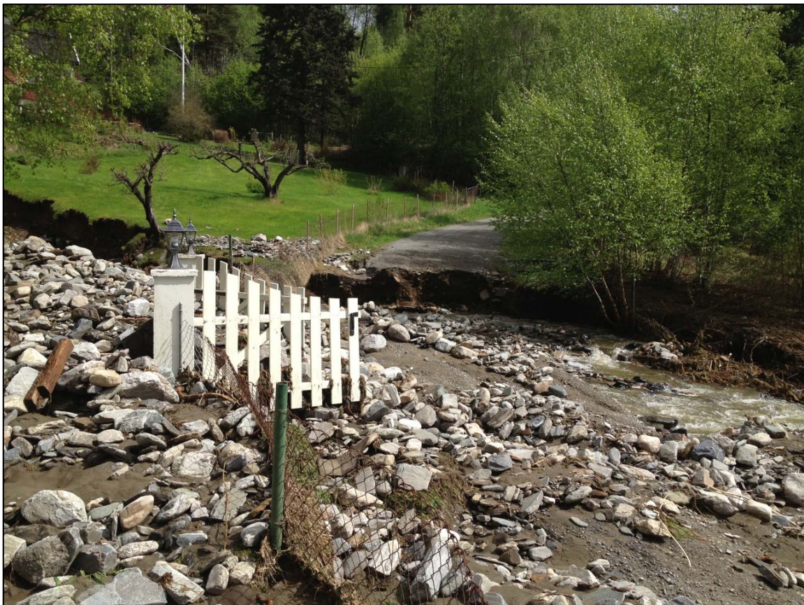
Figur 24: Skader på lokalvei i feltet ved Brandrudsåa (Foto: Steinar Myrabø).
