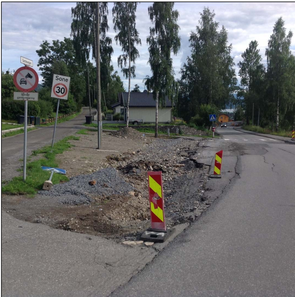
Figur 55: Skader nedover langs Liumbekken (Foto: Steinar Myrabø).
