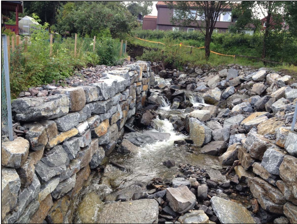
Figur 65: Store erosjonsskader i elvebredden og flomforbygning etter flommen i 2013. Muren til venstre er satt opp ute i elva, slik at vannet får liten plass under flommen (Foto: Steinar Myrabø).
