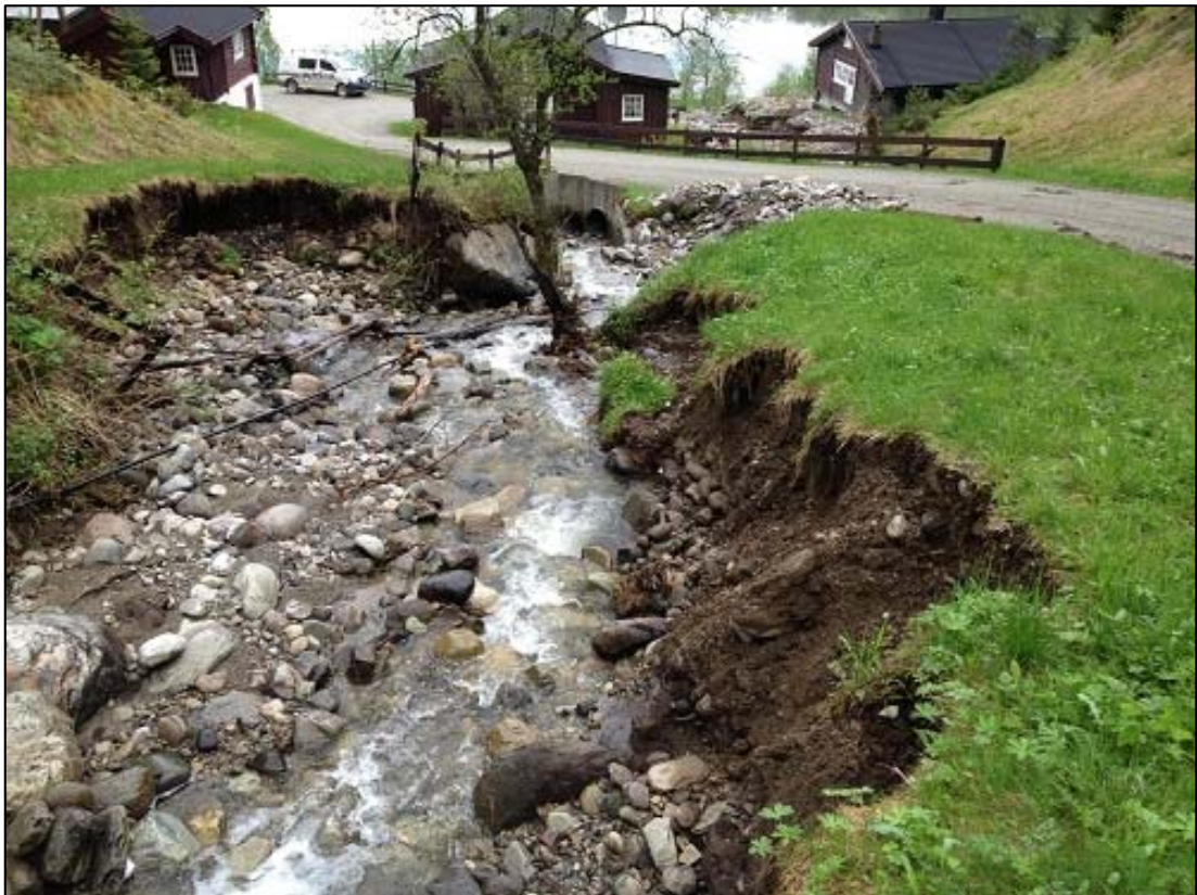
Figur 33: Erosjon i bekk ved Sagstugua (Foto: Steinar Myrabø).
