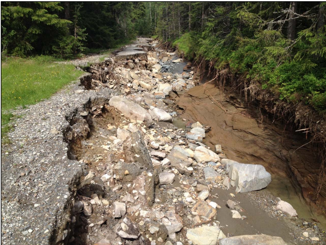
Figur 53: Erosjonsskader langs skogsbilveien (Foto: Steinar Myrabø).
