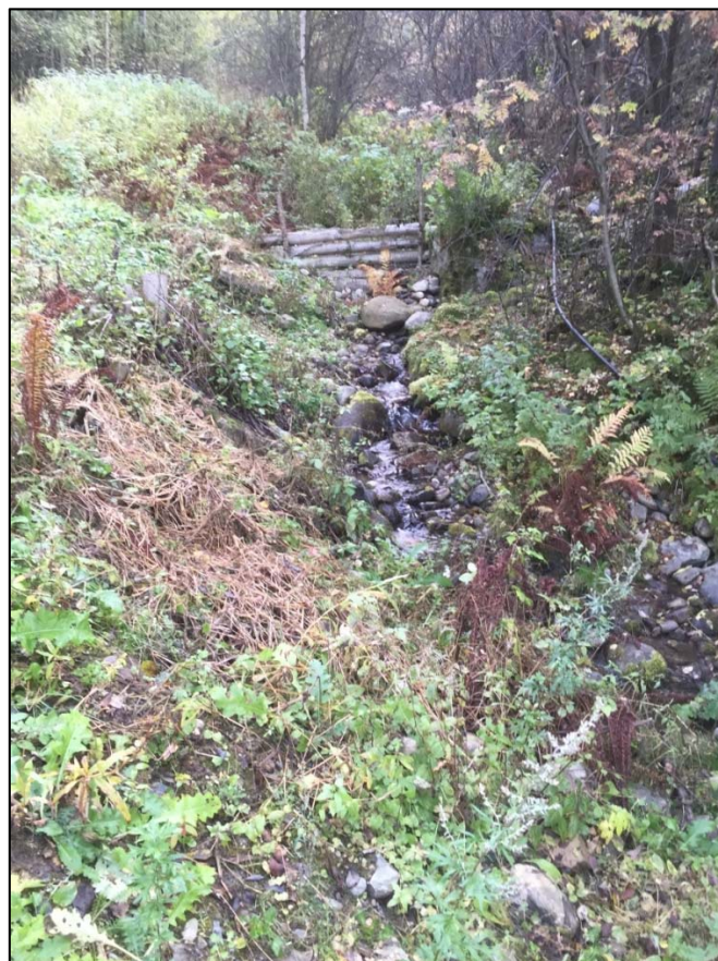
Figur 117: Stokkdammer er etablert i sidebekk til Brandrudsåa som sedimentfangere og flomdempende tiltak et stykke oppstrøms ny E6. (Foto: Maria H. Olsen).
