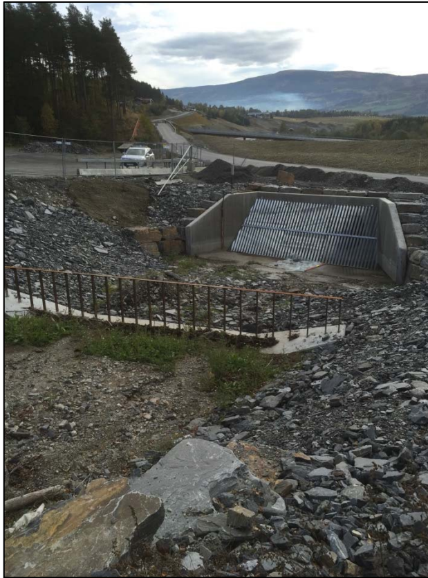
Figur 114: Ny stikkrenne med erosjonssikret innløp og to rister i forkant for å fange opp løsmasser og vegetasjon i Brandrudåa like oppstrøms ny E6. Rista rett foran stikkrennen er pålagt p.g.a. lang bekkelukking. (Foto: Maria H. Olsen).
