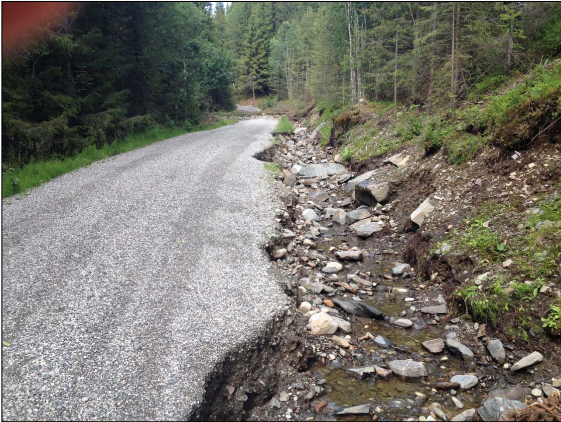
Figur 52: Erosjonsskader langs skogsbilveien (Foto: Steinar Myrabø).
