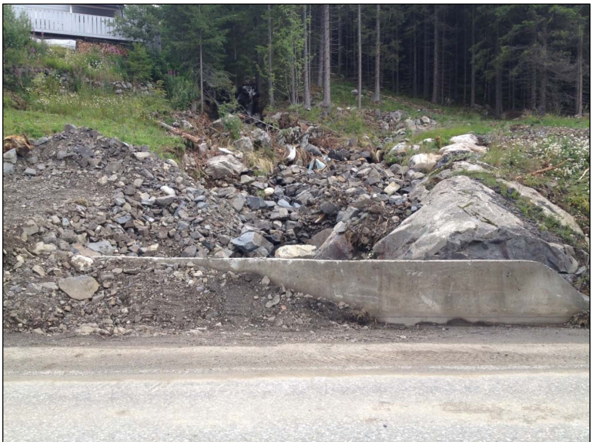
Figur 40: Løsmasser avsatt i forkant av stikkrenne under vei i Vårsetergrenda ved Åretta. (Foto: Steinar Myrabø).
