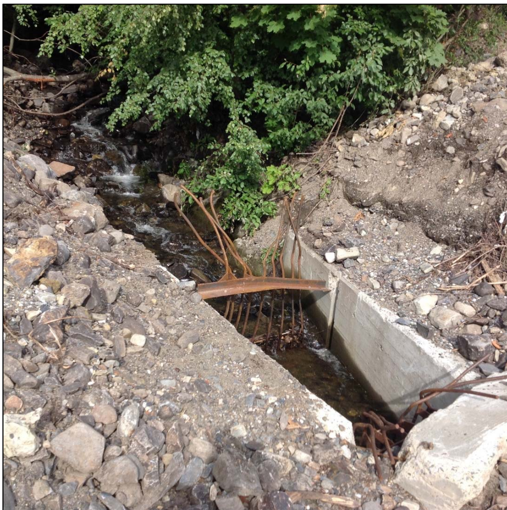
Figur 59: Skader nedover i Liumbekken. Her har det tydeligvis vært mye massetransport og rister som har forverret situasjonen.
