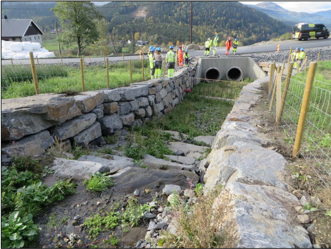
Figur 112: Nye stikkrenner med rist i forkant for å fange løsmasser og vegetasjon. Bildet viser samme stikkrenne som i figuren over (Foto: Agathe A. Hopland).
