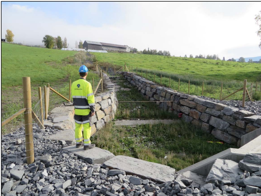
Figur 111: Erosjonssikret i bekkeløp inn mot stikkrenne. Terskler er bygget i bekkeløpet for å dempe vannhastigheten.
