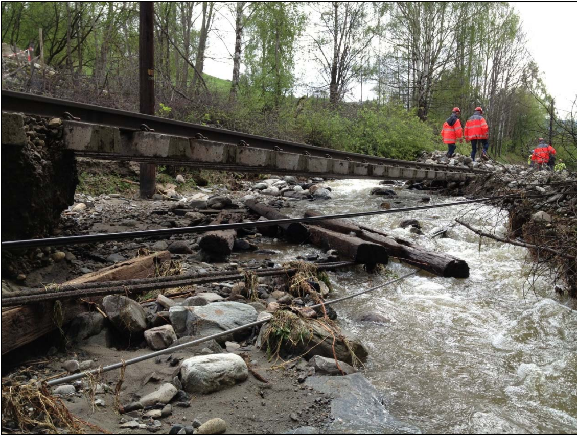
Figur 27: Jernbanen fikk omfattende skader ved Brandrudsåa (Foto: Steinar Myrabø).
