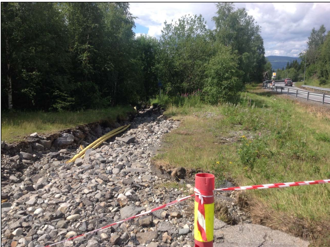
Figur 44: VA-ledning ble gravd opp av vannet under flommen. (Foto: Steinar Myrabø).
