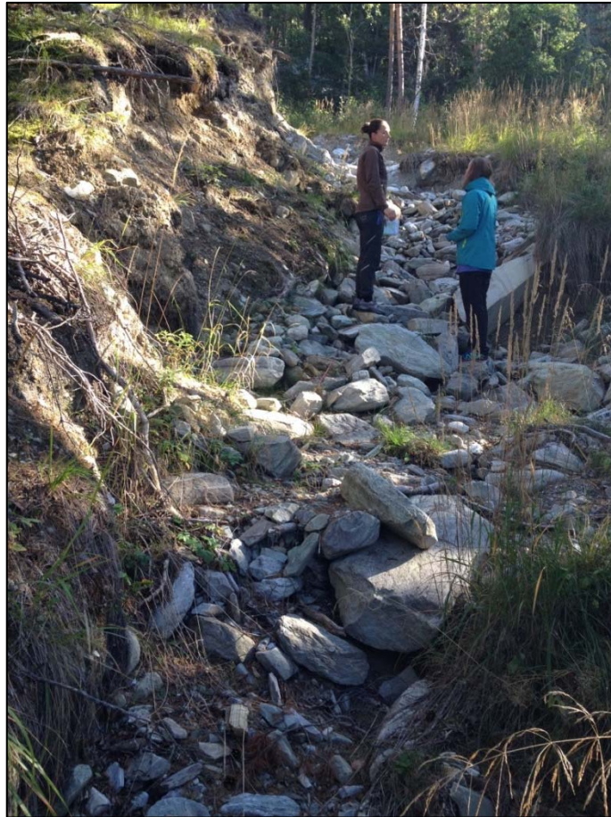
Figur 16: Tett stikkrenne førte til at vannet eroderte i skogsbilveien ved Kloppa (Foto: Steinar Myrabø, sept. 2014).
