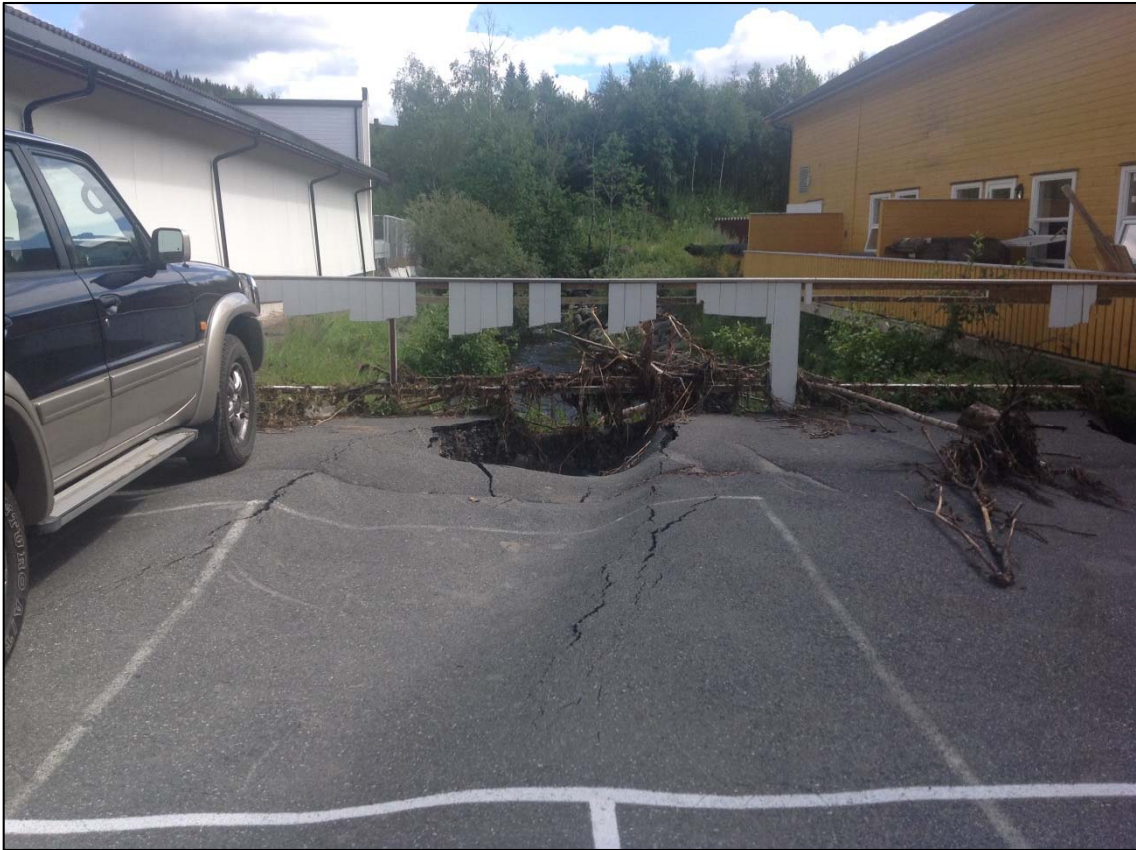
Figur 43: Hull i asfalten på en parkeringsplass etter vannet har erodert under asfalten. (Foto: Steinar Myrabø).
