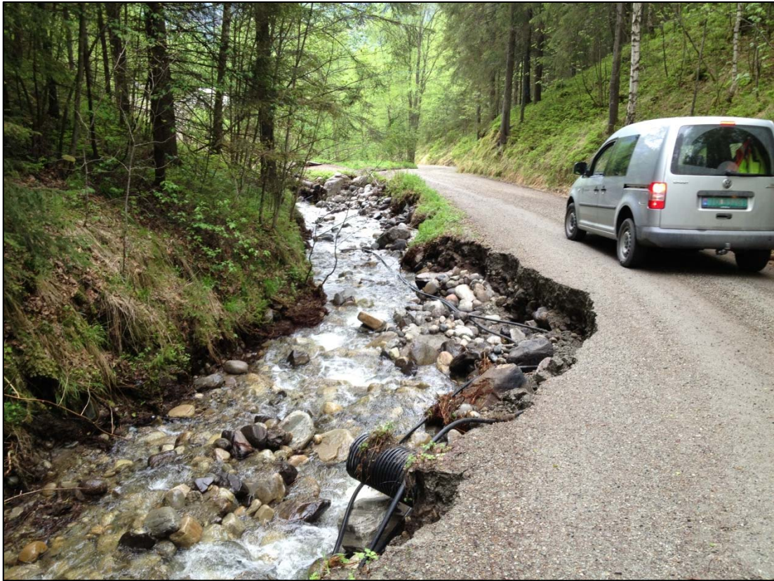
Figur 32: Erosjon i gårdsveien ned til Sagstugua (Foto: Steinar Myrabø).
