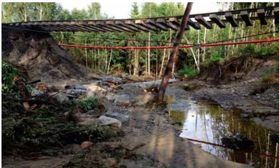
Figur 10: Store vannmasser ble samlet opp bak jernbanefyllingen ved Burud og skapte så stort trykk at fyllingen raste ut. Foto: Steinar Myrabø, 2012.
