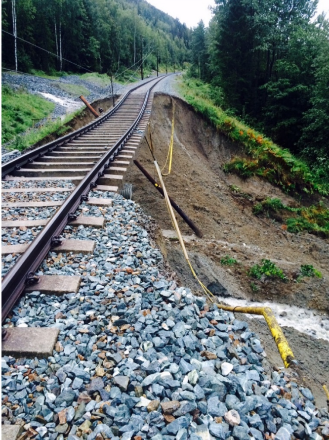
Figur 1.2. Gulsvik september 2015. Flom har undergravd Bergensbanen. Foto: Trygve Kleiven, JBV
