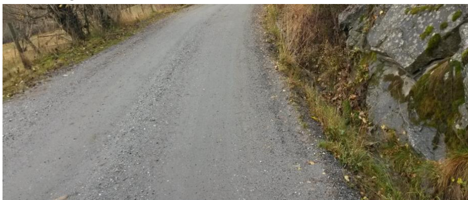
Figur 27 Manglende grøft der det er behov for å sprengre for å lage grøft
