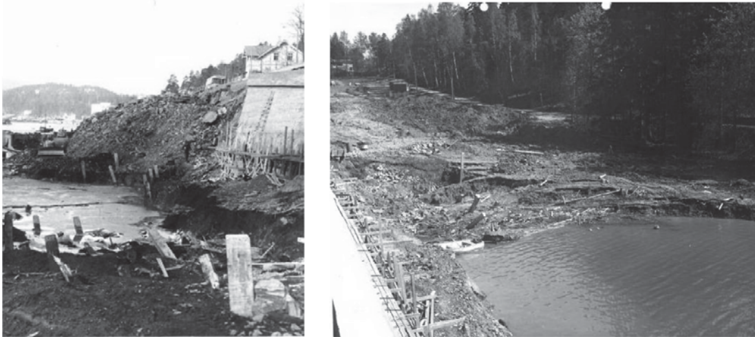
Figur 2-5: Utglidning ved E18 ved Mustadjordet i forbindelse med peleramming (bilde fra Statens Vegvesen).
