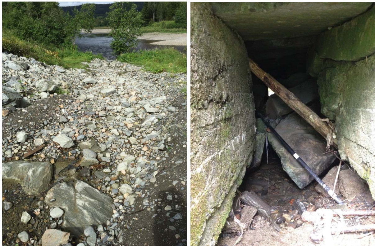
Figur 44 Venstre: Ingstadbekken sitt utløp til Stjørdalselva (Foto begge: Agathe Alsaker Hopland). Høyre: Overbelasta stikkrenne under Meråkerbanen (Foto: Kristin Skei).
