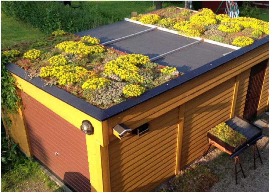
Figur 33 Testtak for måling av naturleg avrenning i Oslo (Foto: Bent C. Braskerud).
