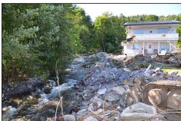
Figur 5 Erosjonsskadar langs Lysakerveien i Nedre Eiker kommune etter stormen Frida i august 2012 (Foto: NVE).
