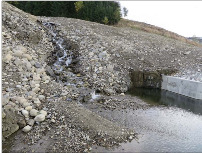
Figur 31 Sedimentasjonsbasseng langs E6 Frya-Sjoa i Oppland (sidebekk til Brandrudsåa). Bildet viser at bassenget har behov for tøyming (Foto: Agathe Alsaker Hopland).
