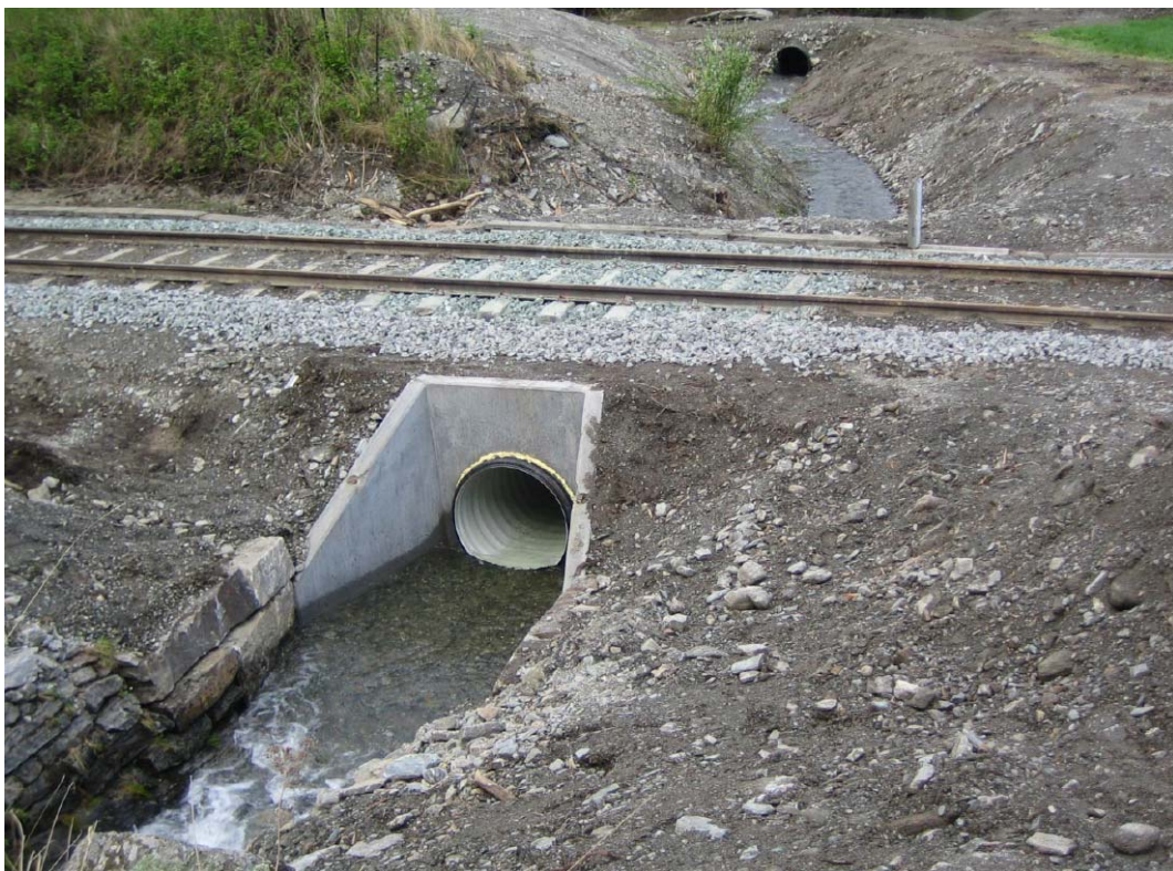
Figur 21 Ny stikkrenne 2013 under jernbana mellom Sjoa og Otta (Foto: Jernbaneverket).
