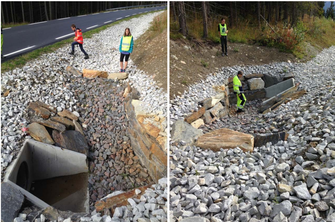
Figur 19 Erosjonssikra grøft med terskel og ny stikkrenne med erosjonssikra innløp langs Liagardsvegen på Fåvang i Oppland (Foto venstre: Steinar Myrabø. Foto høgre: Maria Hetland Olsen).
