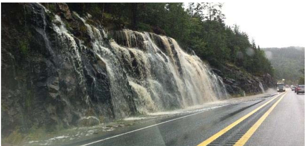
Figur 2.5: Oversvømmelse på veg som skyldes både dårlig kapasitet i sidegrøfter og i stikkrenner, Fv. 60 Olden. (Foto: K. Kjesbu).
