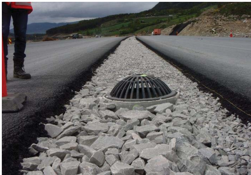
Figur 6.7: Eksempel på bygging av firefelts veg med grøft og lukket drenering i midtdeleren, E6 Hundorp (foto: H. Norem).
