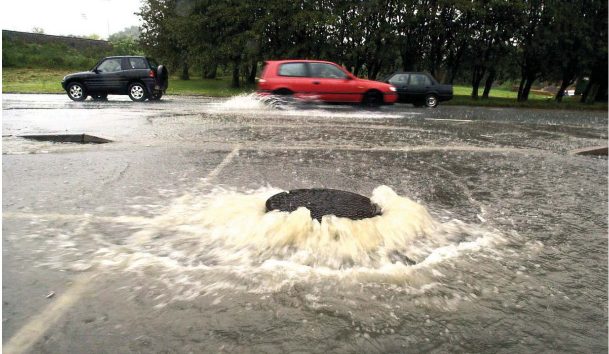
Figur 6.34: Ved underdimensjonerte overvannsledninger vil vannet flomme ut av kummene. Foto: Terje Reiersen, Basal.
