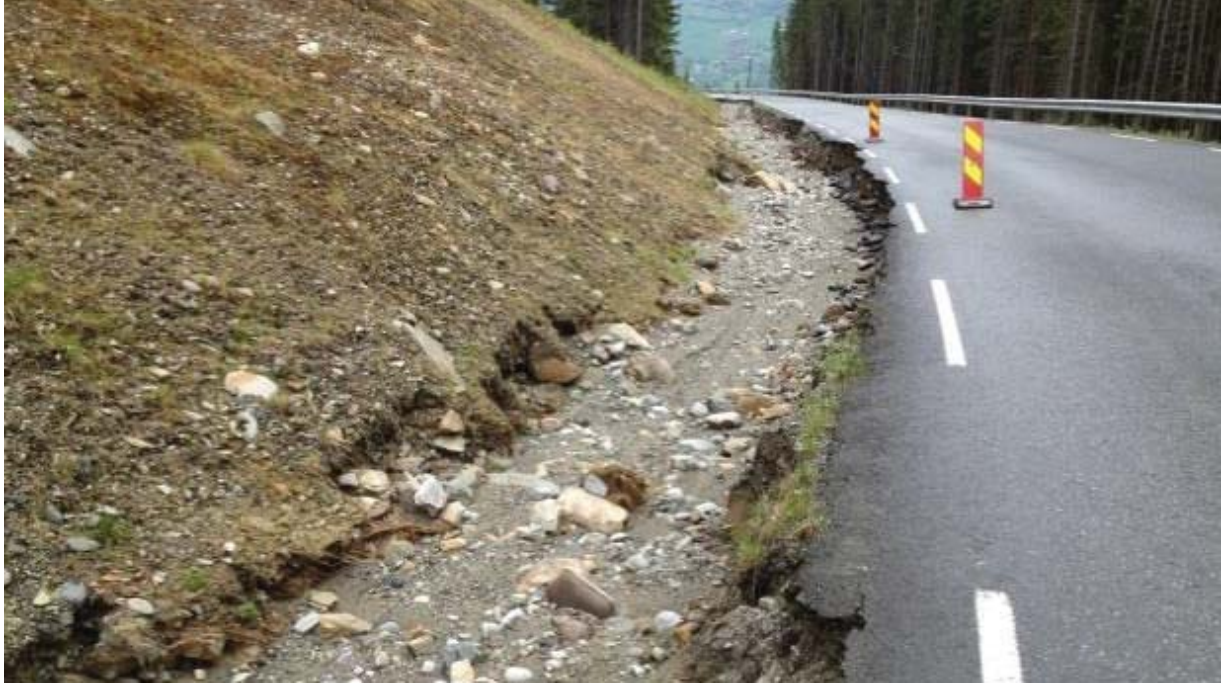
Figur 2.8: Skader på grøft og vegskråning etter flom. Veg til Kvitfjell (foto: S. Myrabø).
