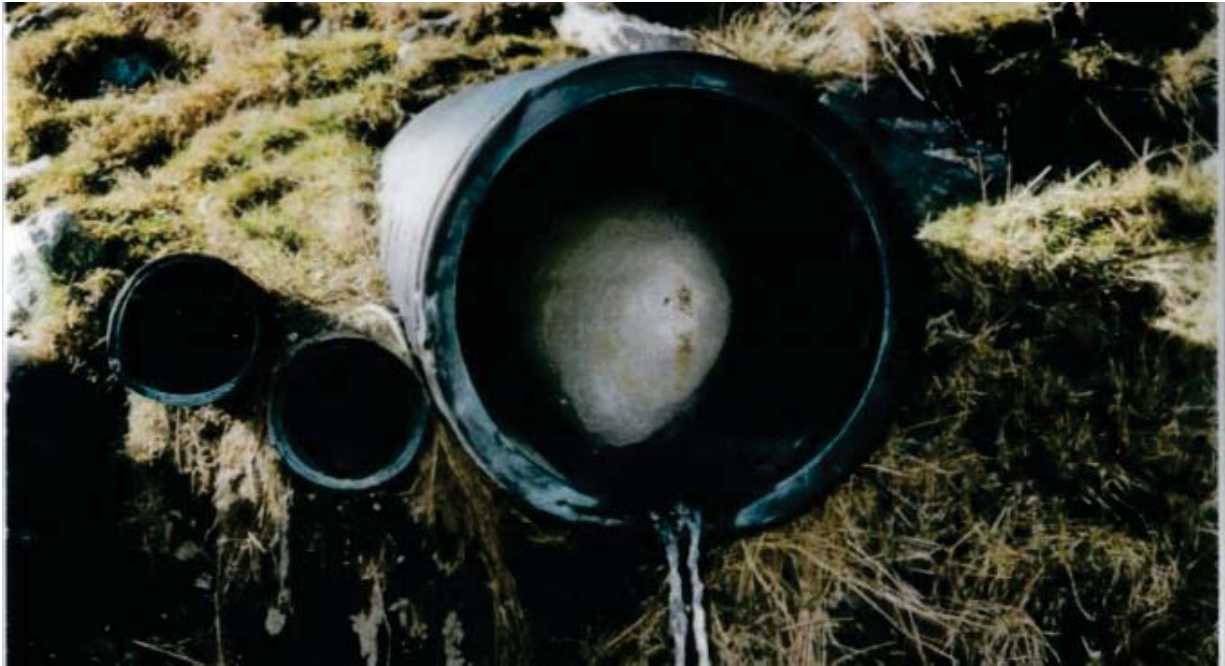
Figur 4.10 a) og b): Isdannelse og blokkering av is i stikkrenner kan bli et alvorlig problem. Tendensen kan reduseres ved å skjerme innløp og utløp, eventuelt montere en ekstra stikkrenne som ligger tørt om vinteren, E6-prosjektet, Hundorp. (Foto: H. Norem).
