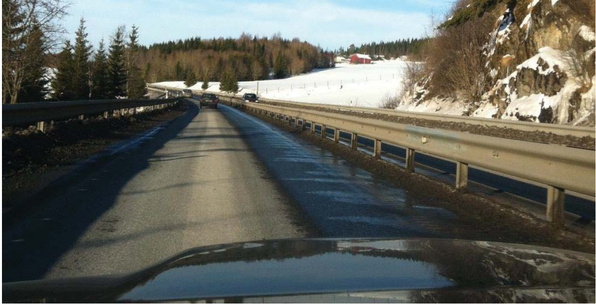
Figur 6.6: Smeltevann fra brøytekannt mot rekkverk som har rent ut i kjørebanelen, E6 Skaberud (foto J. Nøkleholm).
