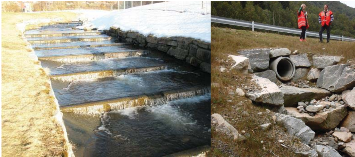
Figur 4.14: Eksempler på renner bygget med trappetrinn. Det venstre er fra Ilabekken i Trondheim og bygget i forbindelse med Nordre avlastningsveg. Det høyre er fra E39 ved Batnfjordsøra. Foto: H. Norem.
