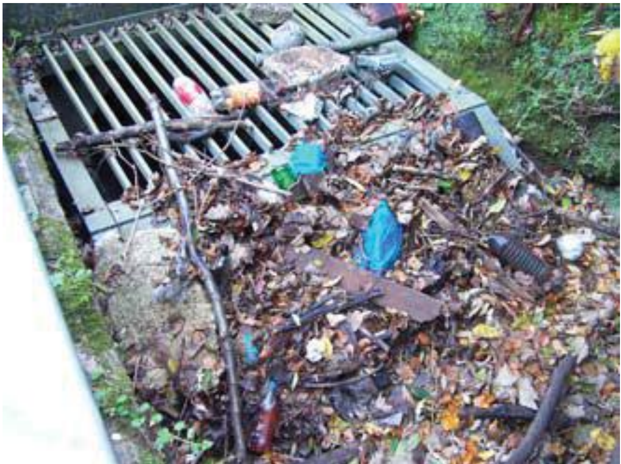
Figur 4.19: Eksempel på stikkrenne som holder på å tettes på grunn av søppel som har samlet seg rundt innløpet. (Wallerstein og Arthur 2012).
