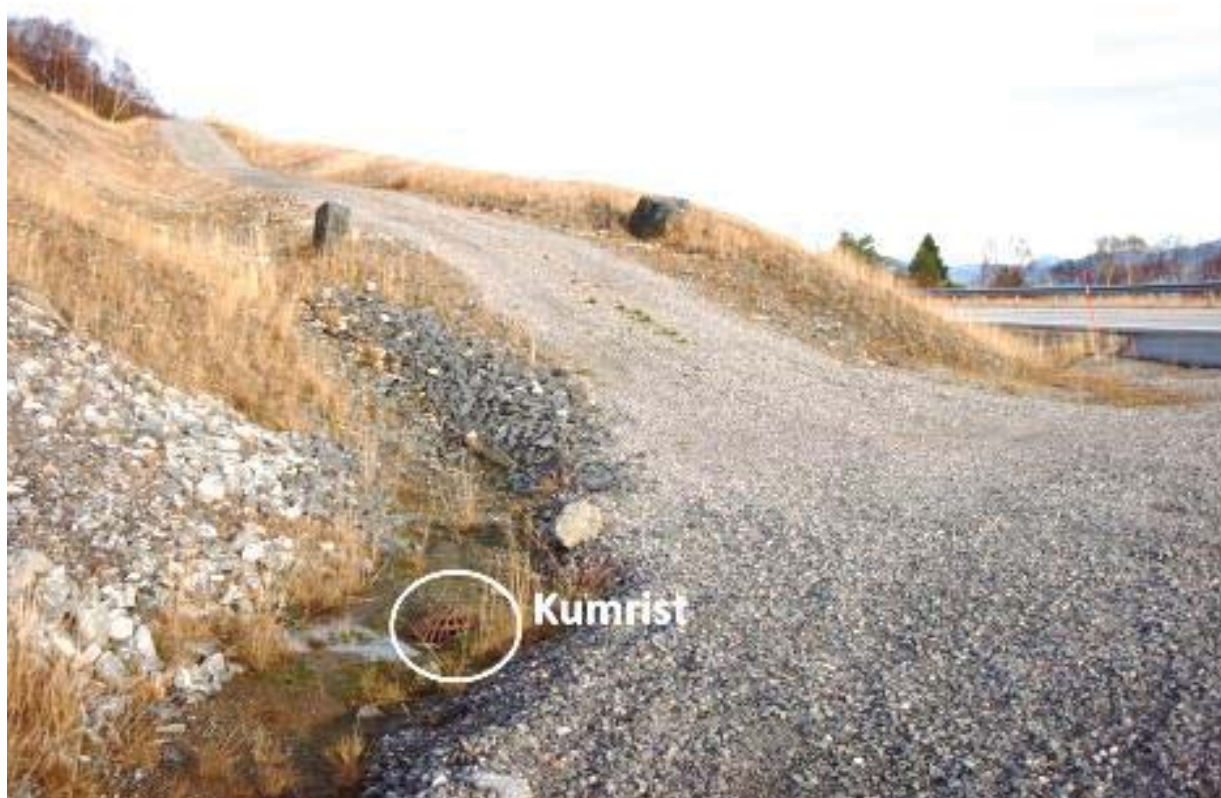
Figur 4.35: Driftsveger med åpen drenering ovenfor skjæringene fungerer som effektive terrenggrøfter. Vannføringen i slike grøfter kan bli betydelige, og inntaket til stikkrennene må dimensjoneres i forhold til dette, E39 Gjemnes. (Foto: H Norem).
