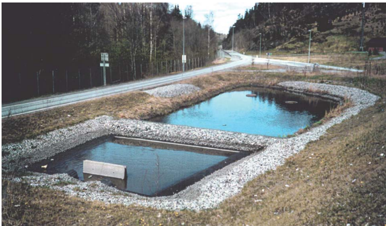
Figur 4.29: Eksempel på overvannsdam som rensiltak. Dammen er bygget med to kamre, og i forbindelse med innløpet er det bygget en betongvegg som energidreper. E6 Hvattum (Foto: S. Endresen 2006).
