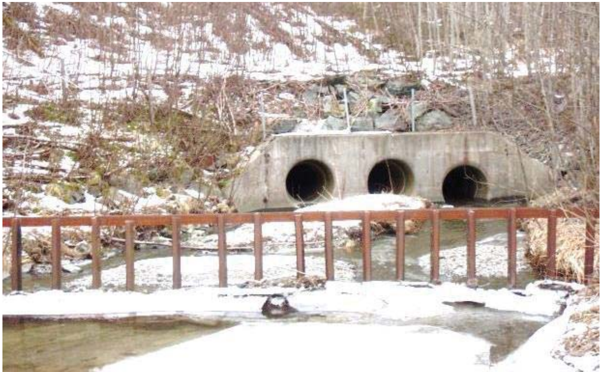
Figur 4.20: Eksempel på rist i fremkant av stikkrenne for å fange opp sedimenter, greiner og søppel. De tre stikkrennene er lagt i forskjellig høyde for at minst en av dem skal være fri for is og sedimenter i forbindelse med flom. Rødde, Dovrebanen. (Foto: H. Norem).
