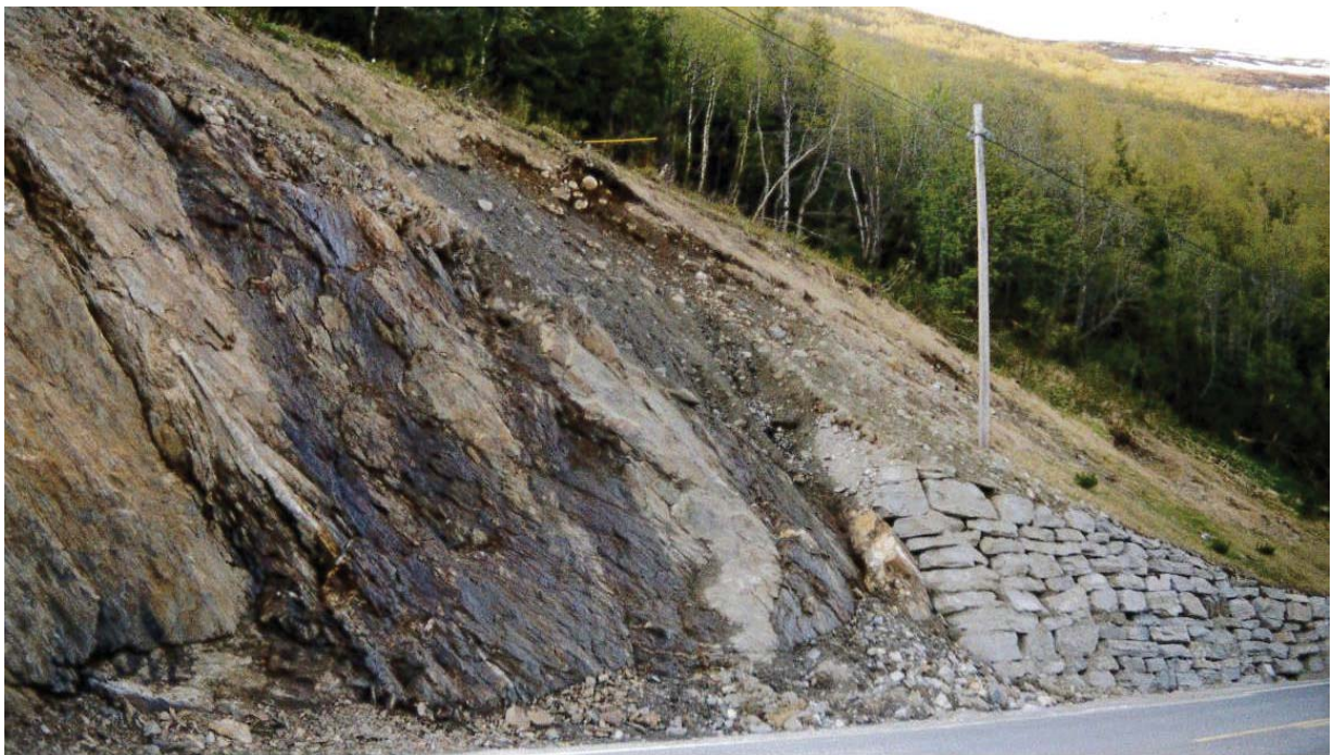
Figur 4.33: Eksempel på bergskjæring Høyre bilde: utglidning av jordras, som dekket hele vegen, etter at vann rant ut over en jordskjæring. E39 Hemnkjølen. Foto: H. Norem.
