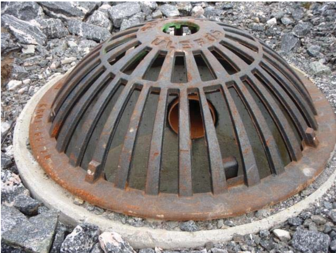
Figur 6.24: Eksempel på kuppelrist for å fange opp vann fra grunne sidegrøfter, E39, Gjemnes, Møre og Romsdal (foto: Harald Norem).
