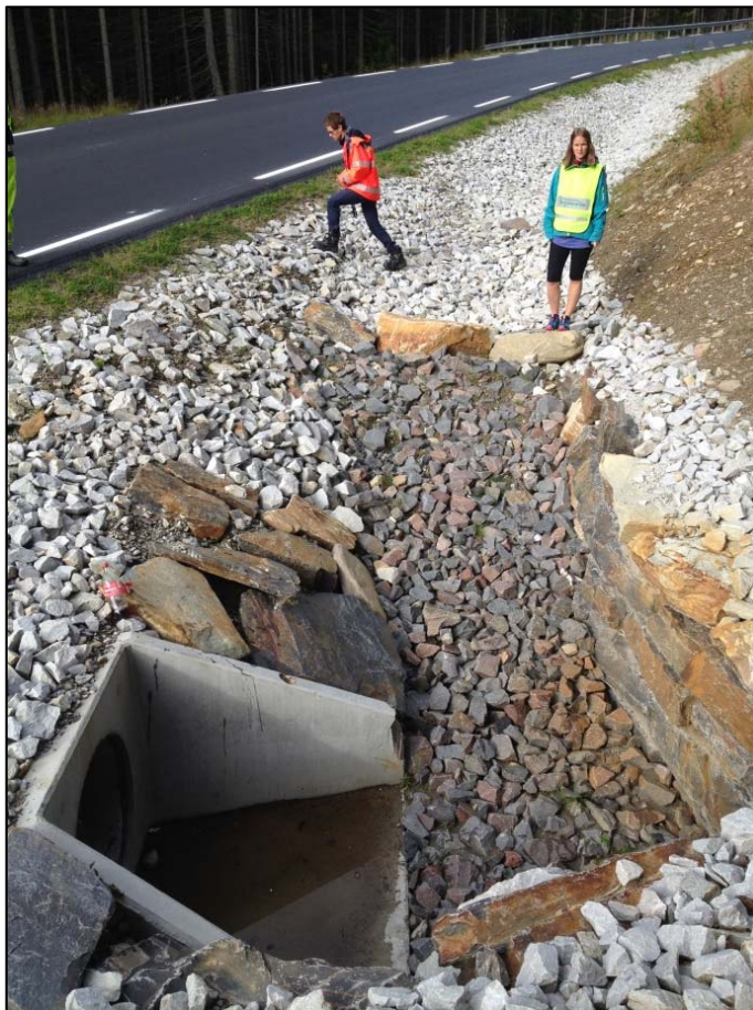
Figur 4: Åpent grøfteinntak til stikkrenne med energidreping i erosjonssikret grøft langs Liagardsvegen. I tillegg er det gjort tiltak rett nedstrøms for lede vannet inn i stikkrennen, som har vingemurer.
