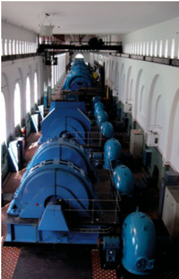
Maskinhallen i Tysso I etter restaureringen i forbindelse med fredningen. Foto: Harald Hognerud/NVIM
