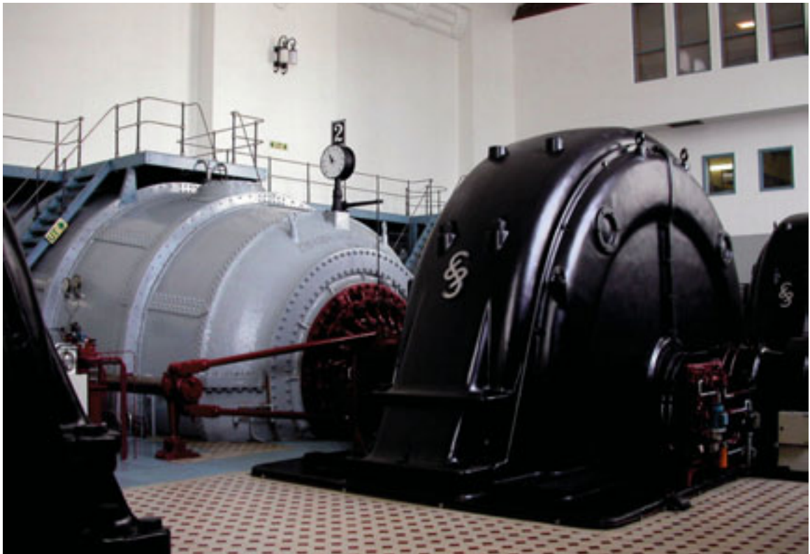
Horisontalt aggregat med dobbel, horisontal Francis-turbin og generator. Foto: NVE
