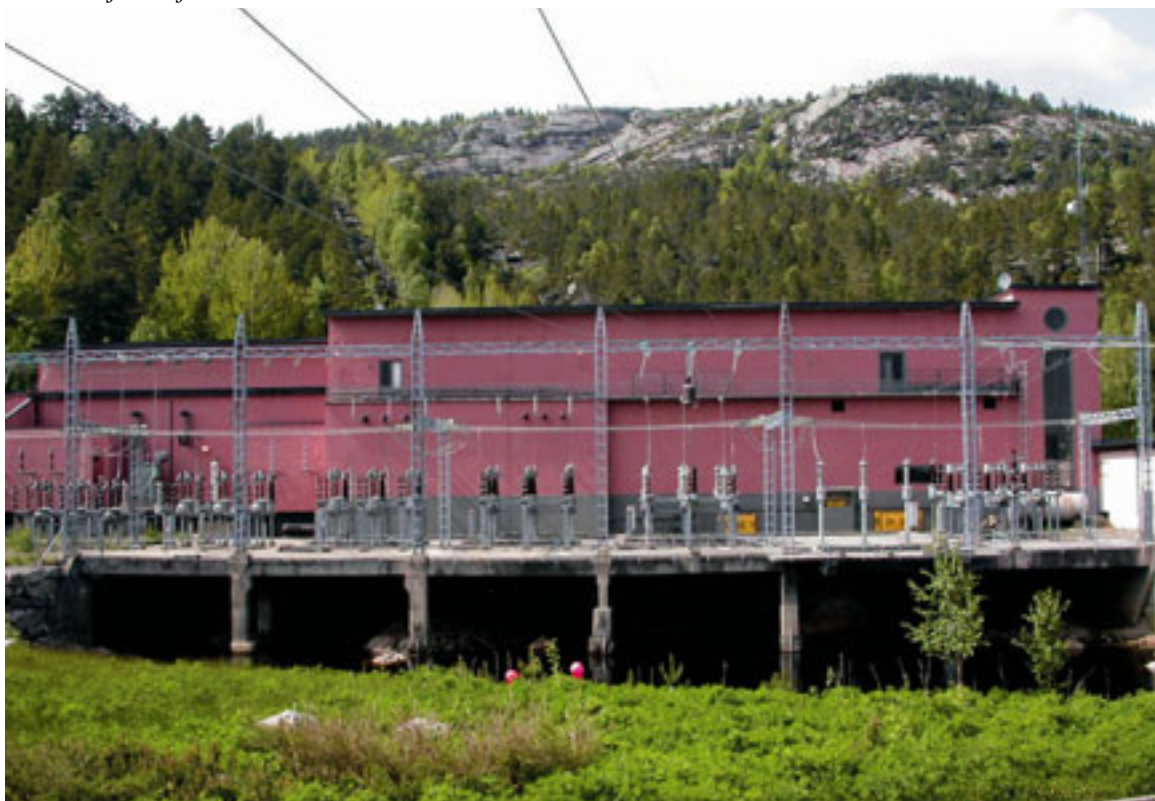
Kraftstasjon Skjerka. Foto: Margrethe Moe 2005/NVE
