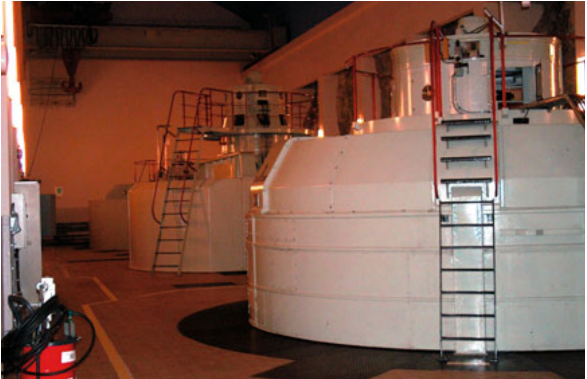
Maskinsal Nedre Fiskumfoss. Foto: Nord-Trøndelag Elektrisitetsverk
