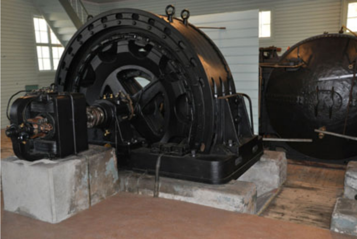
Kuråsfossen I, generator. Foto: Helena Nynäs 2010/NVE
