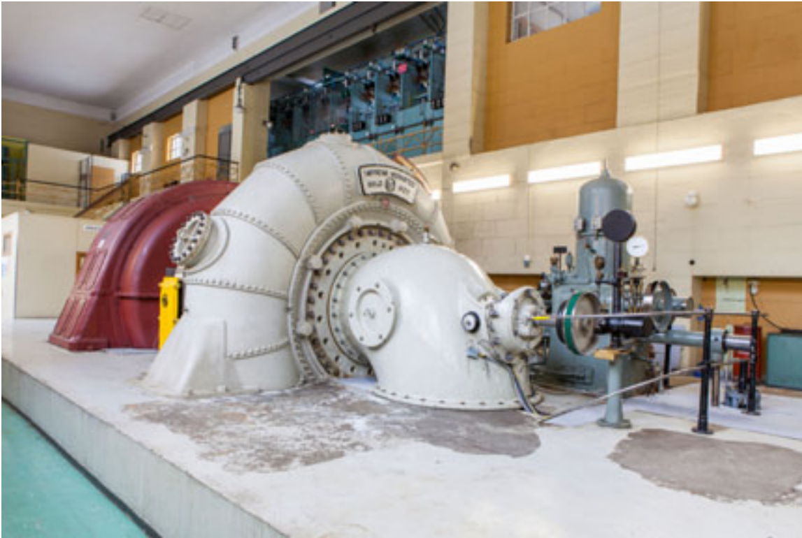
Maskinsal Hammeren kraftstasjon. Foto: Dag Endre Opedal/NVIM
