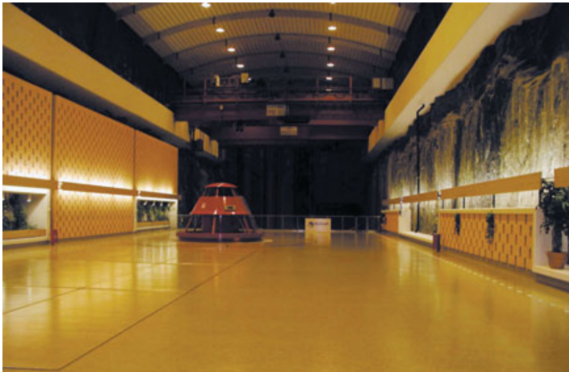
Svartisen kraftverk ble satt i drift i 1993. Foto: Statkraft
