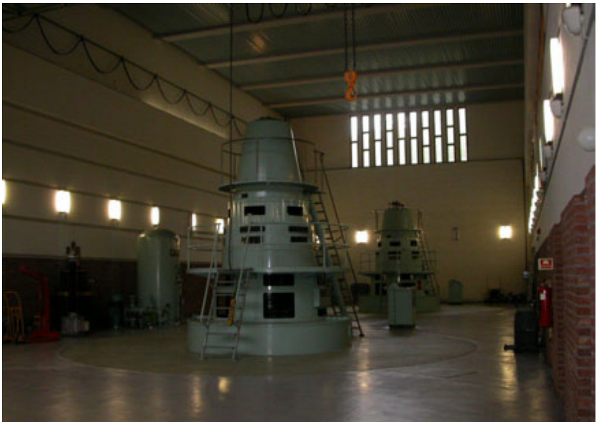
Generatorene "Sigrid" og "Leopold" i Skogfoss kraftstasjon. Foto: Margrethe Moe 2004/NVE
