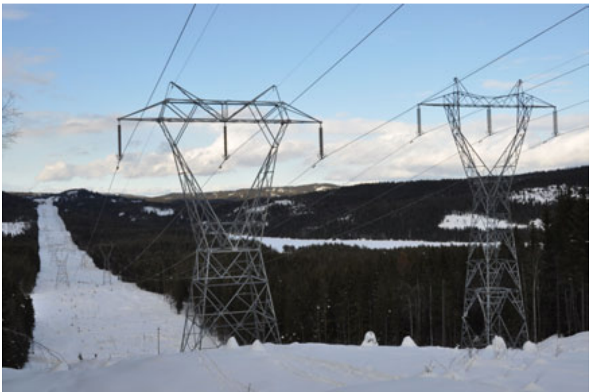
Kraftledningen Hol – Oslo går blant annet gjennom Nordmarka. Foto: Sissel Riibe/NVE
