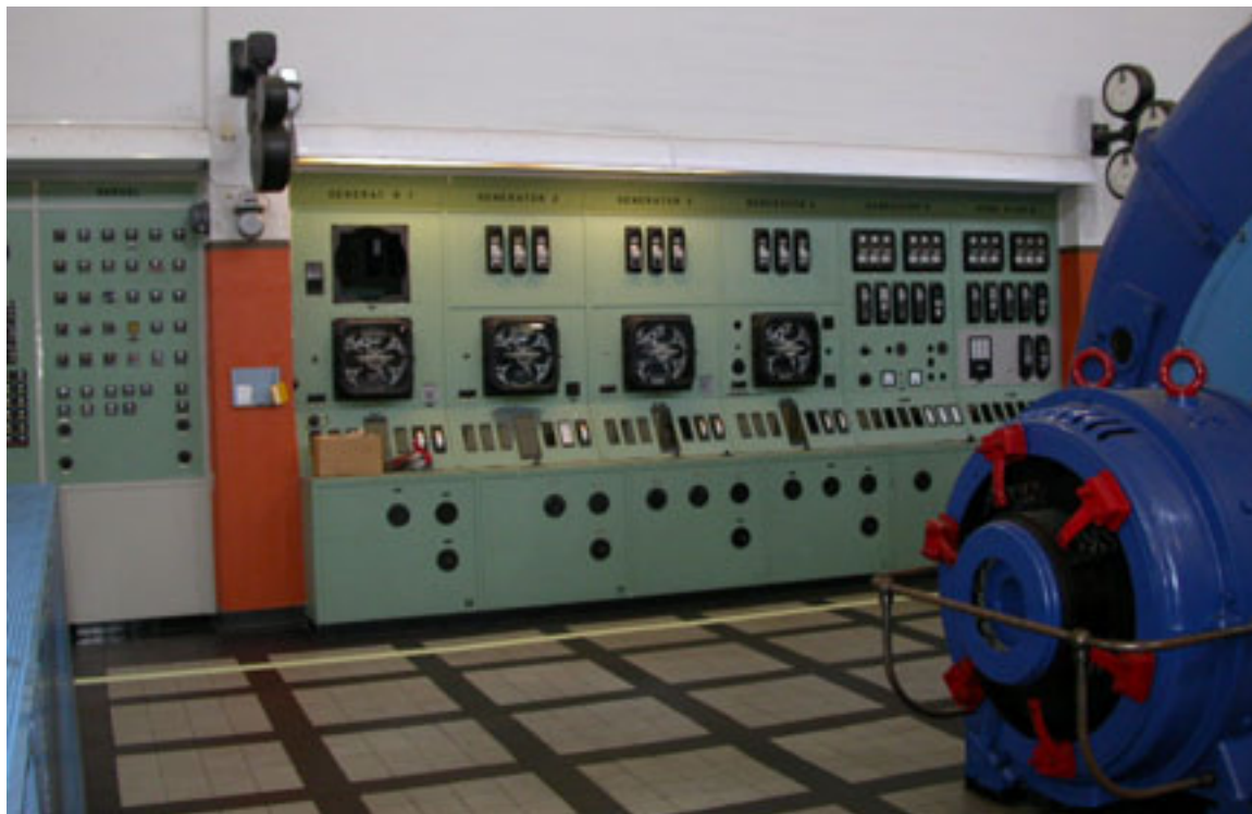
Interior i Skjerka kraftstasjon fra 1932. Foto: NVE, 2005
