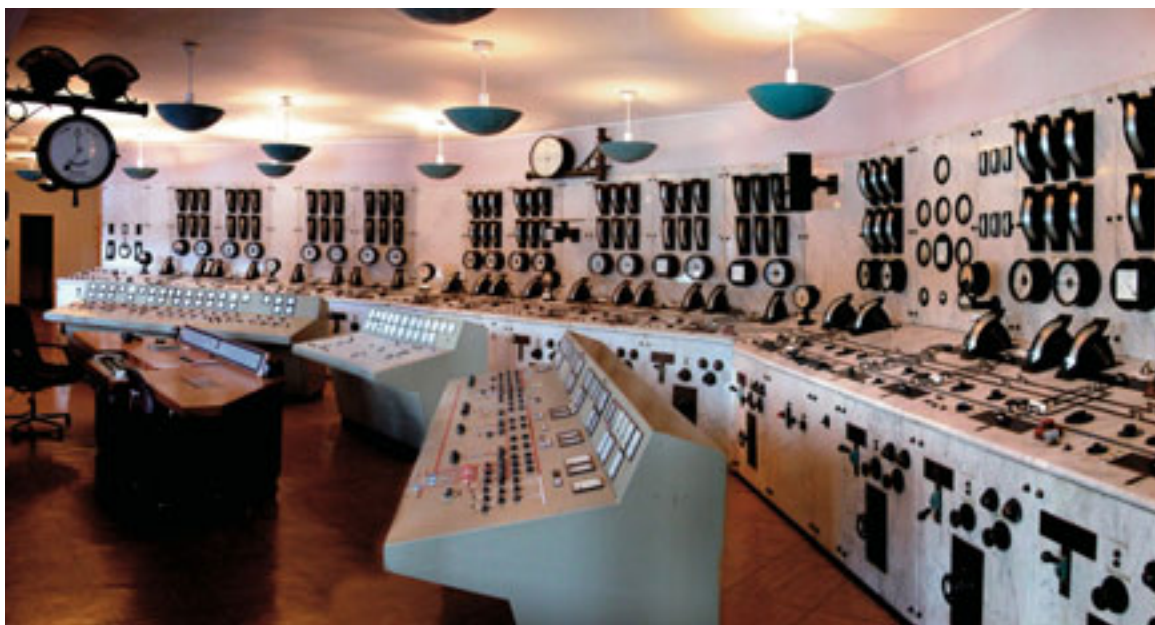
Kontrollrommet på Tysso I. Flere generasjoner kontrollpaneler sees plassert innover.
