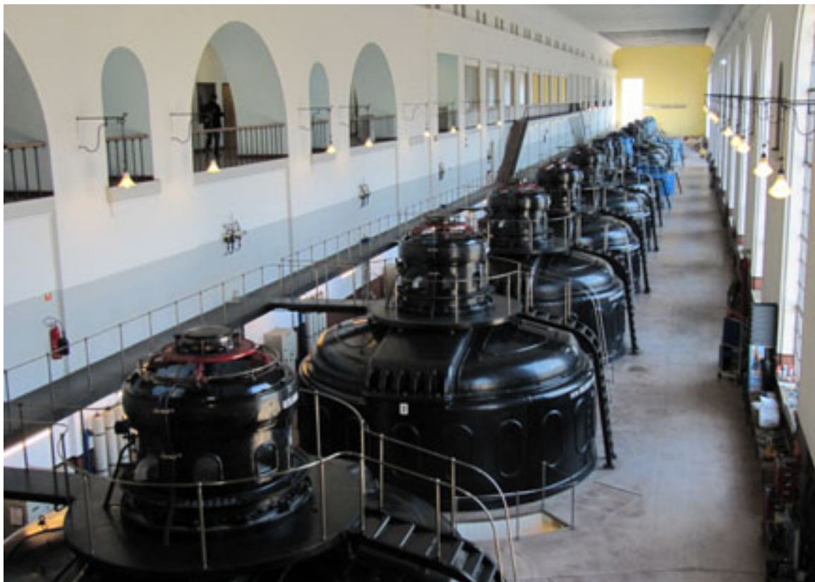
Maskinsal i Solbergfoss kraftstasjon. Foto: Helena Nynäs 2010/NVE
