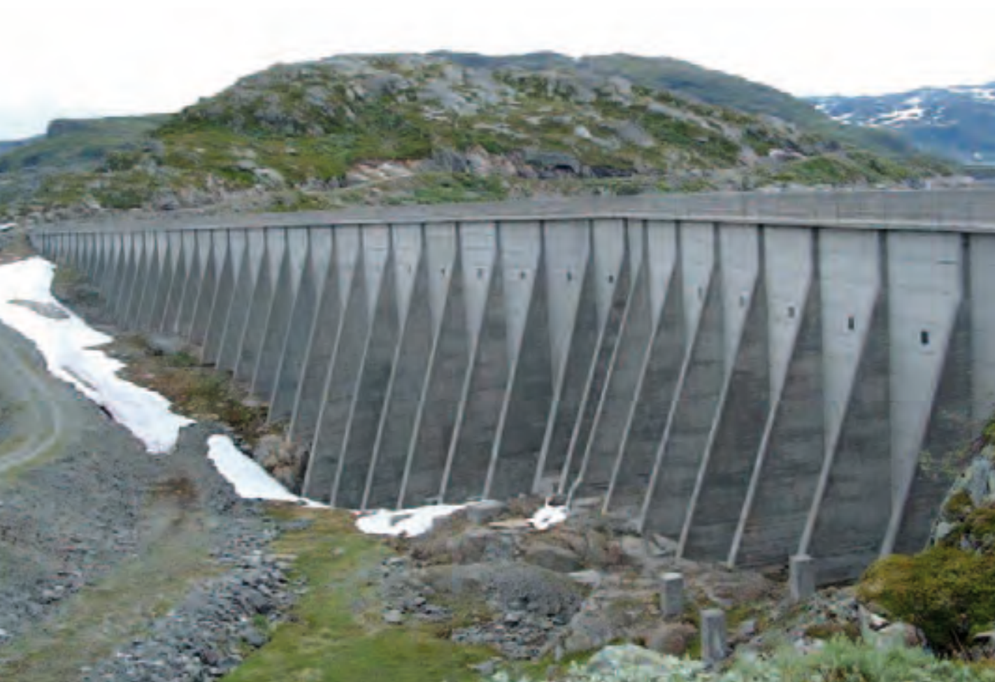
Platedam, Votna II fra 1966 ved Røldal-Suldal-anleggene, Haukeliffjell
