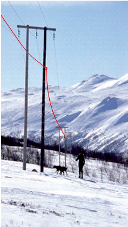
Kraftledning med underliggende jordline markert med rødt.
