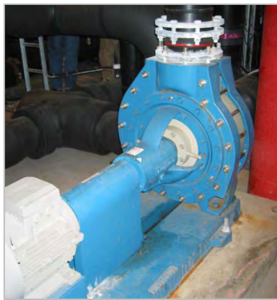
Figur 14 Sjøvannspumpe i spesialplast ved Norsk Hydro, Vækerø
