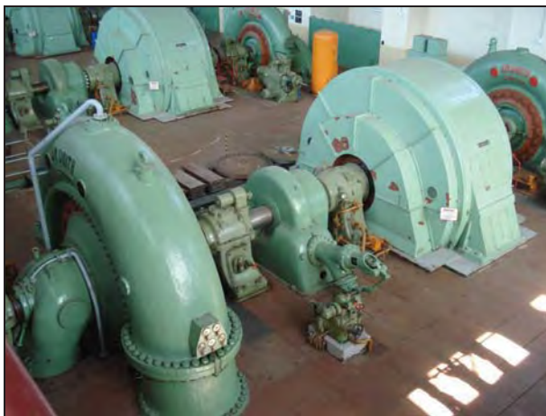
Figur 4. Ein gamal pumpeturbin med separat pumpe og turbin (PSHPP Niederwartha)
