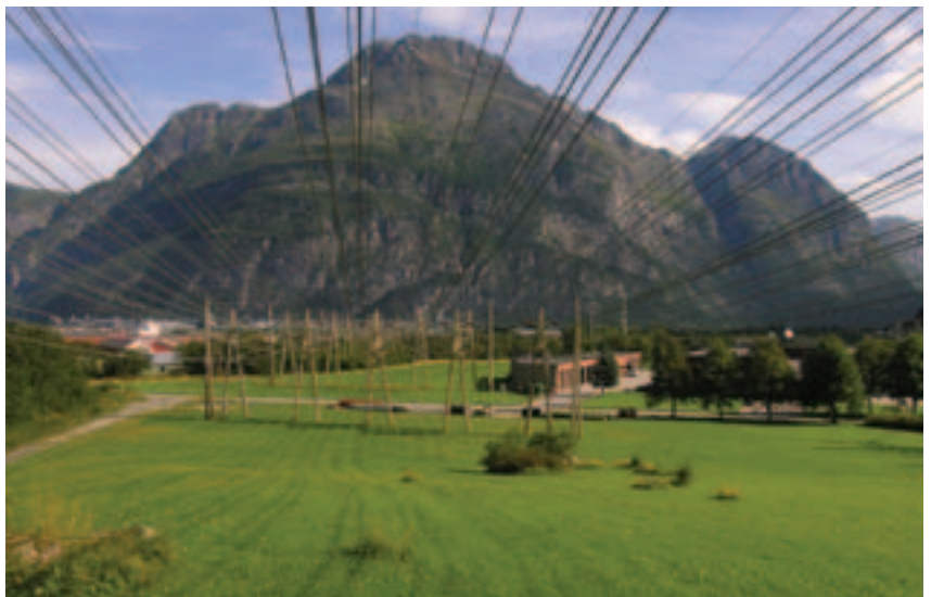
Betongmastledningen med 12 kV spenning mellom Aura kraftverk og aluminiumsverket på Sunndalsøra var karakteristisk med sine fem parallelle masterekker. Foto: Statkraft
