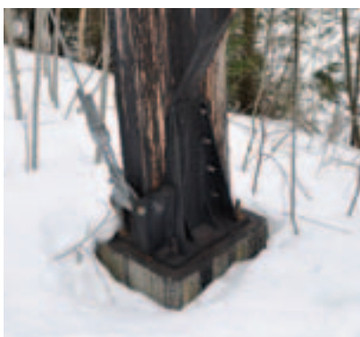
Mastebenet er festet til betongfundamentet med stålbeslag. Foto: Henning Weyergang-Nielsen, NVE
