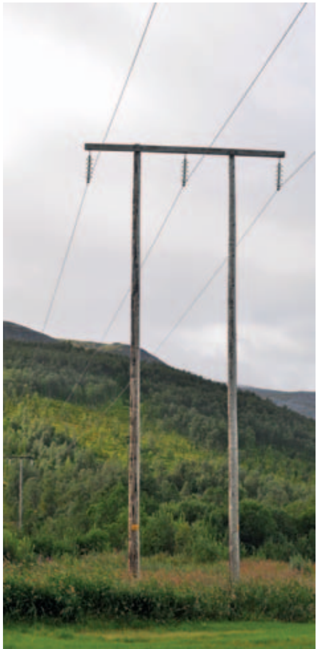
66 kV-ledning på regionalnettet fra Kvæningen kraftverk i Nord-Troms nordover til Øksfjord i Vest-Finnmark. Foto: Sissel Riibe, NVE
