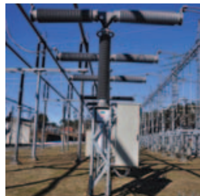
Effektbrytere i luftisolert koblingsanlegg ved Kristiansand transformatorstasjon. Foto: Henning Weyergang-Nielsen, NVE
