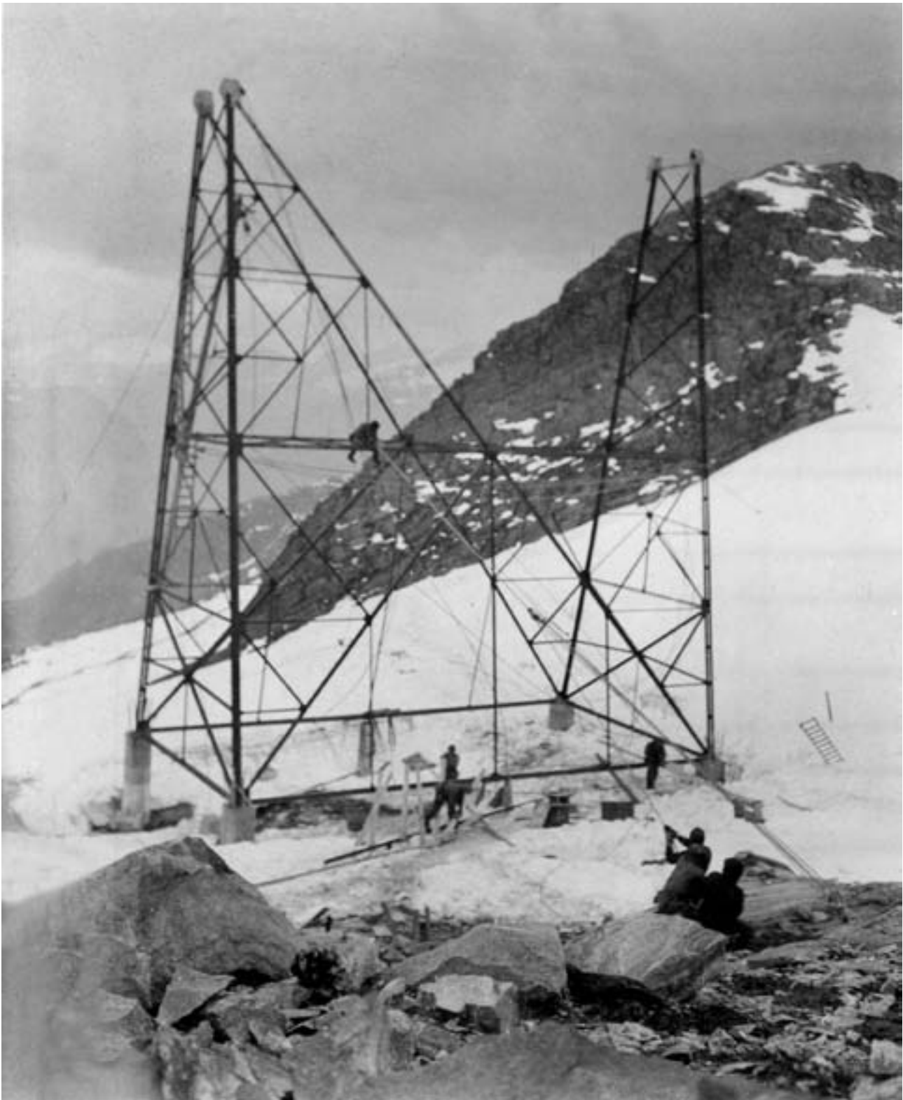
Ledningsbygging i norsk høfjellsterreng krever unik kompetanse. Bildet viser bygging av mast i Tafjordfjellene. Foto: Tafjord Kraftnett
