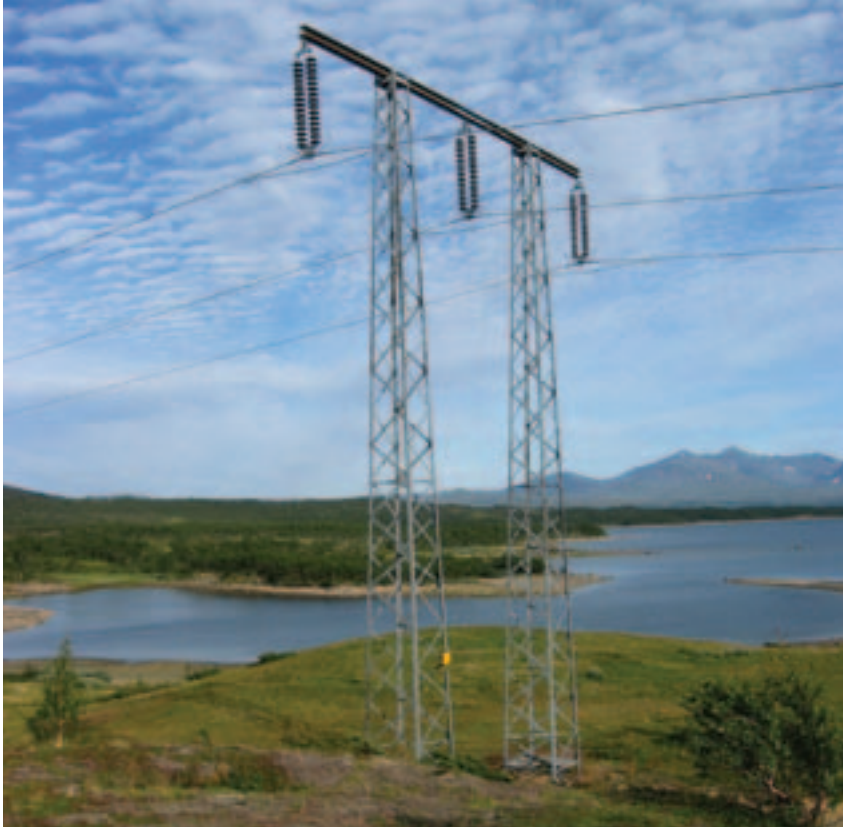
300 kV-ledningen Nea-Järpstrømmen ved Sankåvollen. Fjellmassivet i Sylane i bakgrunnen. Foto: Statnett
