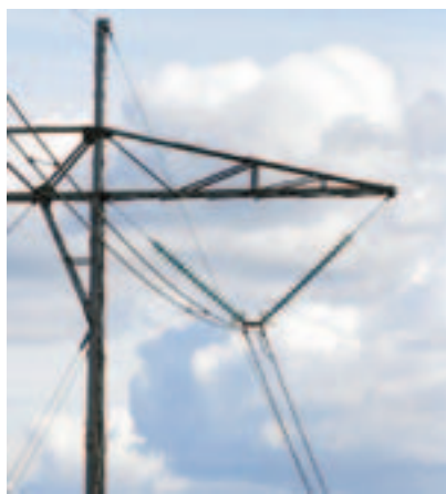
Hengeisolatorer i farget glass, med isolatoroppheng i V-kjede. Foto: Henning Weyergang-Nielsen, NVE
