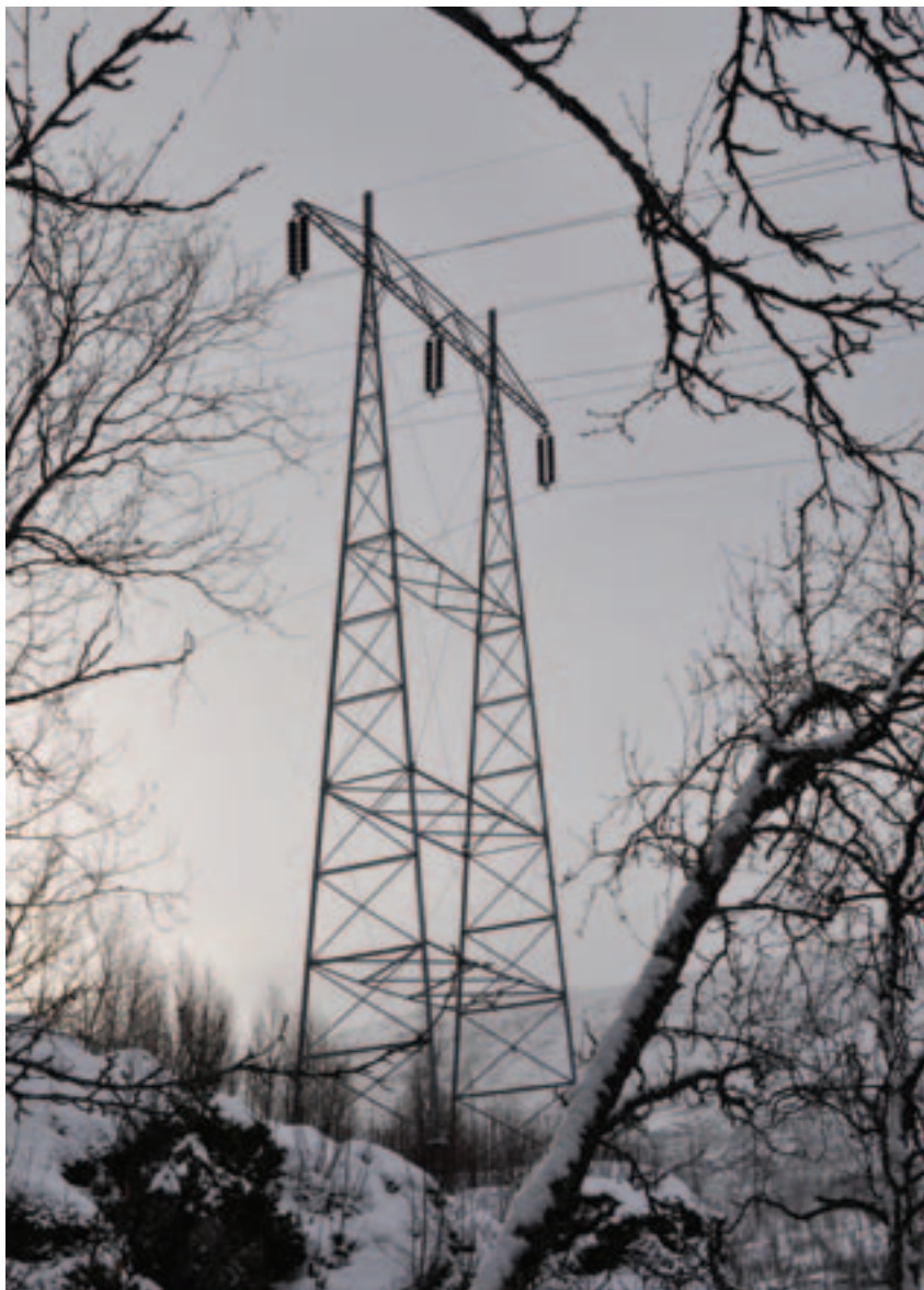
Forsynings sikkerheten i Nordland og Troms ble kraftig forbedret etter at Innset kraftverk og de første ledningene derfra ble satt i drift i 1960. På bildet ser vi mast nr 18 vest for Altevåtn på ledningen Innset-Kanstadbotn. Foto: Sissel Riibe, NVE
