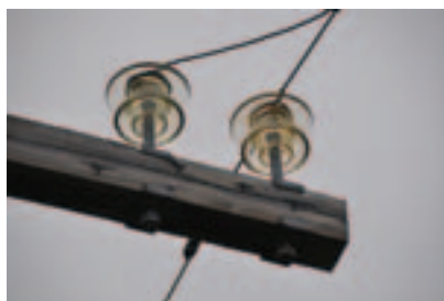
Ståisolatorer i klart glass. Foto: Sissel Riibe, NVE
