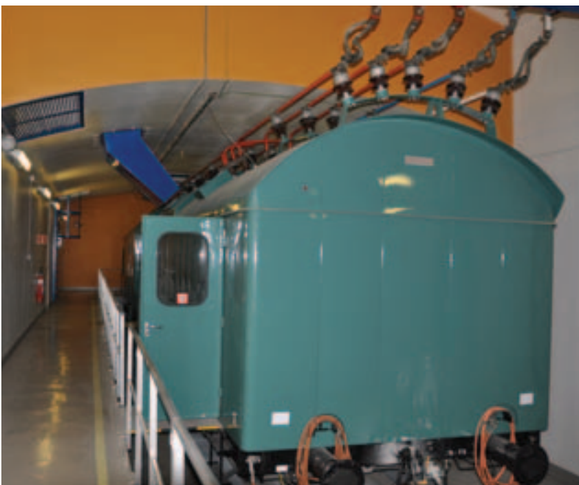
Ledningen går i dag til Asker omformer i fjellet ved Asker stasjon. Omformerne er symbolsk nok plassert inne i gamle jernbanevogner. Foto: Henning Weyergang-Nielsen, NVE
