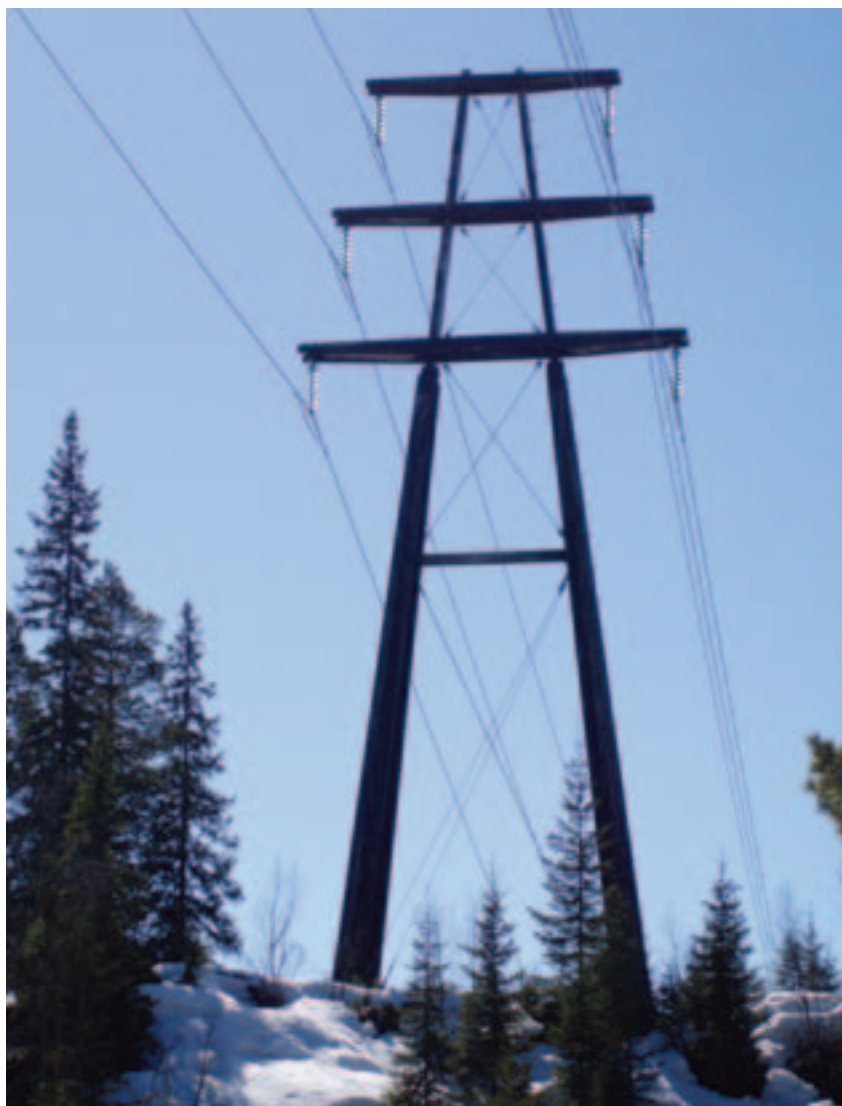
Bæremast i limtre på ledningen Grana – Orkdal. Foto: TrønderEnergi
