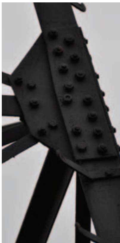
Detalj av gammel forankringsmast ved Beitstadsundet. Foto: Sissel Riibe, NVE
