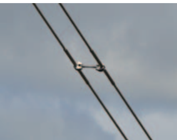
Avstandsholder på strømførende line med duplex-utførelse. Foto: Henning Weyergang-Nielsen, NVE
