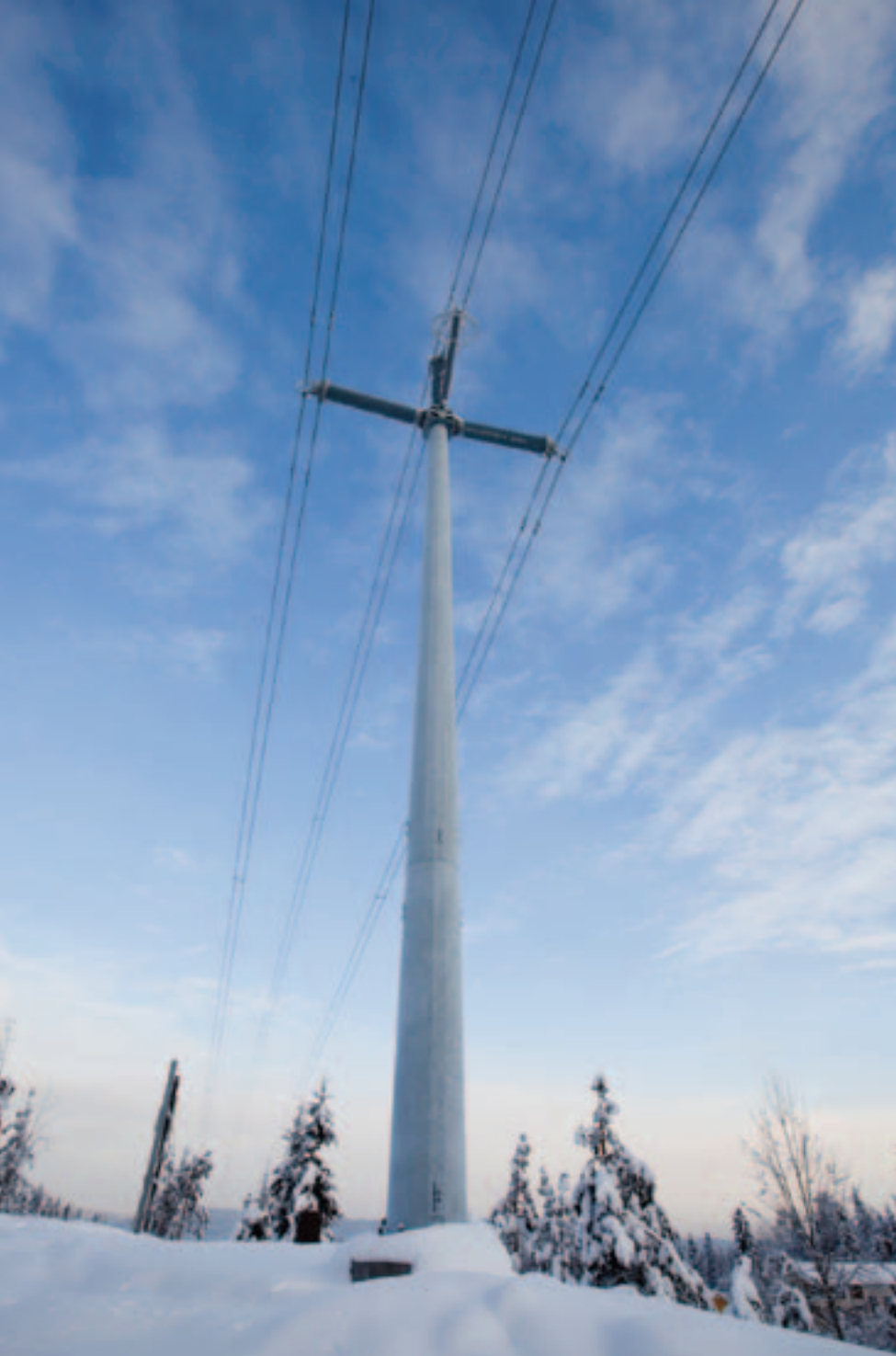
På Rasta ved Lørenskog – på ledningen fra Røykås til Tegneby – tester Statnett ut den nye typen kompaktmaster. Foto: Trond Isaksen. Fotoeier: Statnett
