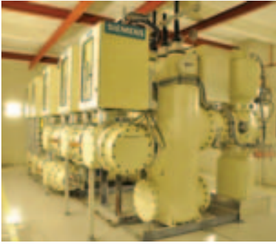
SF 6 -gassisolert koblingsanlegg. Foto: Sissel Riibe, NVE
