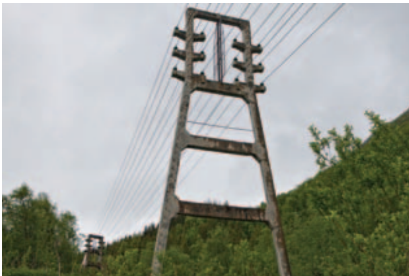
Ledningen går gjennom lett blandingskog i fjellsiden ovenfor bebyggelsen i Glomfjord. Nærmest står en bæremast, bak i bildet står en betydelig kraftigere forankringsmast. Foto: Dag Endre Opedal, Norsk Vasskraft- og Industristadmuseum
