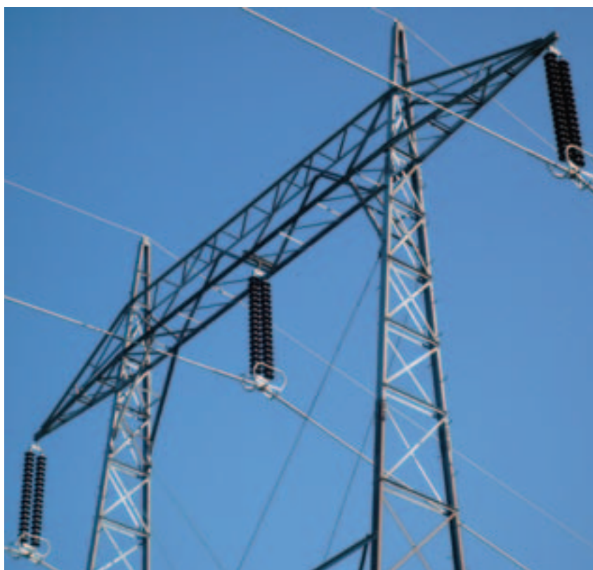
Detalj av mast med travers, hengeisolatorer, simplexlinjer og toppliner. Foto: Sissel Riibe, NVE
