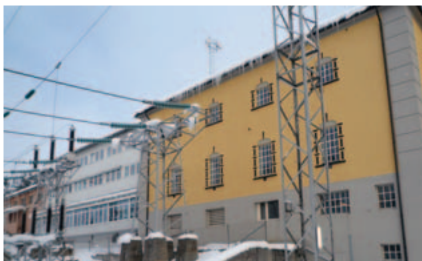
Koblingsanlegget i friluft ligger på en flate på vestsiden av kontrollbygget. Hovedbygningen fra 1928 til høyre i bildet og utvidelsene på 1950- og 60-tallet til venstre. Foto: Henning Weyergang-Nielsen, NVE
