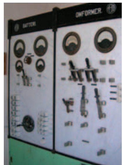
Kontrolltavle i marmor med store viser-instrumenter og åpne knivbrytere. Tavlen er delt opp i felt for batteri og omformer. Foto: Åsmund Wie, Jernbaneverket
