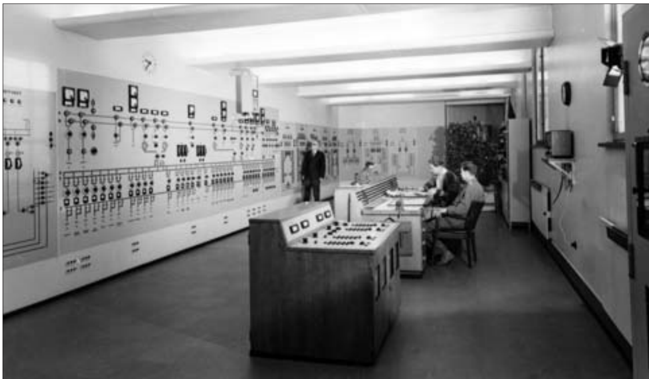
Kontrollrommet ved Tonsen koblingsentral i 1964. Foto: P.O. Breifjell / G. Herføl. Fra arkivet etter Oslo Lysverker / Oslo byarkiv
