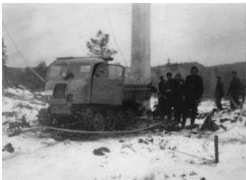
Utkjøring av dragline med Steyer beltebil, under byggingen av Vinstra–Oslo-ledningen tidlig i 1950-årene. Foto: Statnett
