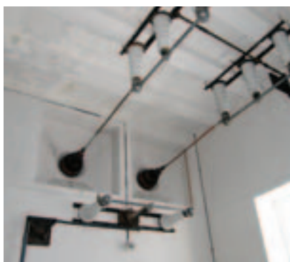
Ledningen føres inn gjennom yttervegg til inntaksrommet i andre etasje. Det gamle anlegget med porselensgjennomføringer er bevart. Foto: Åsmund Wie, Jernbaneverket
