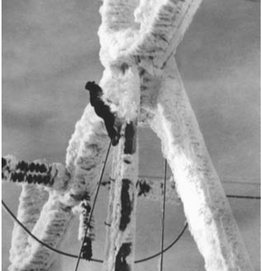
Kjell Fauske fra Vinstra Kraftselskap utfører luftig reparasjonsarbeid på mast nr 724 vinteren 1960. Foto: Statnett
