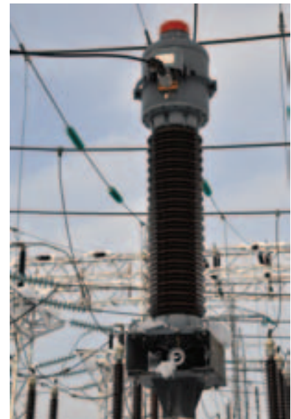
Flesaker – som ble satt i drift i forbindelse med Noreutbyggingen i 1928 – var Norges første transformatorstasjon på 132 kilovolt. Den var også et pioner-anlegg med tanke på bygging av store koblingsanlegg i friluft. Her ser vi strømtransformator med “nisselue”. Foto: Sissel Riibe, NVE
