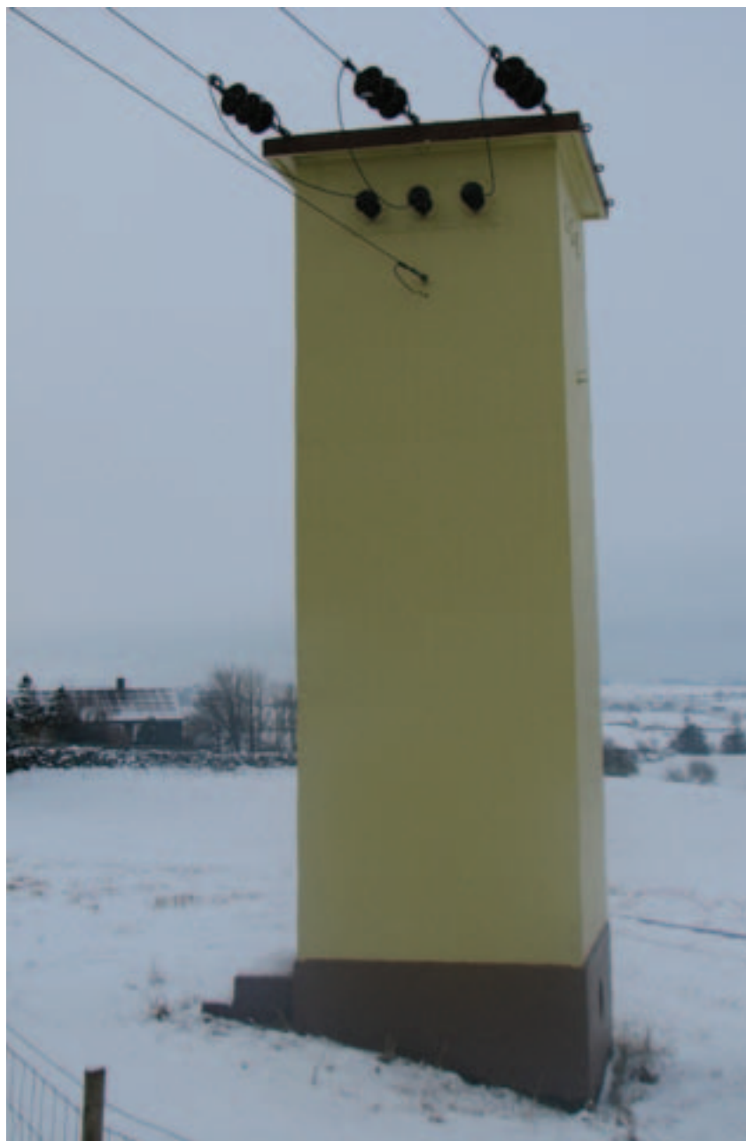
Slike transformertårn med funksispreg står det fortsatt mange av på Jæren. Foto: Åge Andersen
