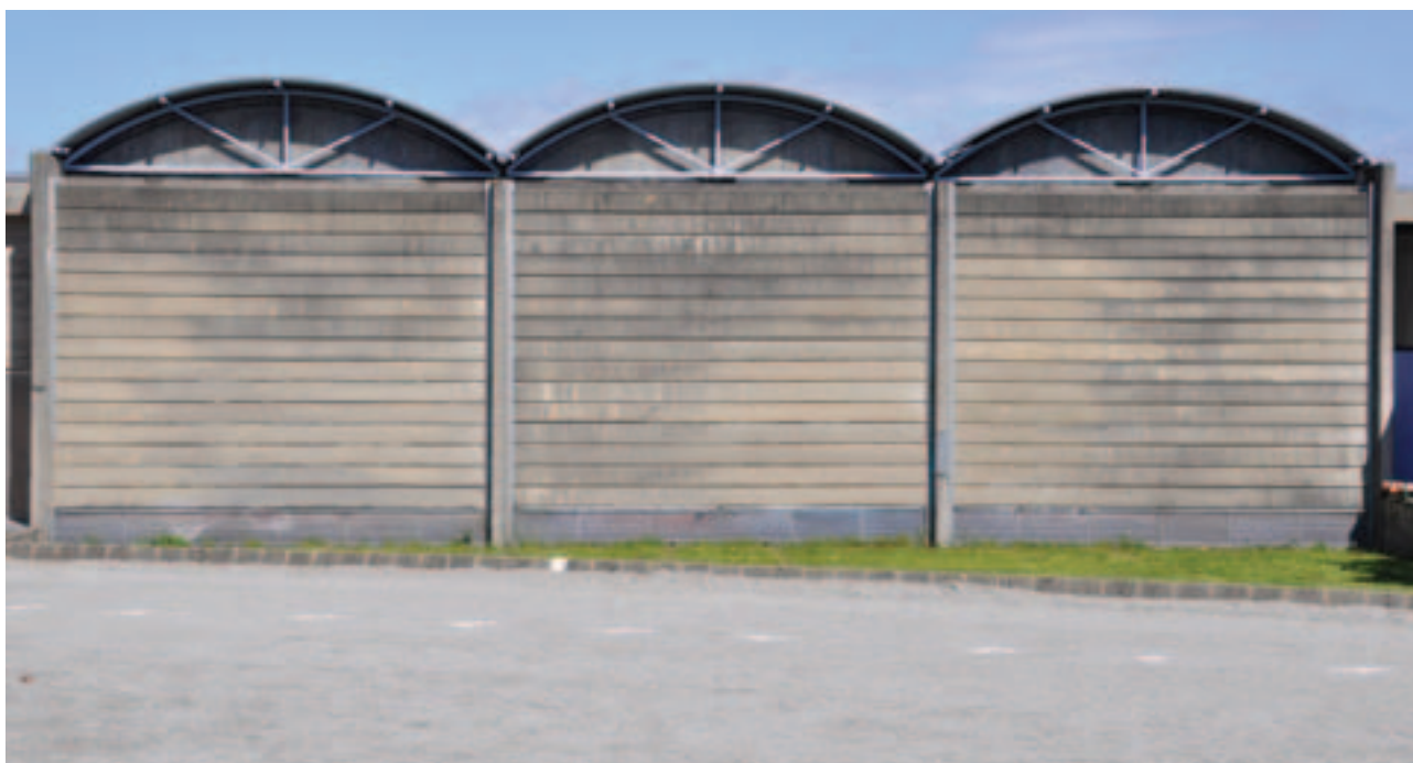
Transformatorcellene har lette buete ståltak. Foto: Sissel Riibe, NVE
