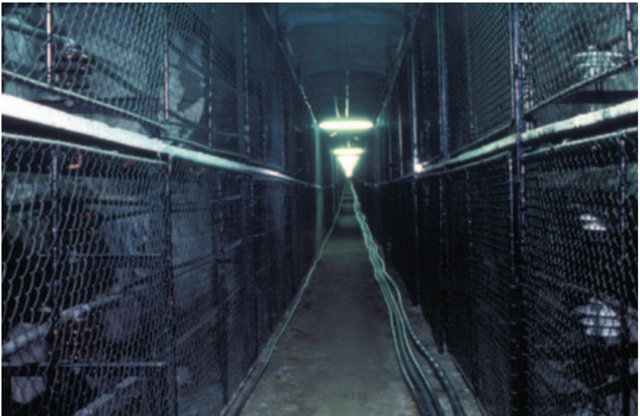
Elektrisk lys i enden av tunnelen. Ledningstunnel i Glomfjord, Nordland. Foto: Statkraft
