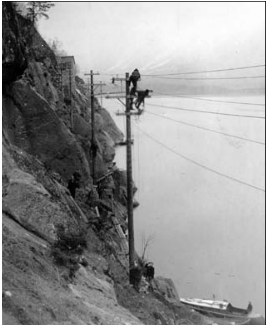
Bratt og kupert vestnorsk topografi har gjort landsdelen ideell for vannkraftutbygging, men dette har samtidig gjort det krevende å bygge kraftoverføringsanlegg. Reparasjonsarbeid kan være utfordrende, som her i Tyssedal tidlig på 1900-tallet. Foto: Statkraft
