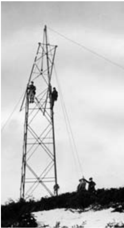
Idriftsettelsen av Nore kraftverk i 1928, og ledningene som derfra ble bygget til Oslo og Tønsberg, var en avgjørende årsak til etableringen av Foreningen Samkjøringen på Østlandet. Bildet viser bygging av mast i 1926, på ledningen fra Nore til Smestad i Oslo. Masteseksjonen heises opp ved hjelp av hånddrevne vinsjer og et spir øverst i masten. Foto: Statkraft
