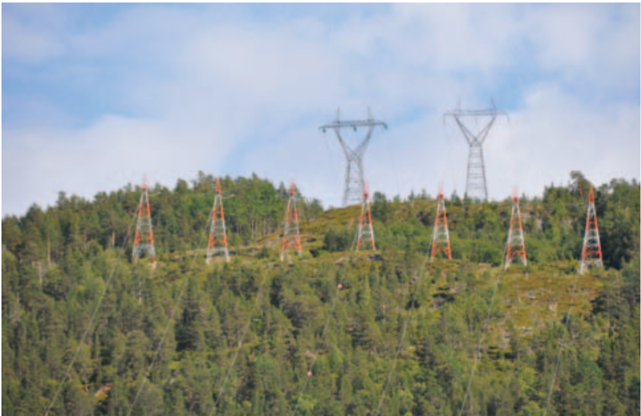
Ved spennet over Sogndalsfjorden går ledningen Refsdal–Fardal parallelt med ledningen Aurland–Fardal – satt i drift i 1974. Refsdal–Fardal er ledningen til høyre i bildet. Bak fjordspennmastene ser vi de karakteristiske "gaffelmastene", konstruert av rådgivende ingeniør Tron Horn. Foto: Henning Weyergang-Nielsen, NVE
