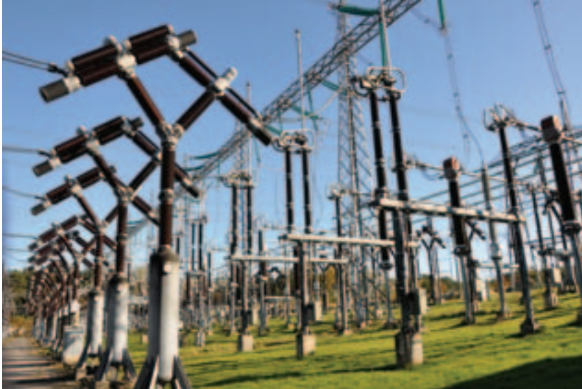
420-kilovolts koblingsanlegget på Hasle var Norges første på dette spenningsnivået. I perioden 2008-2011 erstattes dette av et nytt og større anlegg.
