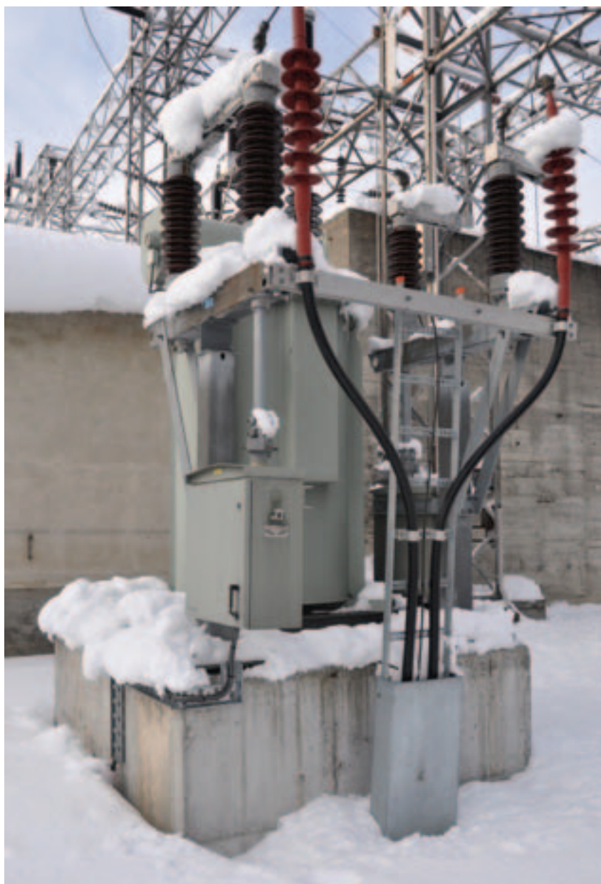
Jordfeilbryter for 66 kV. Foto: Sissel Riibe, NVE
