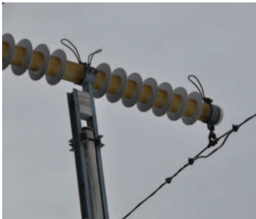
Detalj av travers og lineoppheng. Foto: Henning Weyergang-Nielsen, NVE
