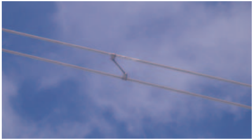
Sima-Dagali har hovedsakelig duplex-utførelse. På bildet ser vi detalj av avstands-holder mellom de strømførende linene. Foto: Statnett
