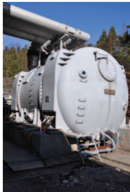
Roterende fasekompensator. Foto: Henning Weyergang-Nielsen, NVE
