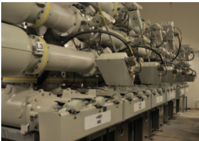
Apparatanlegg isolert med SF 6 -gass. Foto: Sissel Riibe, NVE
