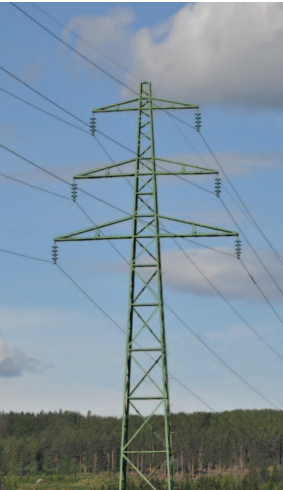
Mastene på Rjukanledningen har på folkemunne blitt kalt "grantremaster", på grunn av grønnmalingen og løsningen med den lengste traversen nederst og den korteste traversen øverst. Siste stående parti av den opprinnelige Rjukanledningen fra 1922 finnes mellom Stengelsrud og Flesaker, men vil rives i perioden 2010–2011. På bildet ser vi en av de opprinnelige "grantremastene" like ved Flesaker transformatorstasjon. Foto: Henning Weyergang-Nielsen, NVE
