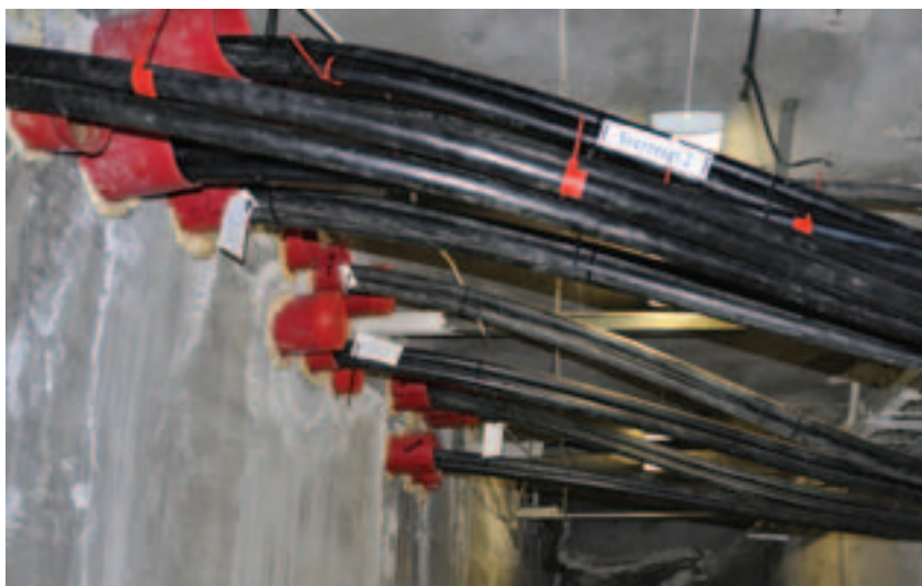
Fra transformatorstasjonen går det ut 11 kV-kabler til byens transformatorkiosker. Her krysses kabelkjelleren. Foto: Sissel Riibe, NVE
