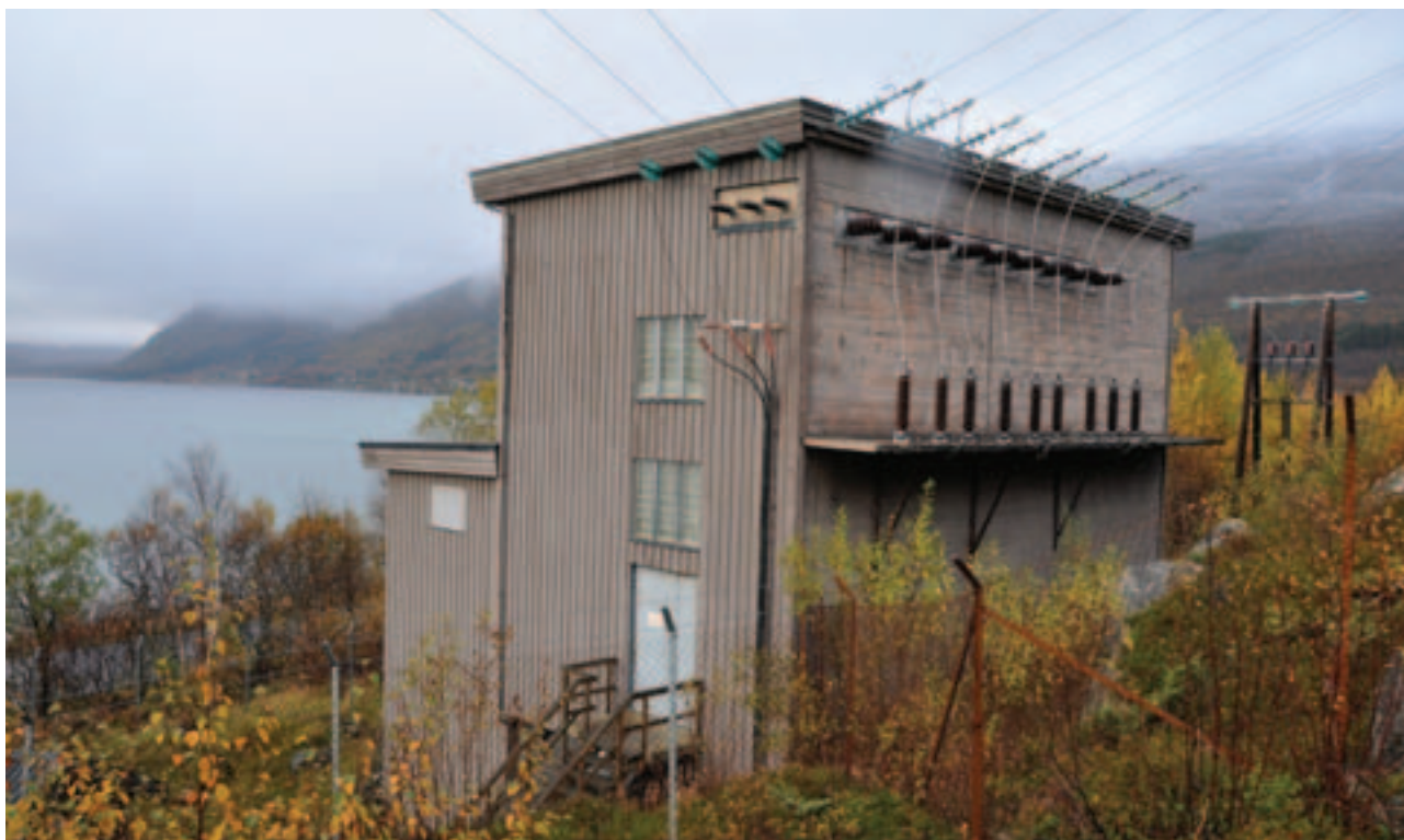
På nordsiden av Tjeldsundet står en av transformatorstasjonene som ble bygget langs 66 kV-ledningen fra Niingen kraftverk. Foto: Sissel Riibe, NVE
