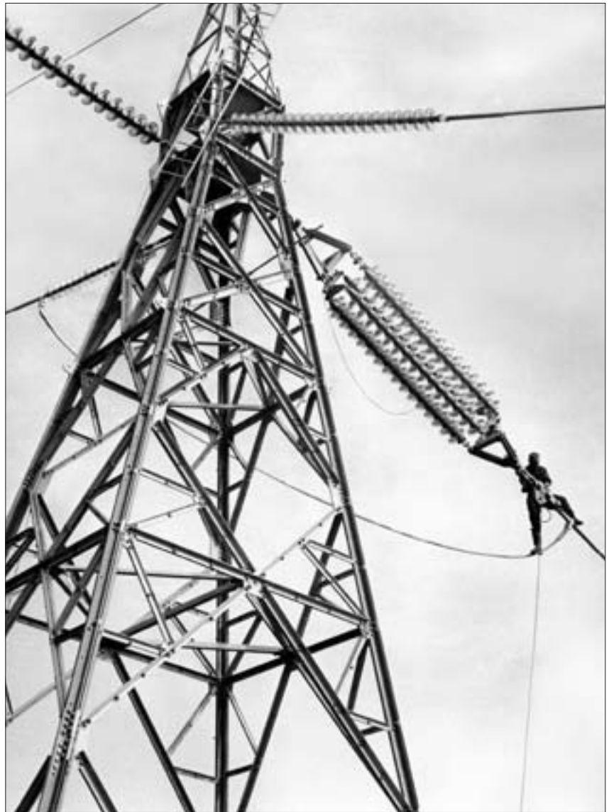
Fra strekkingen av Sognefjordspennet på ledningen Refsdal-Fardal i 1967. Bildet viser arbeidet med å feste den strømførende linjen til en av énfasemastene for fjordspennet. Foto: NVE
