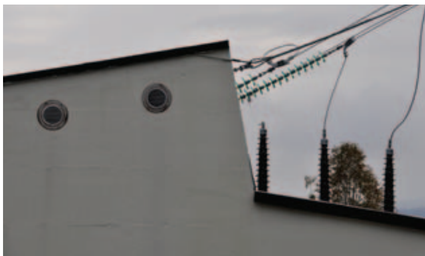
I dag går det kabler inn til og ut fra stasjonen, men reserveledningen for 132 kV har innstrekke over tak. Foto: Sissel Riibe, NVE
