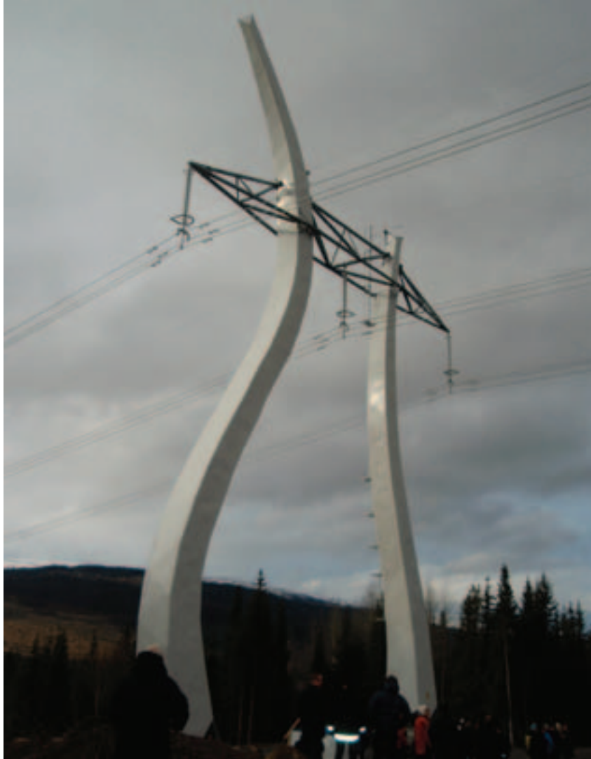
På den nye 420 kV-ledningen er det satt opp en særegen designmast på en høyde ved Åre i Sverige. Foto: Statnett
