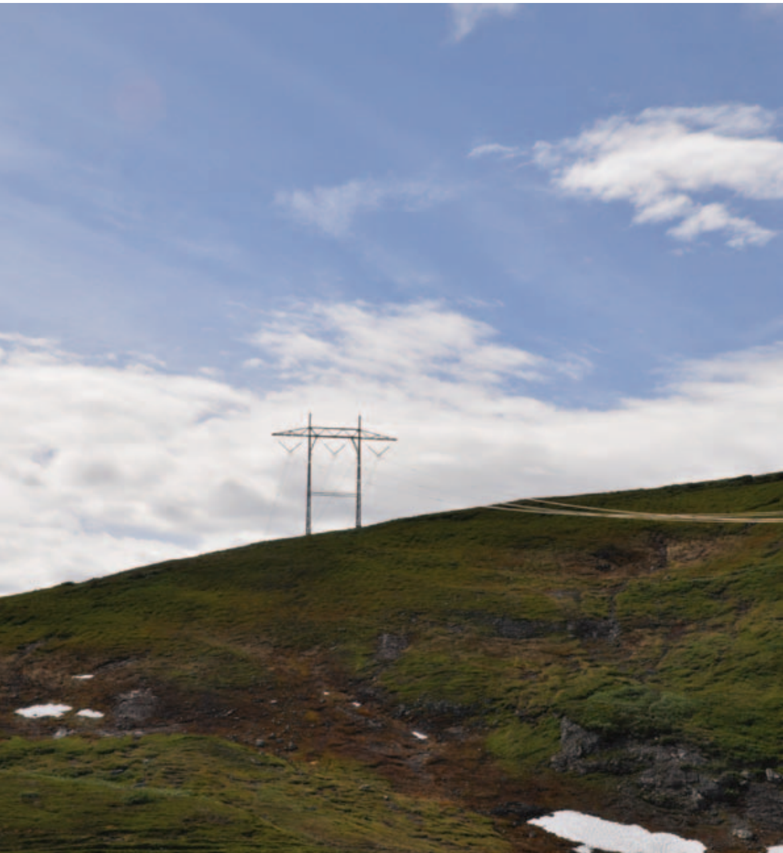
420 kV-sentralnettsledning over Vikafjell i Sogn. Foto: Henning Weyergang-Nielsen, NVE
