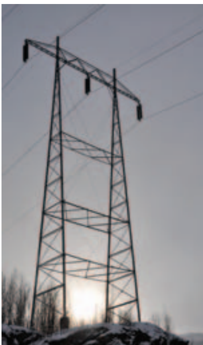
Ledningene har standard portalmaster av stål. Her ser vi mast nr. 18 vest for Innset kraftstasjon. Foto: Sissel Riibe, NVE
