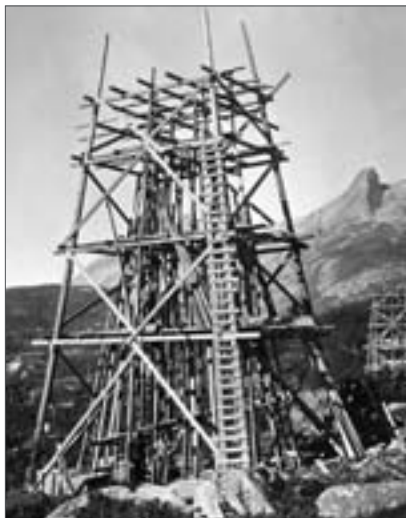
Fra byggingen av ledningen i slutten av 1910-årene. Hver enkelt betongmast ble støpt på sitt respektive mastepunkt. Foto: Statkraft
