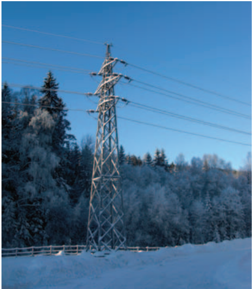
En nyere forankringsmast er satt opp like ved Hammeren kraftverk. Foto: Arne Vegard Langmo, Hafslund Nett
