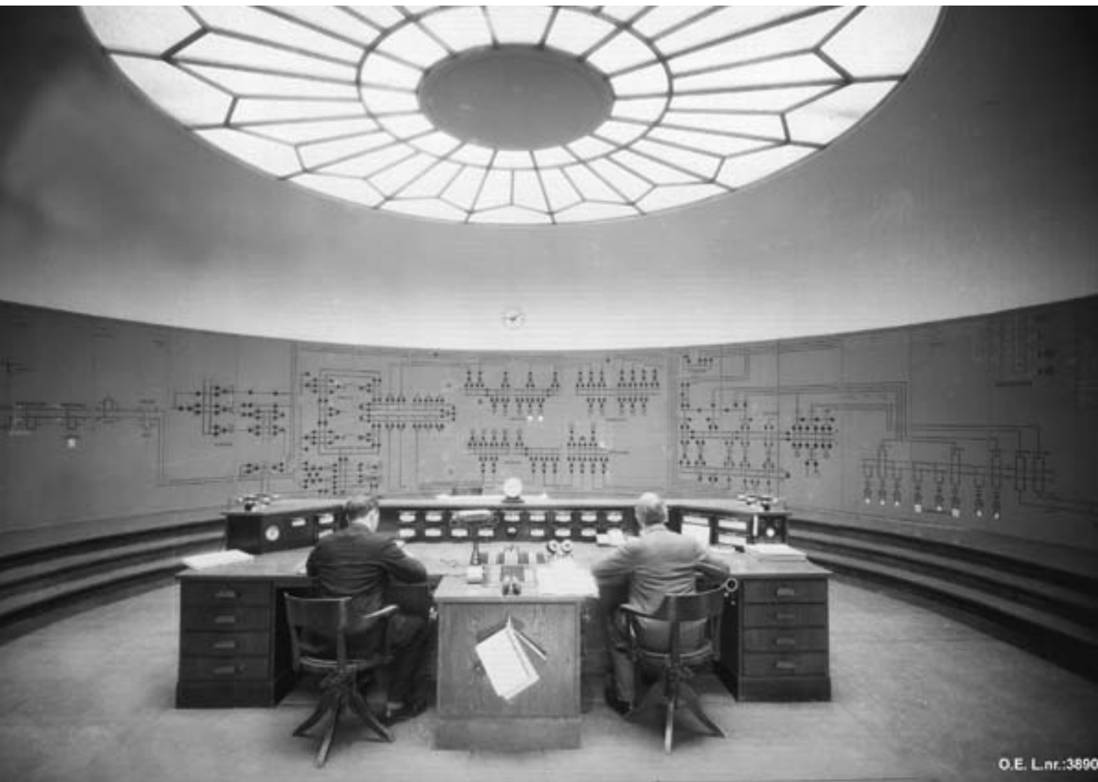
Samkjøringens driftssentral ved Smestad transformatorstasjon. Herfra ble både Oslos og – fra 1932 – hele samkjøringens drift koordinert. Det var herfra mulig å fordele nettets belastning, regulere spenning og frekvens, samt å gjennomføre inn- og utkoblinger av nettgrupper. Ukjent fotograf. Fra arkivet etter Oslo Lysverker / Oslo byarkiv
