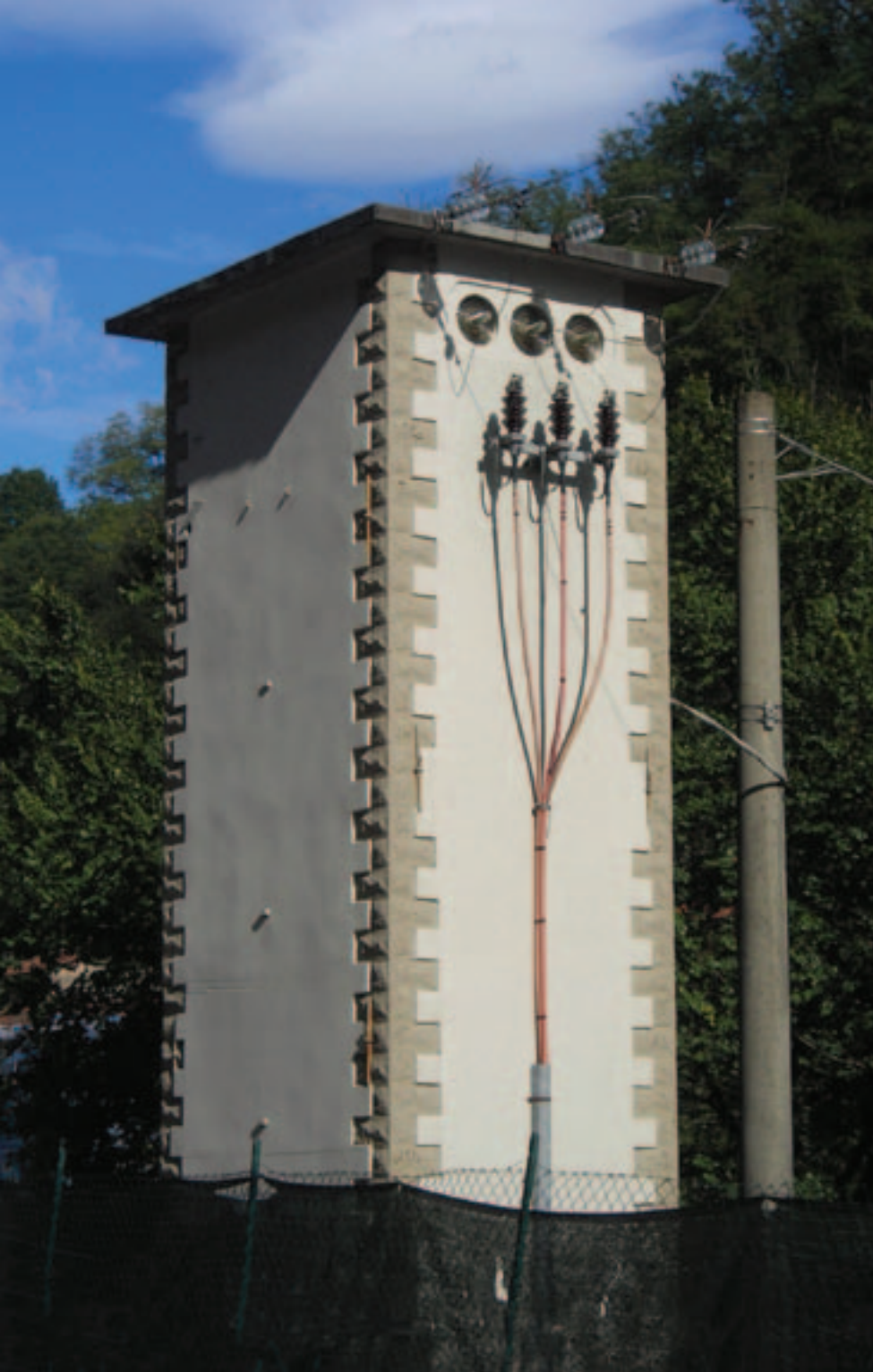
I Italia var elektrisitetsforsyningen i stor grad dominert av utenlandske eierselskaper frem til 1962, da man fikk et statlig elektrisitetsmonopol. Bildet viser en liten nettstasjon med kabelmuffer i Bagni di Lucca, Toscana.
