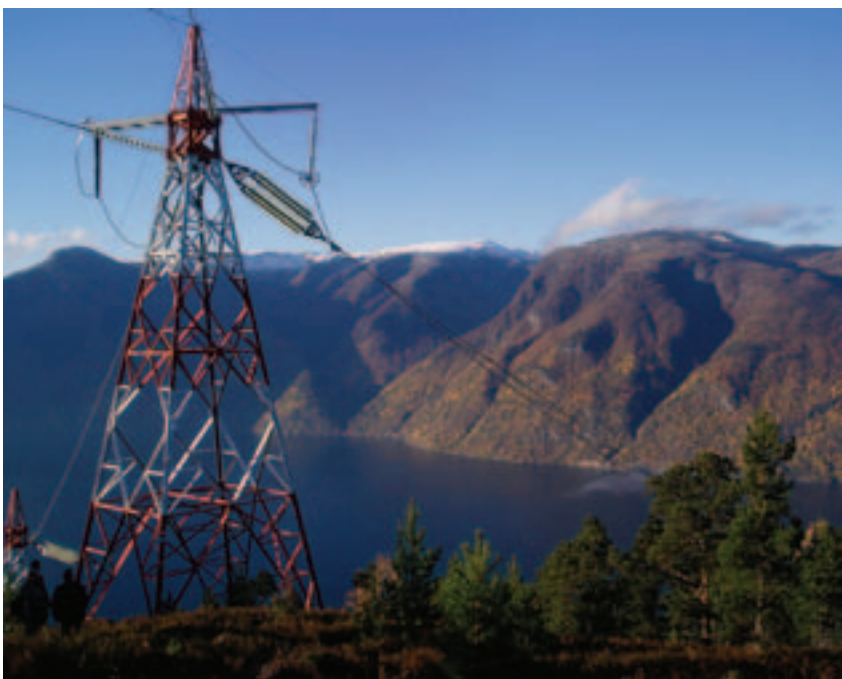
Fjordspennmast på sørsiden av Sognefjorden, fotografert sommeren 2005. Foto: Hallgrim Berg, Statnett
