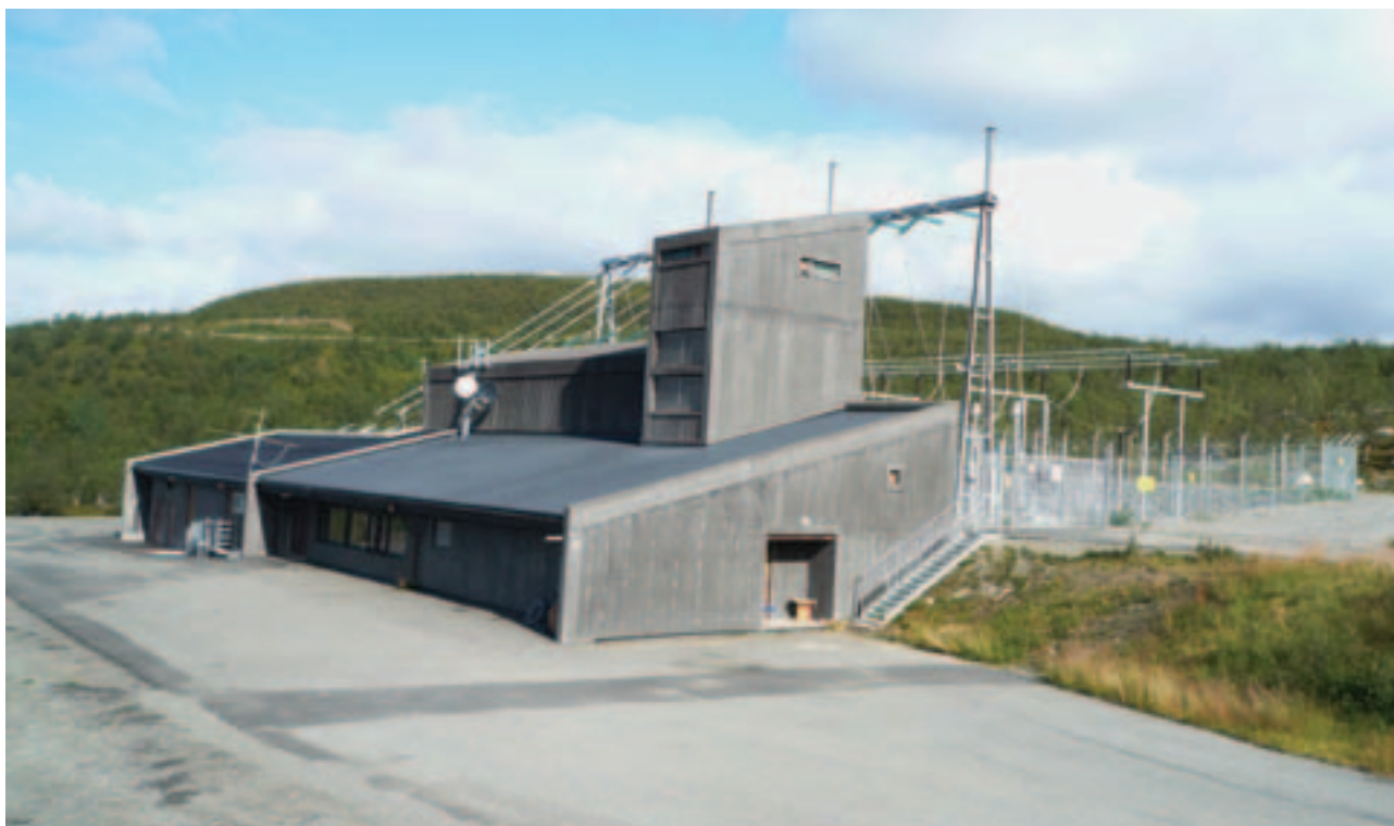
Sautso transformatorstasjon ligger pent plassert i de bjørkeskogkleddede åsene ved Sautso sør for Alta. Foto: Henning Weyergang-Nielsen, NVE
