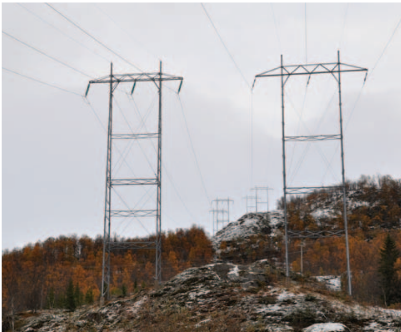
To parallelle 132 kV-ledninger vest for Kvanndal. Den ene går vestover til Kanstadbotn, og den andre dreier etter hvert nordvestover mot Kilbotn. Foto: Sissel Riibe, NVE
