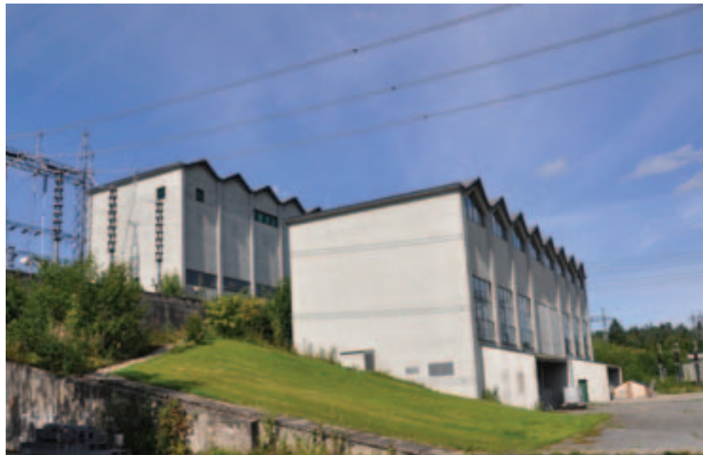
Rød transformatorstasjon nord for Skien ble satt i drift i 1961, og var Norges første stasjon som transformerte ned fra et spenningsnivå på 300 kV.
