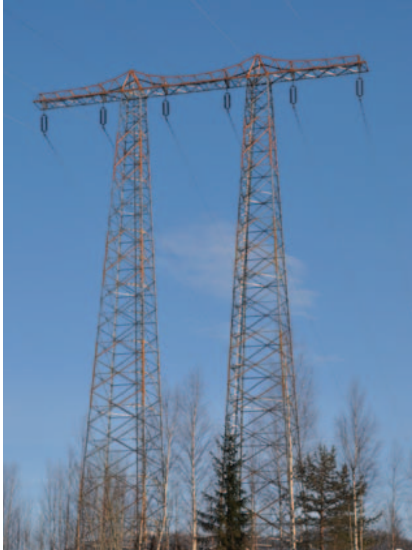
Spennmast ved Krøderspennet. Foto: Henning Weyergang-Nielsen, NVE
