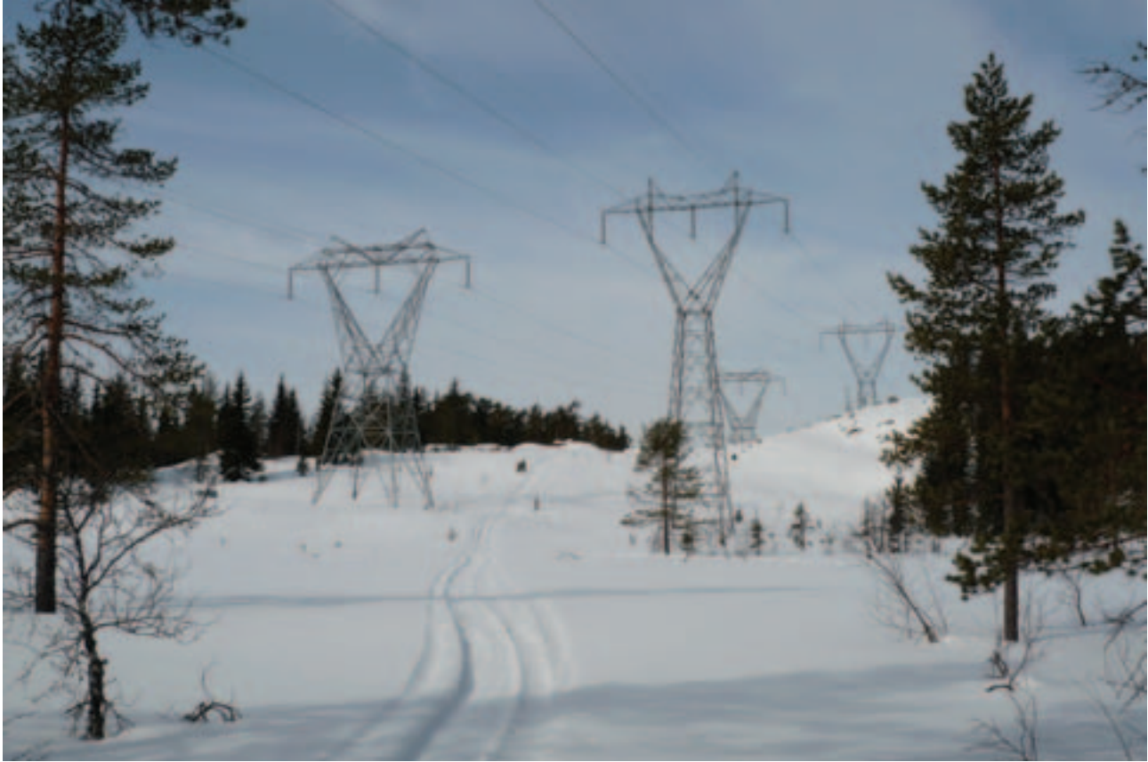
Ledningen Hol–Oslo gjennom Krokskogen nord for Langtjernet. Foto: Sissel Riibe, NVE
