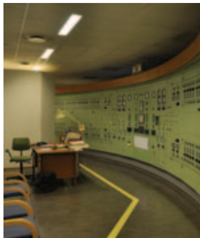
Tidligere kontrollrom ved Ullevål transformatorstasjon i Oslo. Foto: Sissel Riibe, NVE
