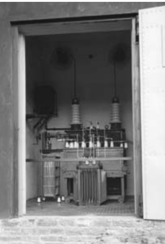
Transformator installert på Moholt transformatorstasjon da dette anlegget ble satt i drift midt på 1920-tallet. Foto: Trondheim Energi
