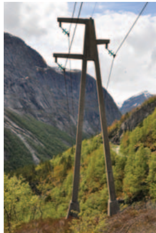
Betongmast i distribusjonsnettet ved Tysseidal i Hordaland. Her er det valgt trekantoppheng for de strømførende linene. Foto: Helena Nynäs, NVE
