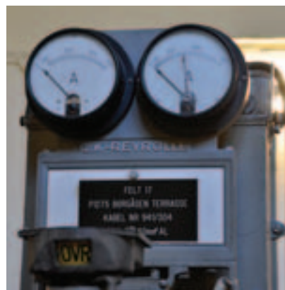
Det gamle 11 kV Reyrolle-anlegget er tatt ut av teknisk drift, men står fortsatt igjen i hovedbygningen på Hauen. Dette var en type helkapslede apparatanlegg som ble konstruert i 1920-årene og tatt i bruk i gruveindustrien i England for å beskytte komponenter og utstyr mot støvplager, og for å redusere plassbehovet. Foto: Henning Weyergang-Nielsen, NVE
