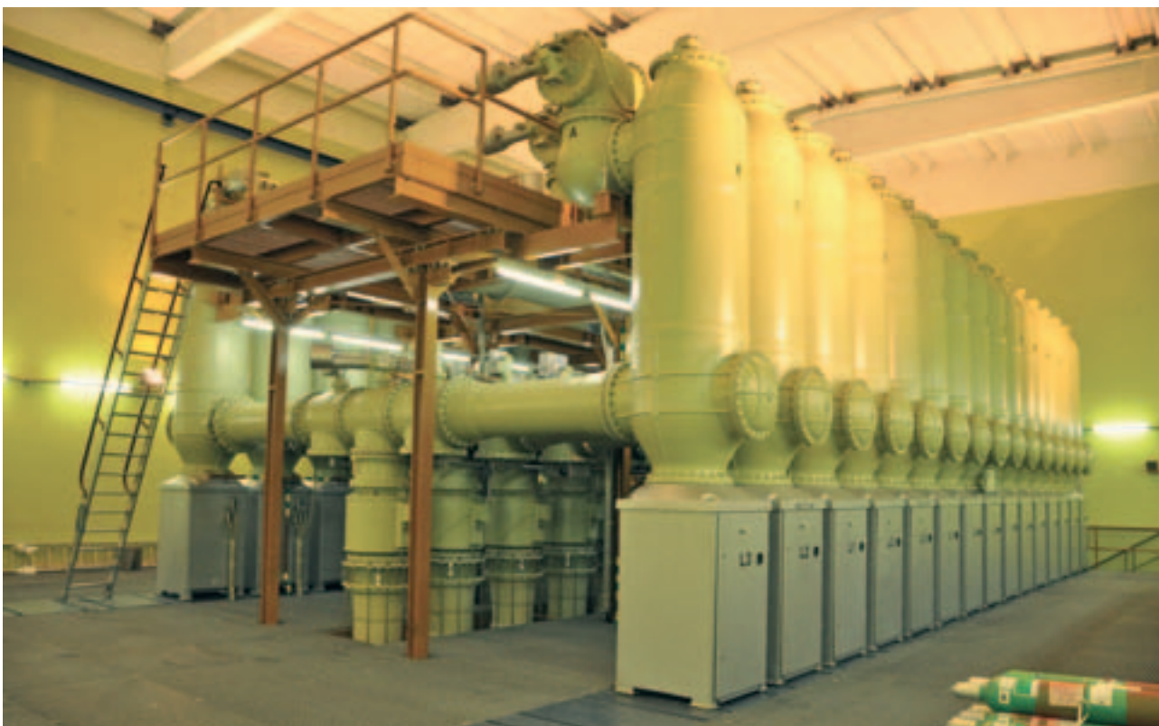
Kompakt, kapslet, innendørs koblingsanlegg, isolert med SF 6 -gass. Foto: Sissel Riibe, NVE
