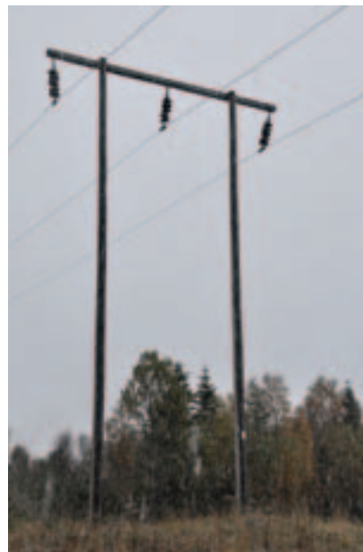
Portalmast av rundtømmer med tretravers og gamle porselensisolatorer ved Evenesmark transformatorstasjon. Foto: Sissel Riibe, NVE
