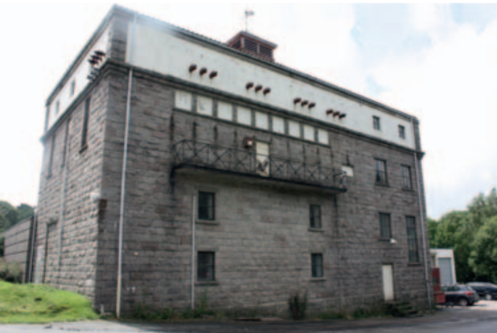
Hodnedal transformatorstasjon ved Mandal ble tegnet av arkitekt Chr. W. Heiberg i 1922. Foto: Ivar E. Stav
