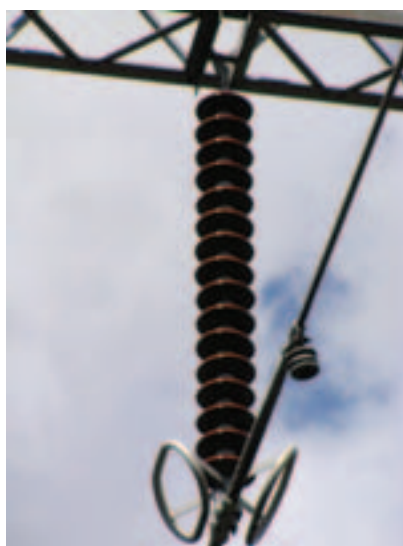
Hengeisolatorer i porselen. Foto: Idar Maurseth, Statnett
