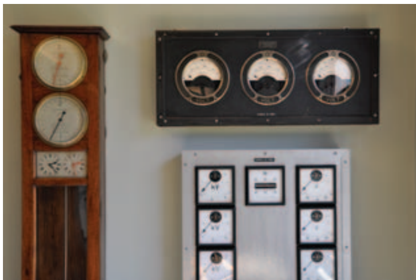
Gamle måleinstrumenter er tatt vare på i kontrollrommet. Foto: Sissel Riibe, NVE
