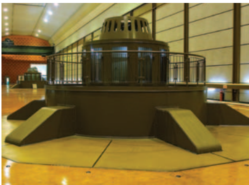
Generatorhallen i Sima kraftverk, et av de aller største i Norge. Foto: Statkraft
