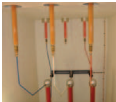
Detalj av koblingsanlegg med nye effektbrytere. Foto. Sissel Riibe, NVE
