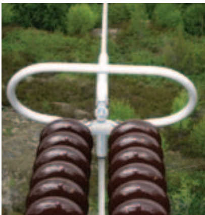
Detalj av lineoppheng i mast på Tokkeledningene. Dette bildet er fra ledningen Tokke–Flesaker. Foto: Statnett
