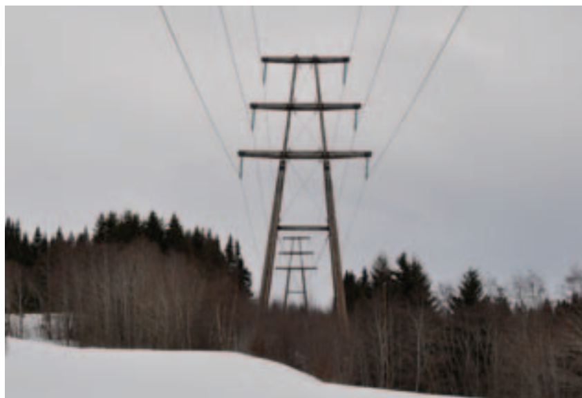
Ledningstrasé gjennom skogkledde åser nord for Orkdal transformatorstasjon Foto: Henning Weyergang-Nielsen, NVE
