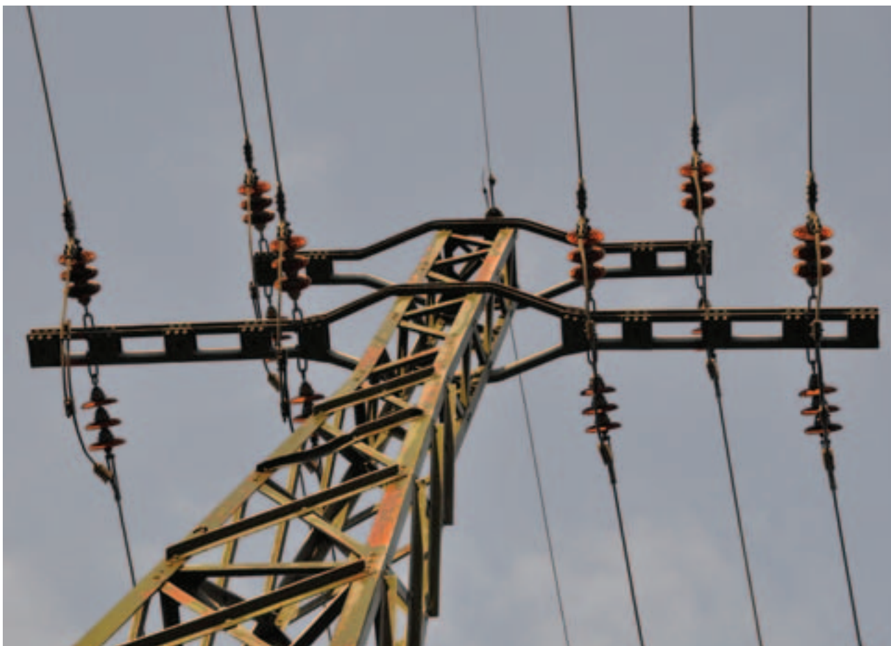
Mastetopp i Maridalen, med to traverser og liner i trekantoppheng på hver side av mastestammen. Utformingen av traversene er typisk for master bygget tidlig på 1920-tallet. Foto: Henning Weyergang-Nielsen, NVE
