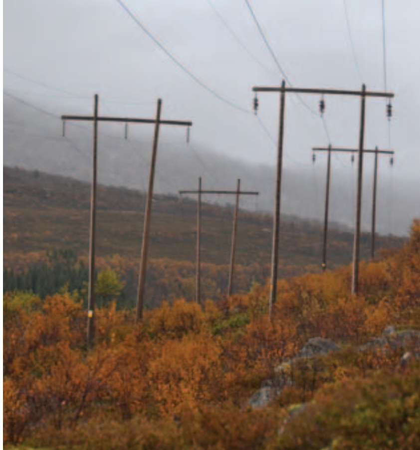
To masterekker ved Tjeldsund transformatorstasjon. Den ene går vestover mot Kanstadbotn, den andre nordover mot Harstad. Foto: Sissel Riibe, NVE
