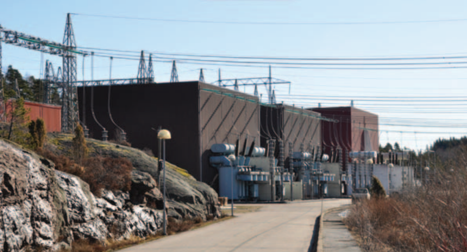
Ventilhus (fra venstre) 1, 2 og 3 ved Kristiansand transformatorstasjon, med strømretteranlegg for hver av de tre Skagerrak-forbindelsene. Foto: Henning Weyergang-Nielsen, NVE
