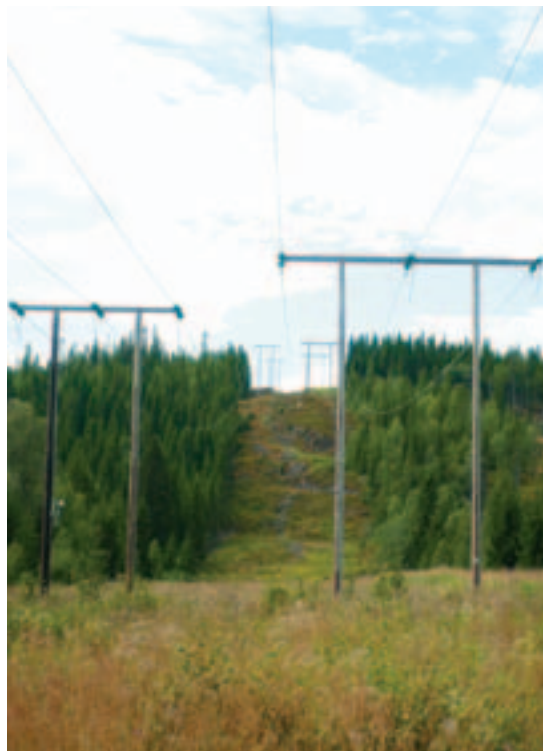
Portalmaster med stolper av rundtømmer og stål-travers på 66 kV-ledning i regionalnettet. Fra Overhalla i Nord-Trøndelag. Foto: Sissel Riibe, NVE
