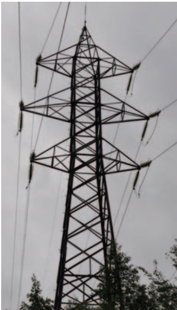
Ledningen slik den fremstår i dag på den siste strekningen inn til Nørve transformatorstasjon. Foto: Henning Weyergang-Nielsen, NVE
