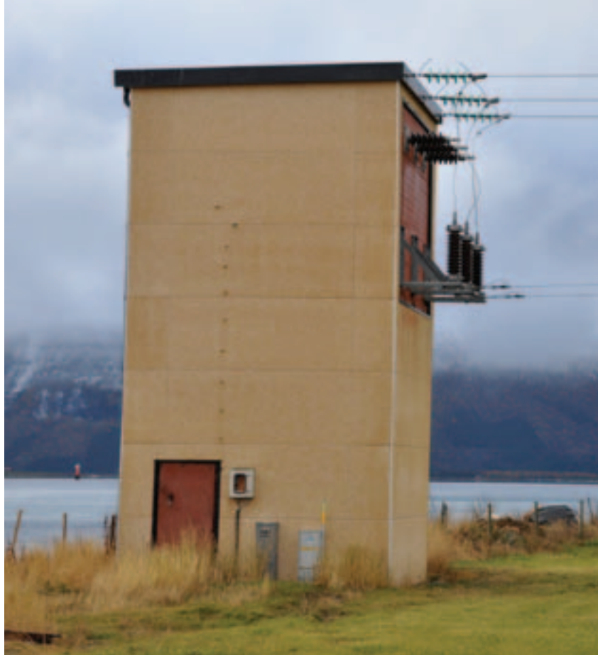
Fra et kabelhus på Fjeldal går det sjøkabel over Tjeldsundet til dette kabelhuset på Sandtorg. Foto: Sissel Riibe, NVE
