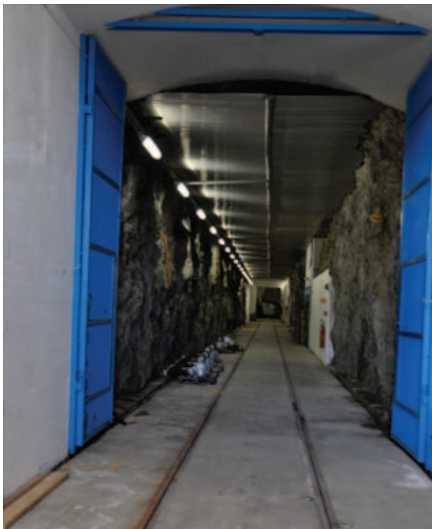
Tronsholen transformatorstasjon er sprengt ut i store fjellhaller utenfor Sandnes. Foto: Henning Weyergang-Nielsen, NVE
