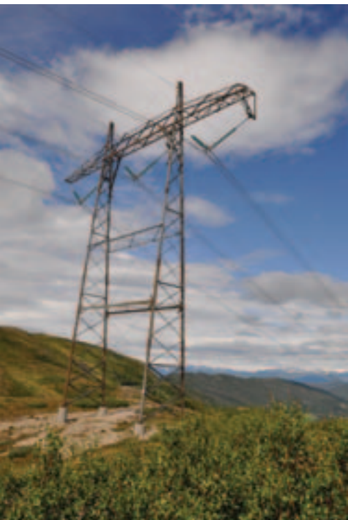
Portalmast i stål på 420 kV-ledning i sentralnettet. Fra Vikafjell i Sogn. Foto: Henning Weyer-gang-Nielsen, NVE
