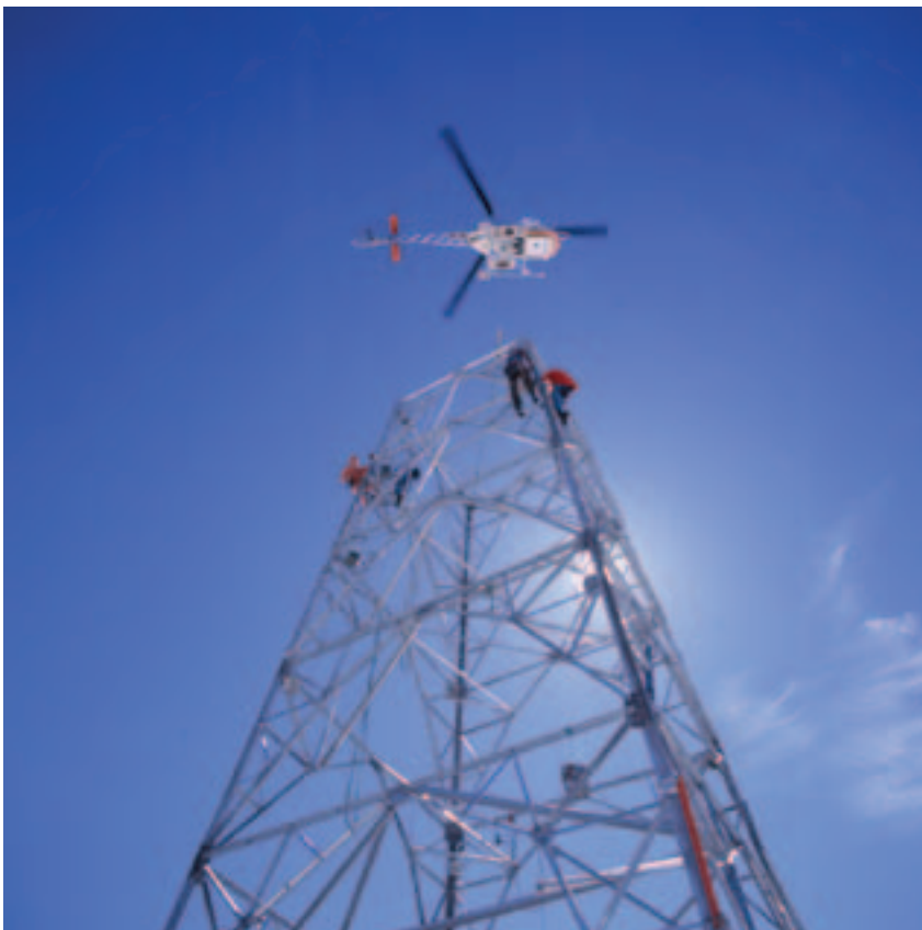
I løpet av 1970-årene ble bruk av helikopter stadig vanligere ved ledningsbygging. Dette hjelpemiddelet var av enorm betydning for ledningsbyggernes arbeidsforhold. Ukjent fotograf. Fra arkivet etter Oslo Lysverker / Oslo byarkiv
