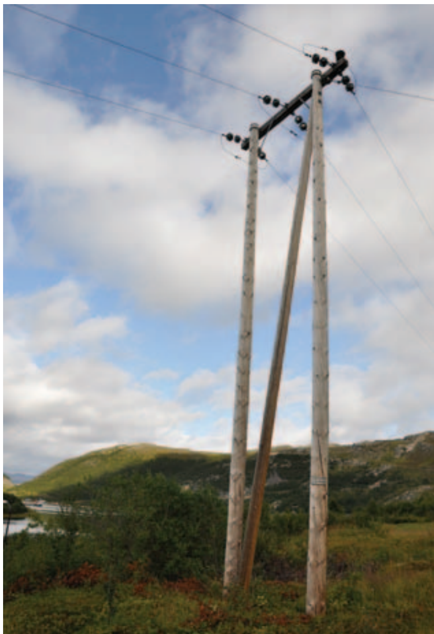
Portalmast (H-mast) av rundtømmer, bjelketravers og gamle porselensisolatorer. Foto: Sissel Riibe, NVE
