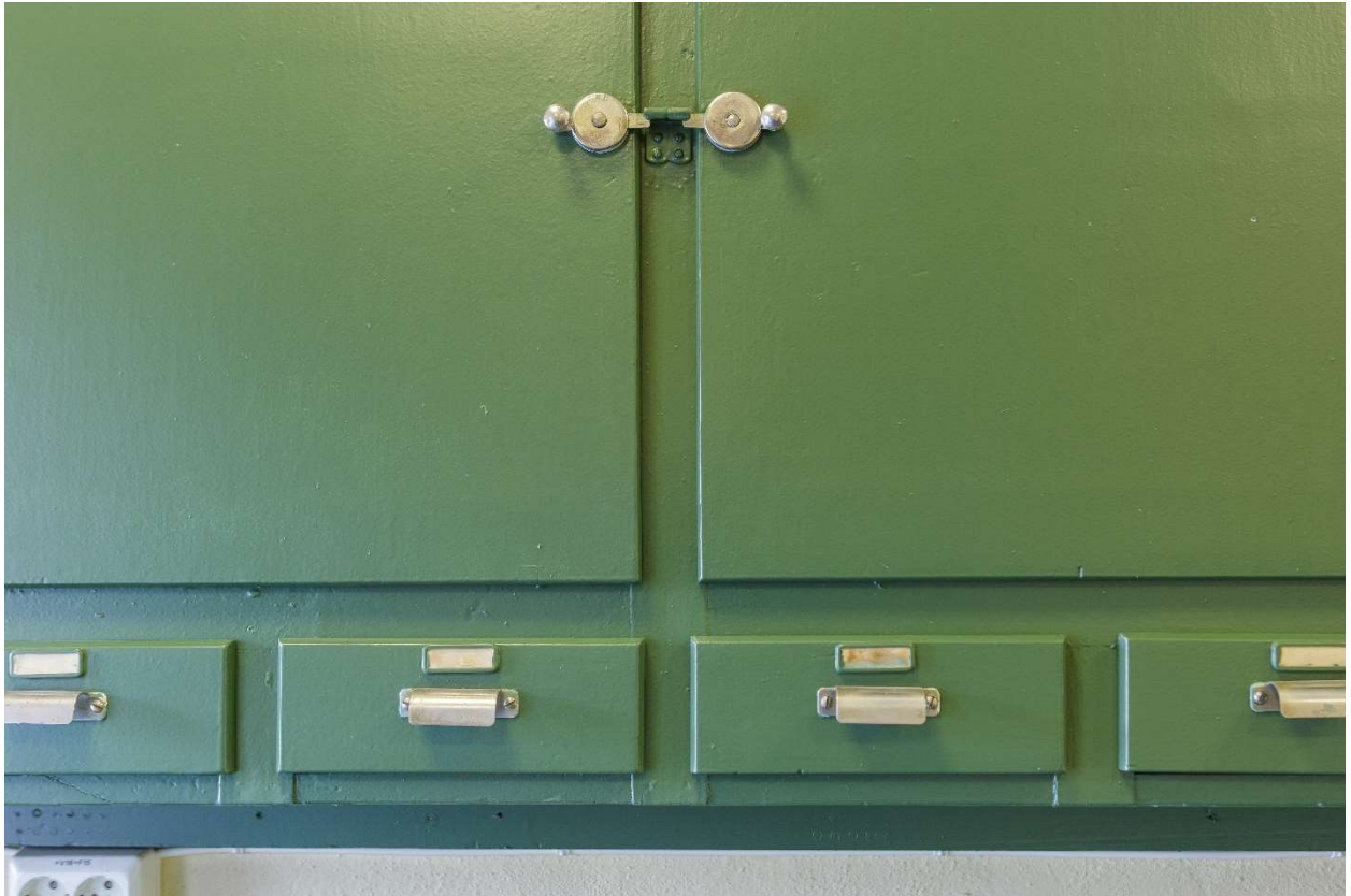
9 - Tinfos II - Rom 101 - Verksted - detalj skap N-vegg
