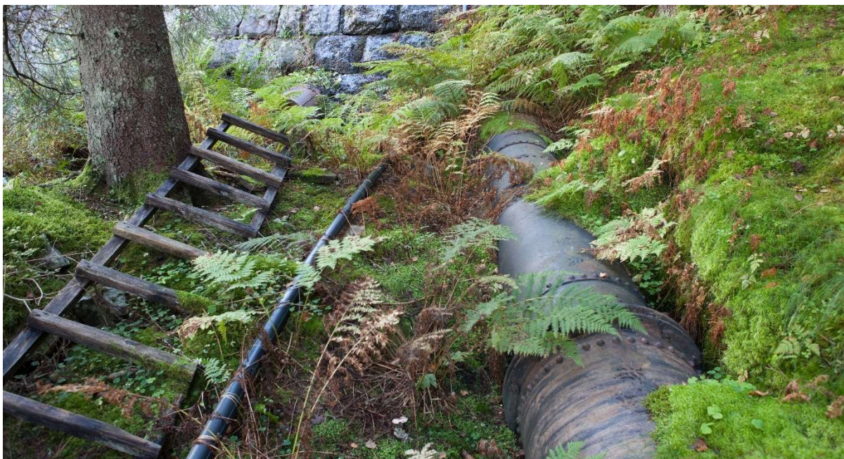
Rørgata (Stig Storheil/NVE 2016)
