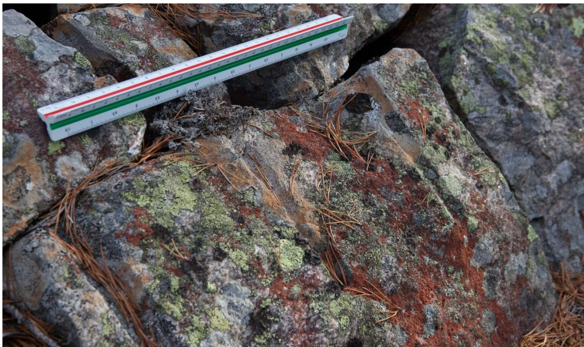
Tegn etter sprengning på steinkledning (Stig Storheil/NVE 2016)
