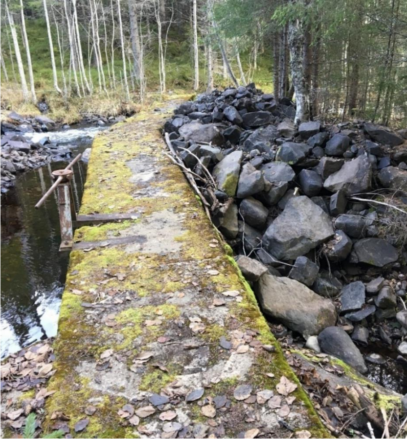
Figur 1-5. Terskelen som leder vann fra øvre del av Skurva over til Mesna. (Foto: Asplan Viak, 2019)
