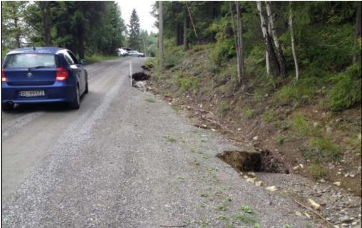
Figur 11-9. Eksempel på vei som fungerte som sekundær flomvei under flomhendelsen i 2014. Dårlig grøft langs veien førte til store erosjonsskader (Kilde: Olsen m.fl., 2015).
