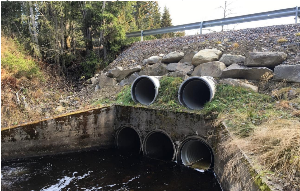
Figur 1-2. Krysning mellom Skurva og Nordsetervegen med 5 stk. DN1000-kulverter. (Foto: Asplan Viak, 2019)
