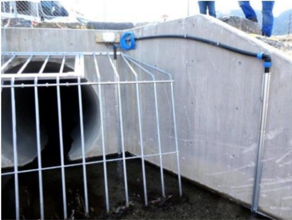
Figur 8-9. Stikkrenne nord for E6 Hundorptunnelen som har fått montert målesensor for vannstand ved fangristen (Kilde: www.at.no , 20.1.21).
